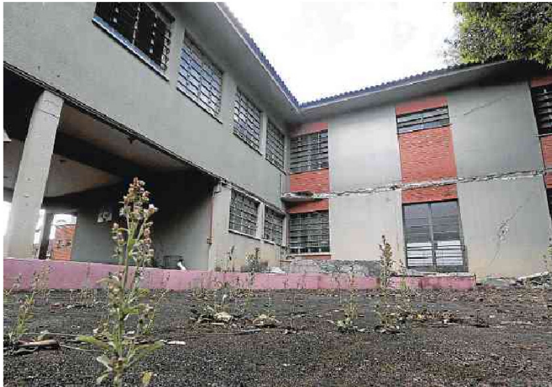
Na unidade Recanto da Alegria, interdição por risco de desabamento
