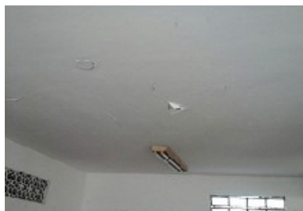
Pintura desgastada (situação sinalizada em 2015)
