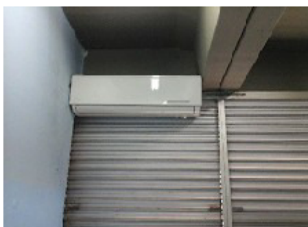
1 aparelho de ar-condicionado com defeito – salas 5, 6 e 8
