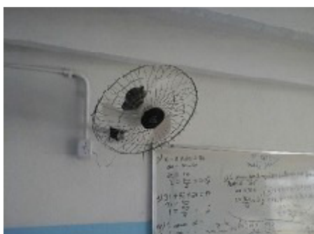
Ventilador com defeito – salas 7, 11, 13, 15 e 21
