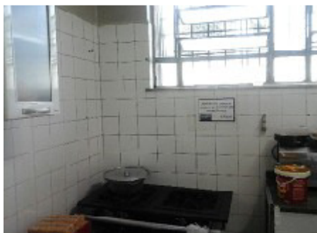
Ausência de coifa (situação sinalizada em 2012 e 2013)
