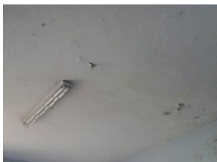
Infiltração (situação sinalizada em 2015)
