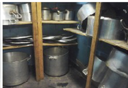
Prateleiras de madeira e danificadas - área para guarda de panelas
