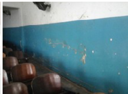
Infiltração - auditório (situação sinalizada desde 2014)
