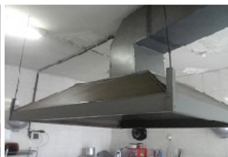
Coifa com defeito (situação sinalizada desde 2012)
