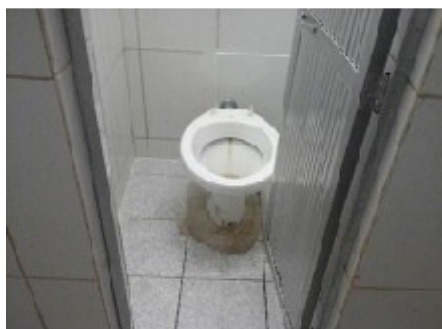
Ausência de assento sanitário (1 boxe) – banheiro masculino próximo ao refeitório
