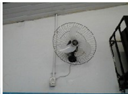
Ausência de grade de proteção nos ventiladores – sala 19
