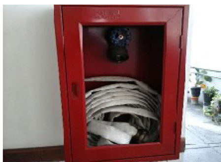
Ausência de proteção na porta do compartimento de mangueira de combate a incêndio – próximo ao laboratório de ciências
