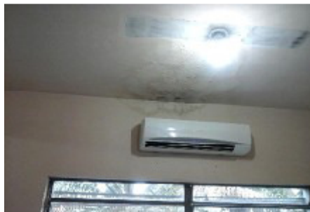
Infiltração decorrente de problemas no telhado, conforme informado pela Direção – sala 11
