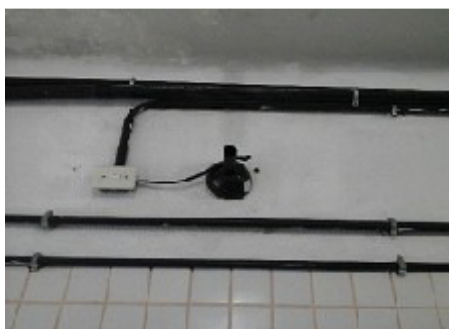
Ausência de 1 ventilador – salas 2 e 9
