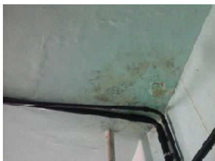
Infiltração – sala 16 (situação sinalizada desde 2013)
