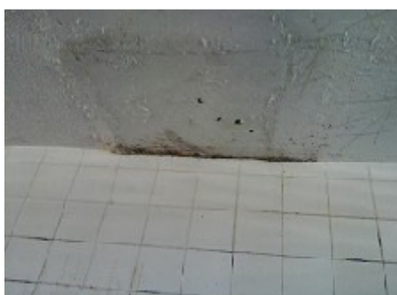
Infiltração - vestiário masculino
