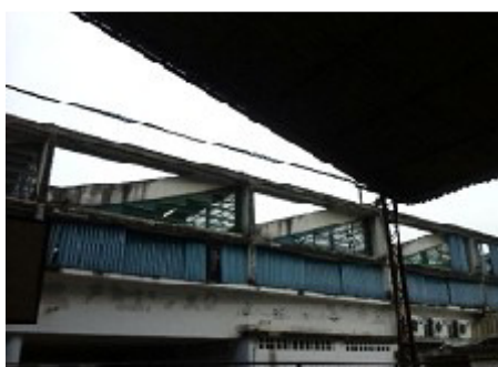
Ausência de tela de proteção (situação sinalizada desde 2014)
