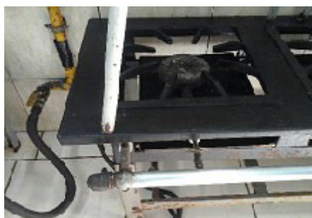
Vazamento de gás no fogão, conforme informado pelos manipuladores de alimentos.
