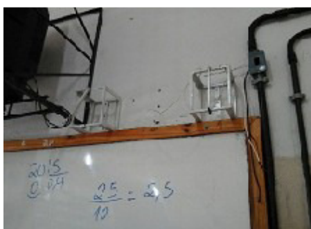
Fiação exposta – sala 14
