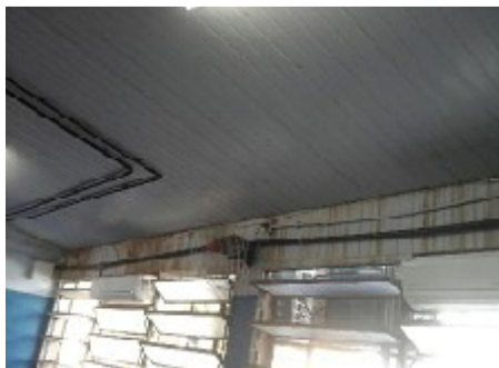
Pintura desgastada decorrente de infiltração sanada, conforme informado pela Direção – sala 2
