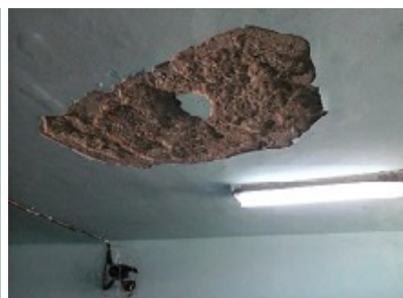
Queda de reboco – sala 4 (situação sinalizada desde 2013). Ver comentário.
