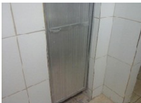
Boxe interditado - banheiro feminino próximo ao refeitório
