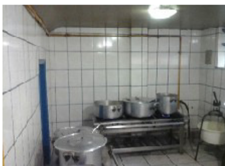
Ausência de coifa (situação sinalizada desde 2014)
