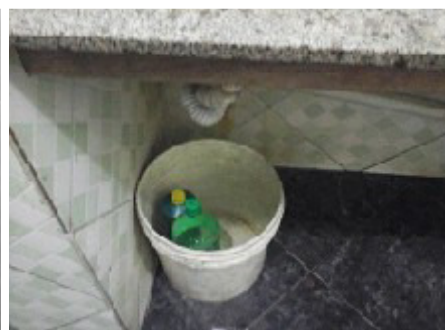
Material de limpeza sendo guardado no banheiro masculino
