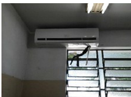
Vidro danificado no basculante – diversas salas
