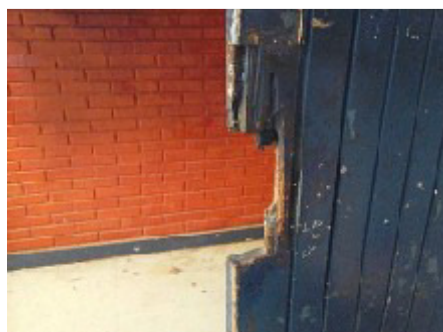
Porta danificada – sala 6 (situação sinalizada em 2015)
