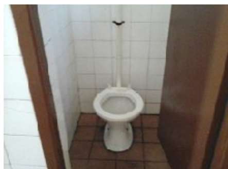
Ausência de assento sanitário (1 boxe) – vestiário masculino
