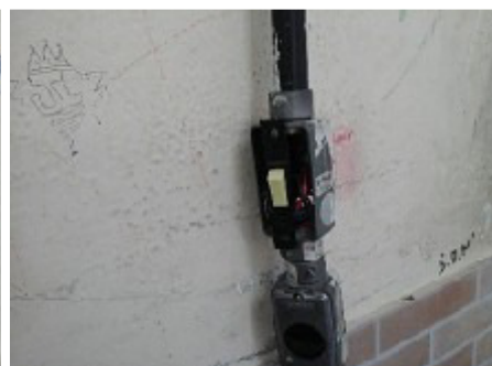
Fiação exposta – sala 19
