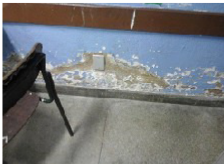
Queda de reboco - sala 3 (situação sinalizada desde 2014)
