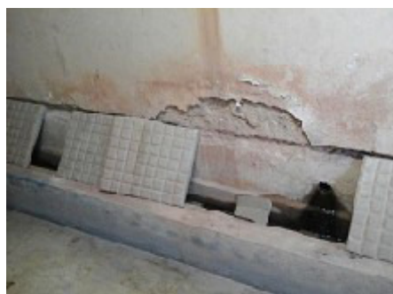
Infiltração com queda de reboco – corredor subsolo
