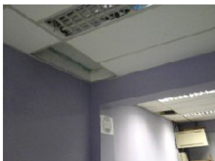
Ausência de placas do forro (situação sinalizada desde 2013)
