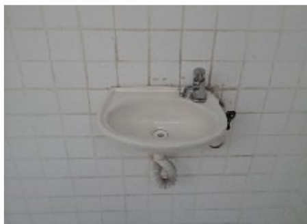
Ausência de barras de apoio junto ao lavatório – banheiro para portador de necessidades especiais
