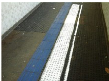
Piso danificado – acesso ao 1º andar
