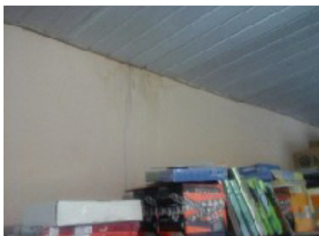
Pintura desgastada decorrente de infiltração sanada, conforme informado pela Direção – sala de leitura
