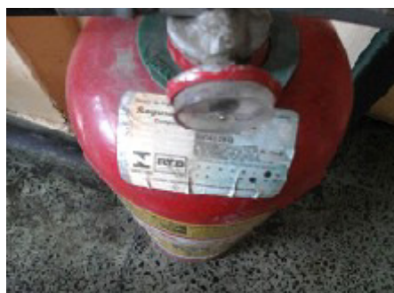
Extintores de incêndio vencidos (situação sinalizada em 2015)
