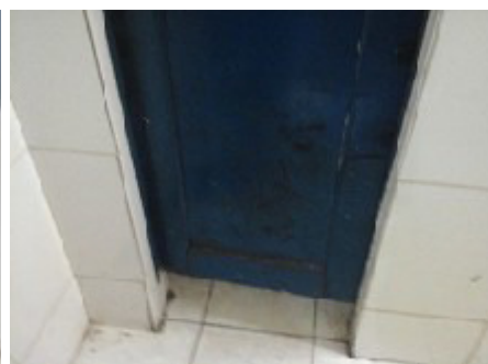
Boxe interditado – banheiro masculino 1º andar
