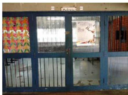
Ausência de vidros nas portas – auditório (situação sinalizada em 2015)
