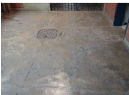
Piso danificado – corredor (situação sinalizada desde 2014)
