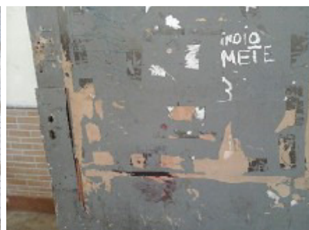
Porta danificada – salas 2, 3, 5 e 6
