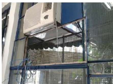
Ausência de vidro no basculante – salas 4, 5, 9, 17, 23 e 24
