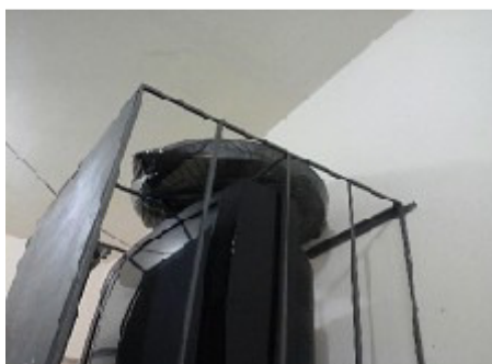
Ventilador danificado – sala 8
