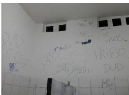
Pichações – banheiro masculino térreo
