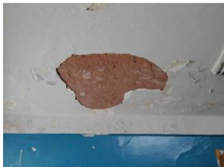
Queda de reboco – sala 15 (situação sinalizada desde 2013)
