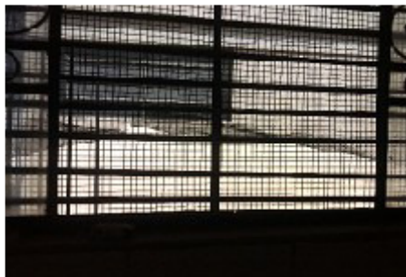
Tela de proteção milimétrica danificada
