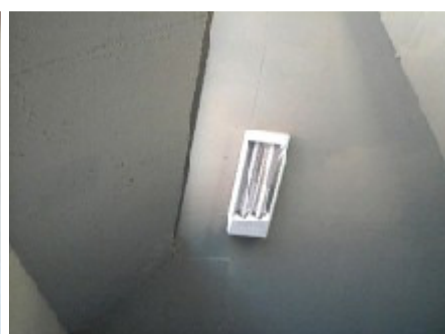
Lâmpadas queimadas – diversas salas
