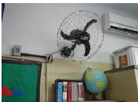
Ventilador com defeito e com fiação exposta – sala 11
