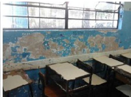
Queda de reboco – sala 3 (situação sinalizada em 2015)
