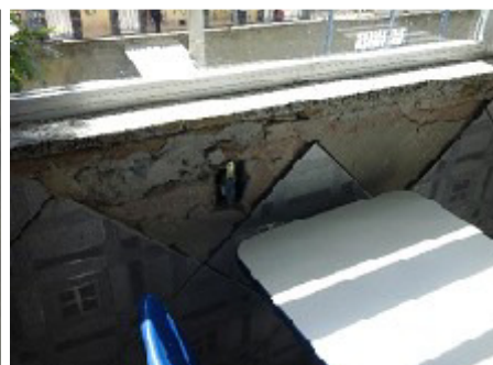
Queda de revestimento – sala 6 (situação sinalizada desde 2014)
