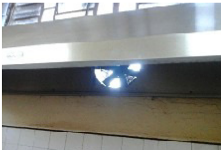
Coifa com defeito (situação sinalizada em 2015)
