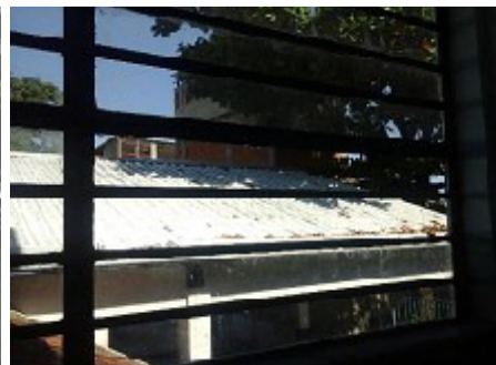
Vidros danificados/ausentes no basculante – acesso ao 1º andar
