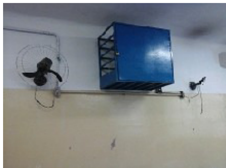
Ventilador danificado – sala 9
