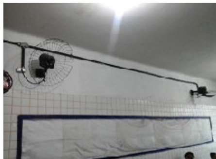
Ventiladores danificados – sala 8
