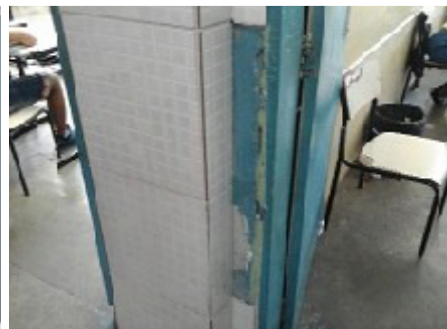
Queda de revestimento – entrada da sala 11
