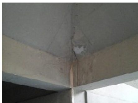
Pintura desgastada decorrente de infiltração sanada, conforme informado pela Direção – sala de judô
