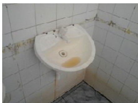
Pia danificada (solta) - vestiário masculino
