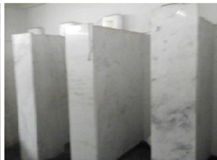
Ausência de porta em todos os boxes de vaso – vestiário feminino
