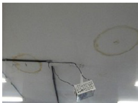
Infiltração recorrente (situação sinalizada em 2015) – auditório
