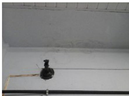
Infiltração – sala 6 (situação sinalizada em 2015)
