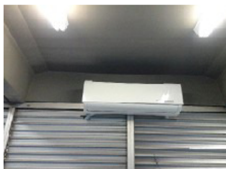
Único aparelho de ar-condicionado existente com defeito – salas 1, 2, 3, 4 e 10
