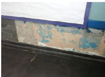
Queda de revestimento – sala 23
