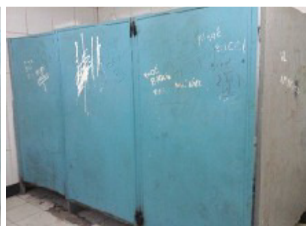
Pichações nas portas – banheiros masculino e feminino térreo
