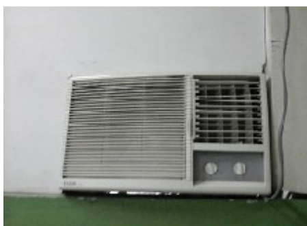
1 Aparelho de ar-condicionado com defeito – salas 2, 4, 5, 7 e 10
