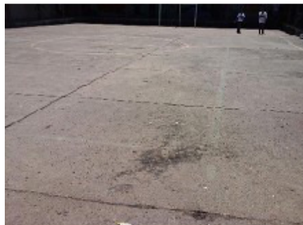
Piso precário (situação sinalizada desde 2010)
