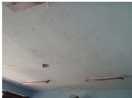
Ambiente sem iluminação devido a problemas na parte elétrica, conforme informado pela Direção- salas 2 e 5 prédio anexo
