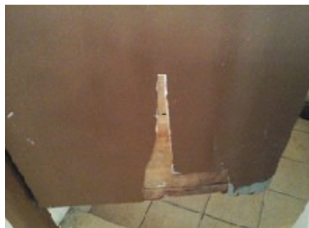
Porta danificada (2 boxes de chuveiro) – vestiário feminino
