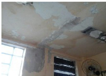
Infiltração decorrente de problemas no telhado, conforme informado pela Direção – sala do Mais de Educação
