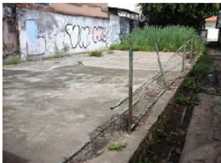
Alambrado danificado – área externa (situação sinalizada em 2015)
