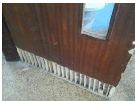
Porta danificada – sala 2
