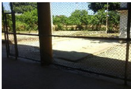
Alambrado danificado (situação sinalizada em 2015)
