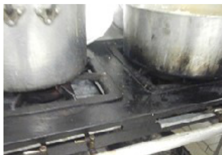
Necessidade de manutenção do fogão
