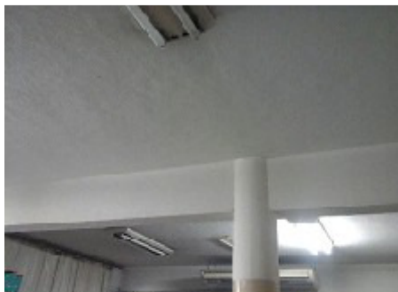
Lâmpadas queimadas – sala de leitura
