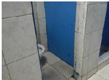
Ausência de porta (1 boxe) – banheiro masculino
