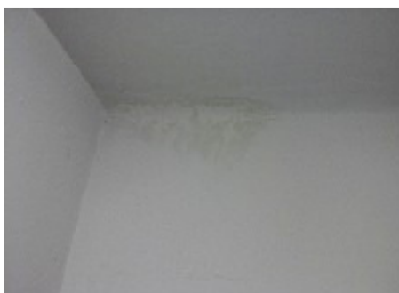
Pintura desgastada decorrente de infiltração sanada, conforme informado pela Direção – entrada do laboratório de informática
