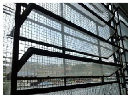
Basculantes enferrujados – acesso ao 1º andar (situação sinalizada desde 2012)
