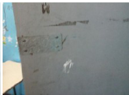
Ausência de maçaneta na porta – diversas salas
