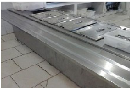
Balcão térmico dando choque, conforme informado pelos manipuladores de alimentos.
