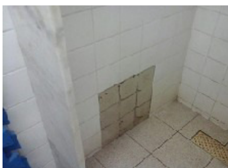
Queda de revestimento (1 box de chuveiro) – vestiário feminino
