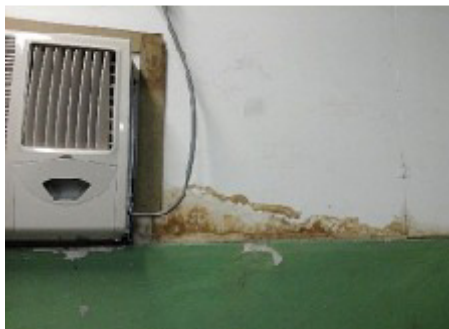
Infiltração na janela – sala 5
