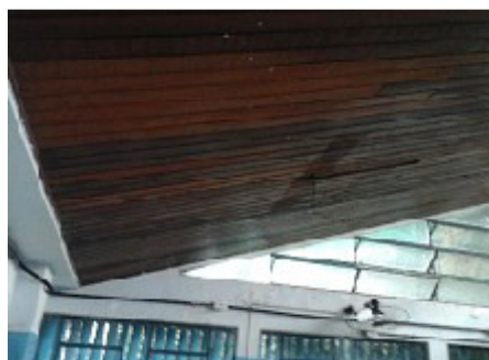
Ausência de luminária - sala 2 (situação sinalizada em 2015)
