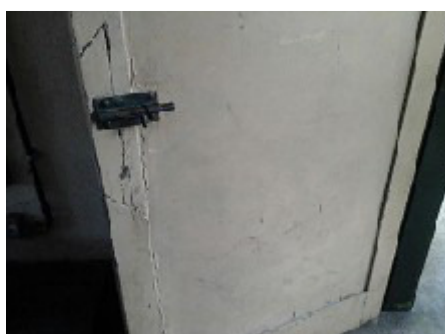
Porta danificada – sala 5
