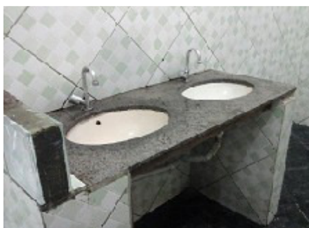
Ausência de lavatório adaptado para portadores de necessidades especiais – banheiro masculino
