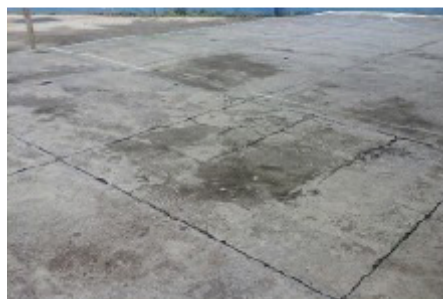
Piso precário (situação sinalizada desde 2014)
