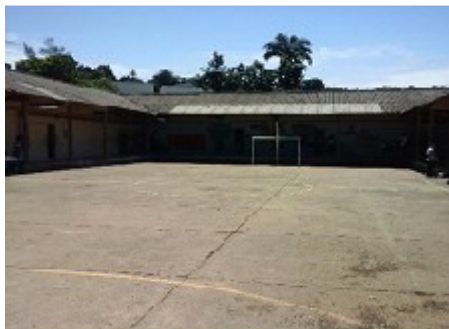
Quadra descoberta (situação sinalizada desde 2012)
