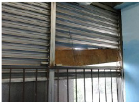
Basculantes danificados – sala 1
