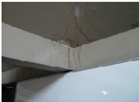
Pintura desgastada decorrente de infiltração sanada, conforme informado pela Direção – sala de música
