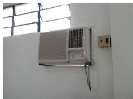
Aparelho de ar-condicionado com defeito – sala 14
