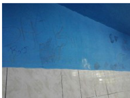
Pichações – banheiro masculino
