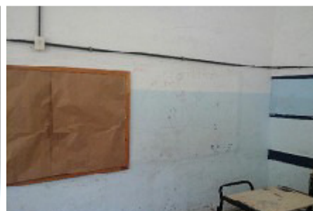
Pintura desgastada e pichações – diversas salas
