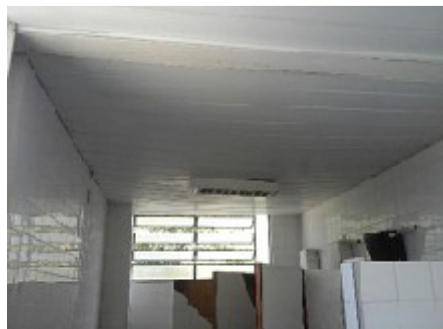
Lâmpadas queimadas - banheiro feminino prédio anexo 2
