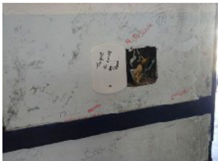
Fiação exposta - sala 5
