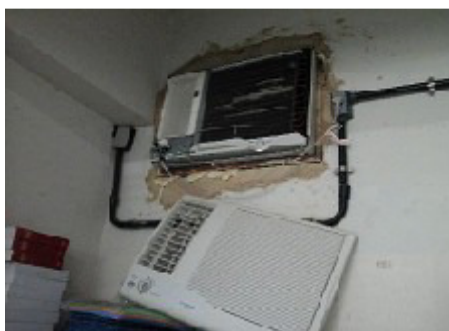
Aparelho de ar-condicionado danificado – sala 6 (situação sinalizada em 2015)
