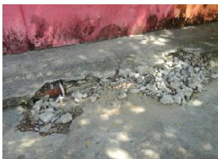
Piso danificado – área externa prédio anexo
