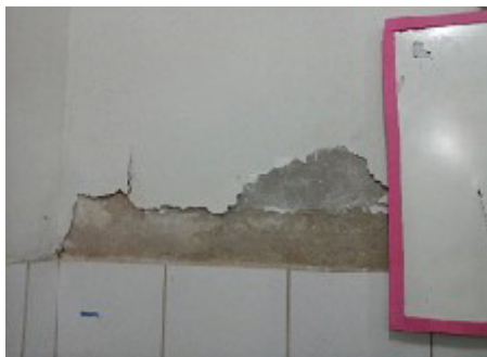
Queda de reboco – sala 5
