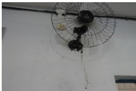
Ventilador com defeito e com fiação exposta
