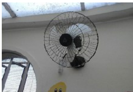
Ventilador com defeito
