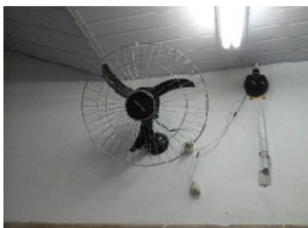
Ventilador com defeito – diversas salas
