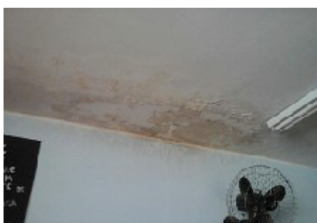
Pintura desgastada decorrente de infiltração sanada, conforme informado pela Direção – sala de artes (situação sinalizada em 2015)
