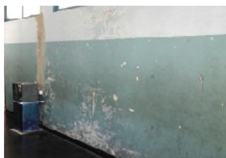
Pintura desgastada decorrente de infiltração sanada, conforme informado pela Direção – corredor 1º andar (situação sinalizada em 2015)
