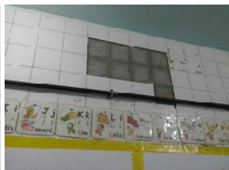
Queda de revestimento – sala 16 (situação sinalizada desde 2013)
