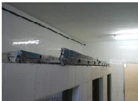
Escada móvel armazenada no banheiro masculino (situação sinalizada em 2015)
