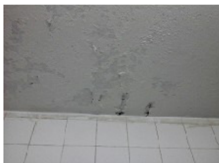
Queda de reboco com ferragem exposta
