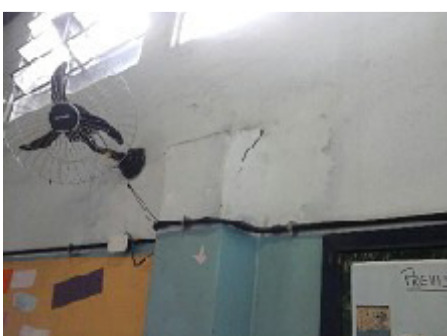
Rachadura - sala 1 (situação sinalizada em 2015)
