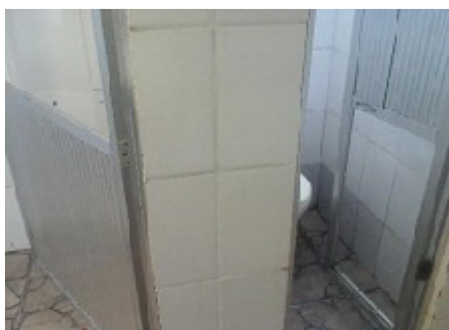
Porta danificada em todos os boxes - banheiro masculino térreo próximo ao acesso ao 1º andar
