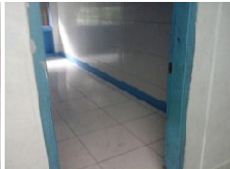
Ausência de porta – entrada do banheiro masculino 1º andar
