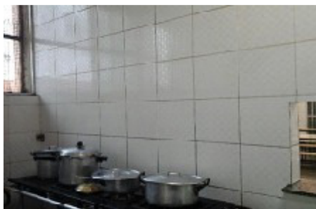
Ausência de coifa (situação sinalizada em 2014)
