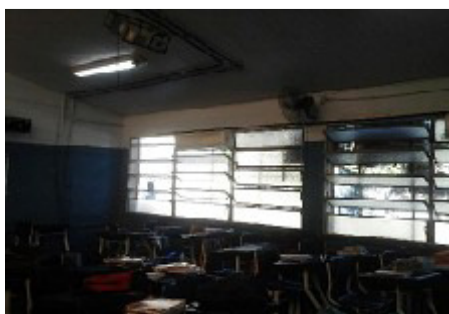
Aparelhos de ar-condicionado desligados devido a não conclusão do serviço prestado pela empresa contratada para realização de obras elétricas e instalação dos aparelhos, conforme informado pela Direção.
