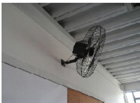
Ventilador com defeito e com fiação exposta – sala 8
