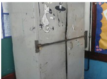
Armário danificado - sala 5
