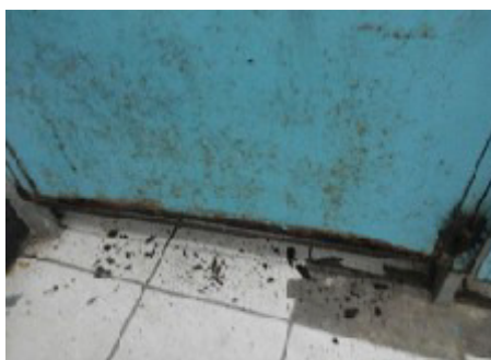
Portas danificadas – banheiro masculino térreo
