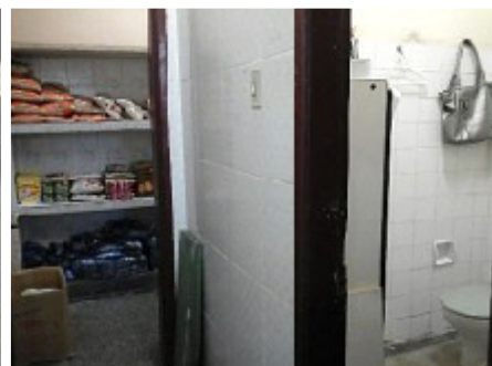
Instalações sanitárias em comunicação direta com a área de armazenamento de alimentos (situação sinalizada em 2014)
