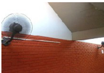
Ausência de grade de proteção no ventilador
