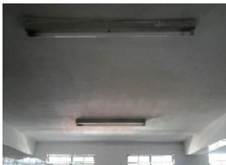
Todas as lâmpadas queimadas – banheiro feminino
