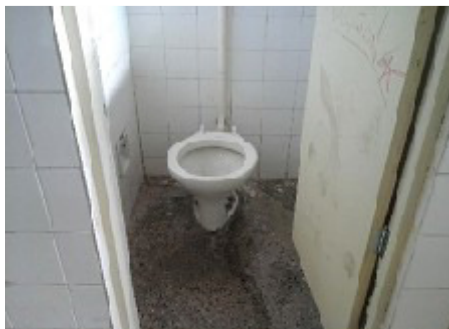
Ausência de assento sanitário (2 boxes) – banheiro masculino 2º andar
