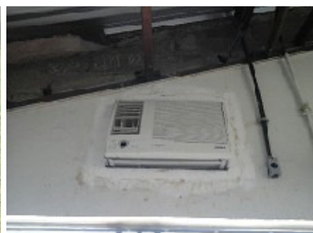
Aparelho de ar-condicionado danificado (ausência da fiação) - sala 12
