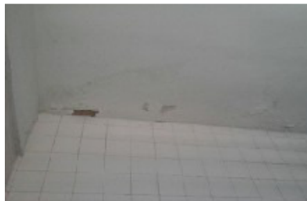
Infiltração decorrente de problemas no telhado, conforme informado pela Direção – laboratório de ciências (situação sinalizada desde 2013)
