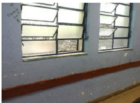
Ausência de vidro no basculante – sala 5
