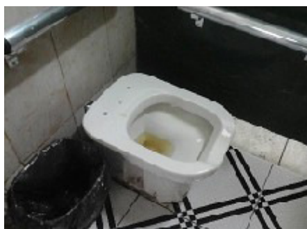
Ausência de assento sanitário (boxe para portador de necessidades especiais) – banheiro masculino térreo
