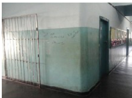
Pintura desgastada – corredor 1º andar (situação sinalizada em 2015)
