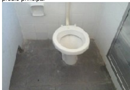
Ausência de assento sanitário (1 boxe) – banheiro feminino prédio anexo
