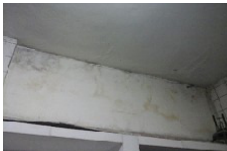
Infiltração (situação sinalizada desde 2013)
