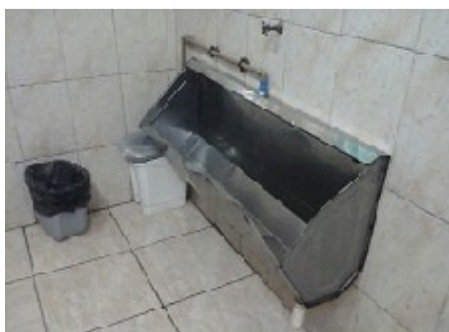
Mictório danificado – banheiro masculino térreo
