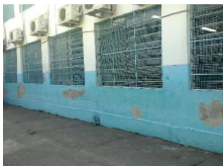
Pintura desgastada - área externa (situação sinalizada em 2015)
