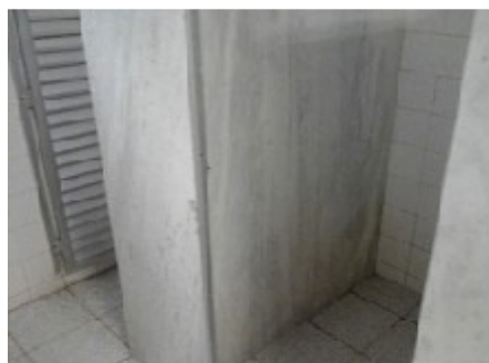
Ausência de porta (1 boxe de chuveiro) - vestiário feminino
