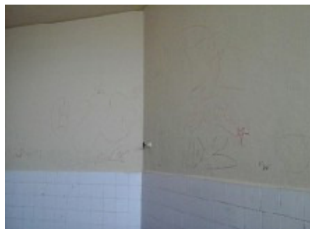
Pichações – banheiro feminino 2º andar
