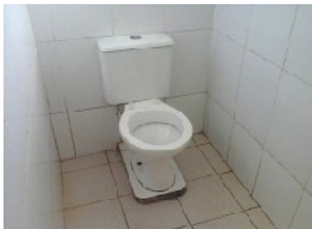
Ausência de assento sanitário (1 boxe) – banheiro masculino térreo próximo ao acesso ao 1º andar
