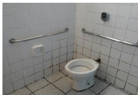
Ausência de assento sanitário (boxe para portador de necessidades especiais) – banheiros masculino e feminino térreo
