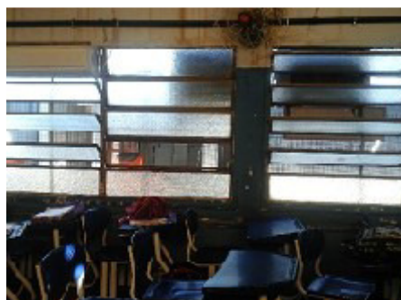
Ausência de vidro no basculante – sala 3
