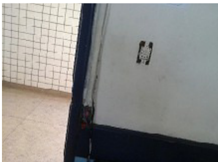
Fiação exposta – sala 3
