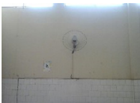
Ausência de grade de proteção no ventilador
