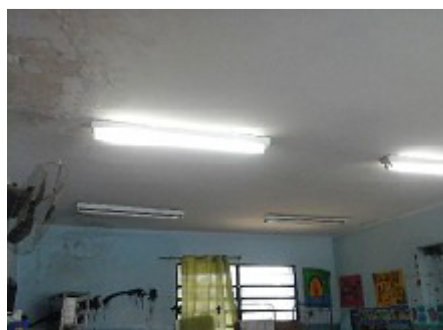
Lâmpadas queimadas – sala de artes
