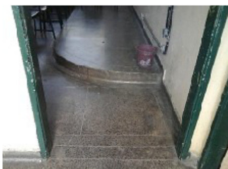
Ausência de porta – salas 11 e 15
