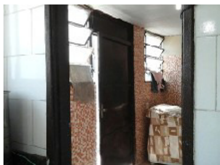
Ausência de porta (situação sinalizada em 2015)
