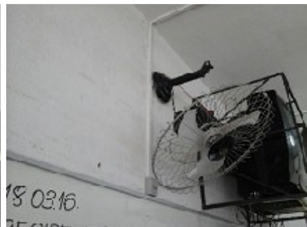
Todos os ventiladores danificados – salas 3 e 5 prédio principal
