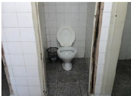
Portal danificado (1 boxe) – banheiro masculino do corredor
