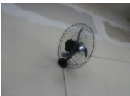
Ventilador com defeito – sala 6
