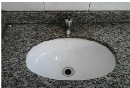
Torneira danificada – banheiro masculino prédio principal
