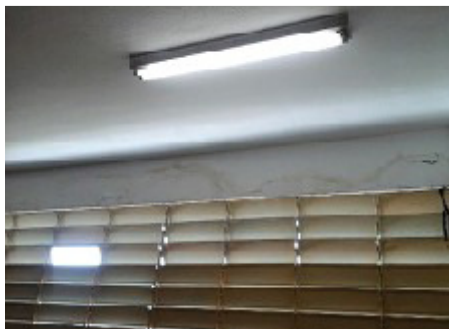
Pintura desgastada decorrente de infiltração sanada, conforme informado pela Direção – auditório
