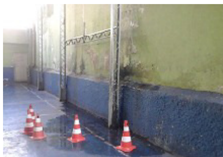
Infiltração devido à calha danificada (situação sinalizada em 2015)
