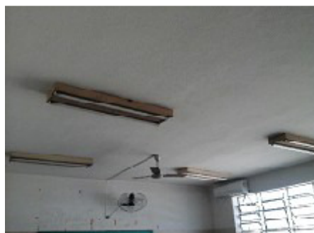
Lâmpadas queimadas – diversas salas
