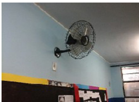
Ventilador com defeito - salas 1 e 16
