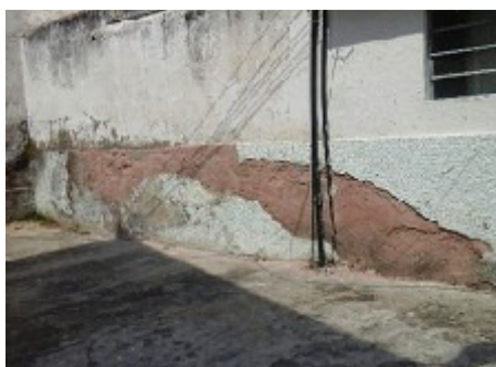
Queda de reboco – área externa
