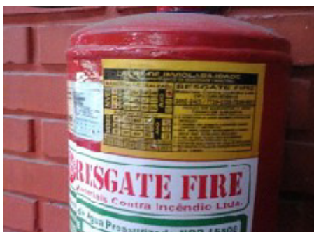
Extintor de incêndio vencido
