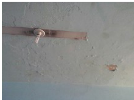
Pintura desgastada decorrente de infiltração sanada, conforme informado pela Direção - sala 5 prédio anexo. Situação sinalizada em 2015.
