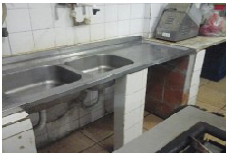
Ausência de acabamento (situação sinalizada desde 2014)
