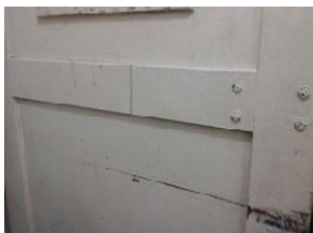
Ausência de maçaneta na porta – diversas salas
