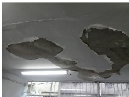
Infiltração – sala do postinho
