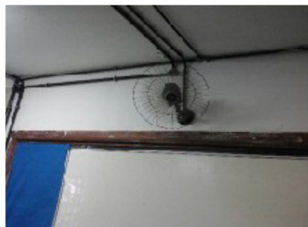
Ausência de grade de proteção no ventilador – sala 5
