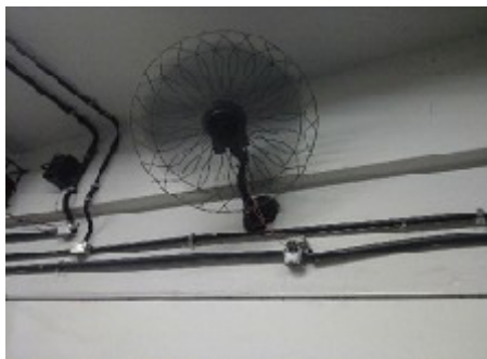
Fiação exposta no ventilador – sala 2
