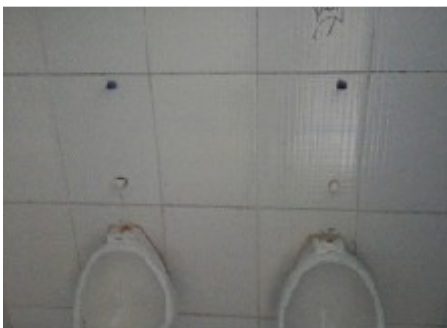
Ausência de registro dos mictórios - banheiro masculino 1º andar
