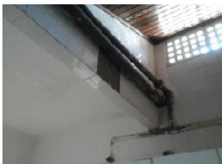
Queda de revestimento – banheiro masculino (situação sinalizada em 2015)
