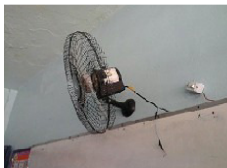
Ventilador com defeito e com fiação exposta – sala 5 prédio anexo
