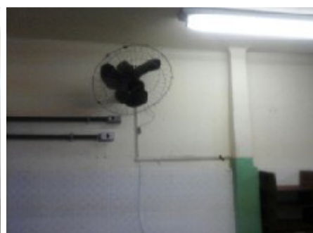
Ventilador com defeito e com fiação exposta
