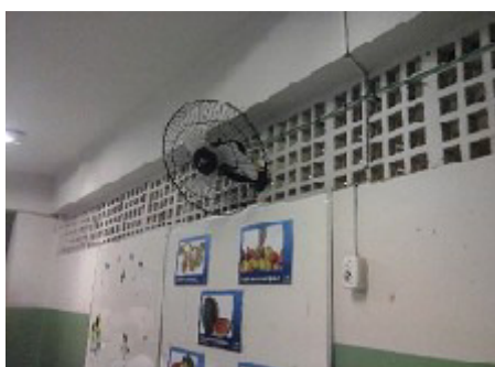
Ventilador com defeito
