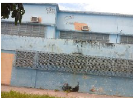
Pintura desgastada e pichações - área externa prédio principal (situação sinalizada em 2015)
