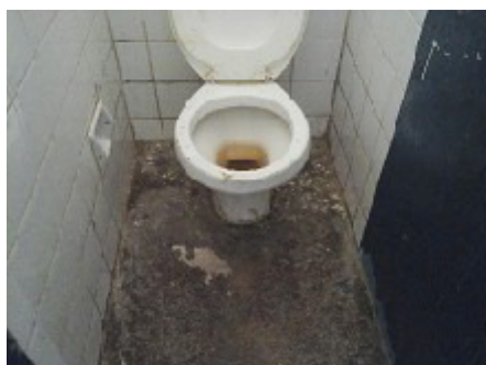
Necessidade de limpeza - vestiários masculino e feminino
