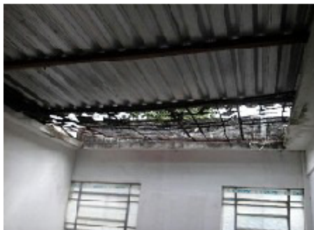
Ausência de parte do telhado - antiga casa do morador (situação sinalizada em 2015)
