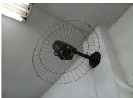
Ventilador danificado – salas 1 e 15 prédio principal
