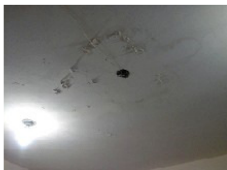
Pintura desgastada – sala 12
