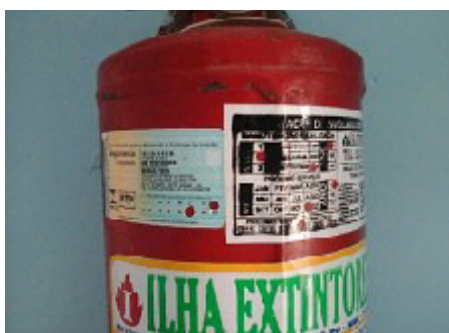
Extintor de incêndio vencido
