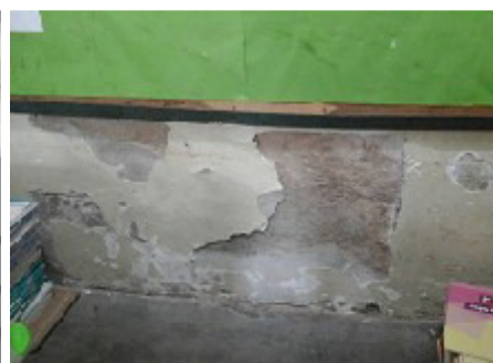
Queda de reboco – sala 12 (situação sinalizada desde 2014)
