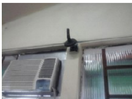
Ausência de 1 ventilador – sala 9
