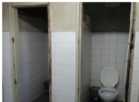
Ausência de porta em todos os boxes – banheiro masculino do corredor
