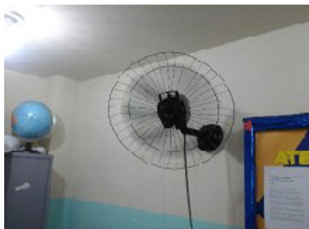
Ausência de grade de proteção no ventilador – salas 1 e 14
