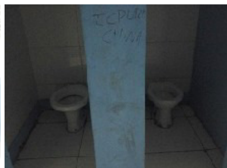
Ausência de assento sanitário e de porta em todos os boxes – banheiro masculino 1º andar
