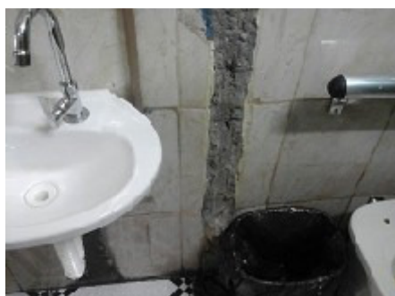
Queda de revestimento (boxe para portador de necessidades especiais) – banheiro masculino térreo
