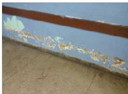
Queda de reboco - sala 2
