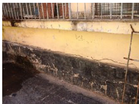
Rachadura - acesso à quadra (situação sinalizada desde 2013)
