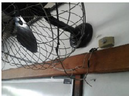
Ventilador com defeito e com fiação exposta – sala 9
