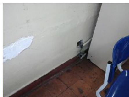
Fiação exposta – sala 12
