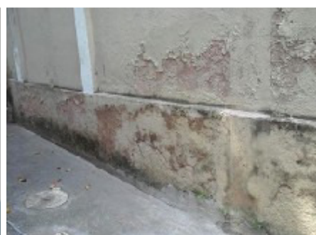
Infiltração - muro (situação sinalizada em 2015)
