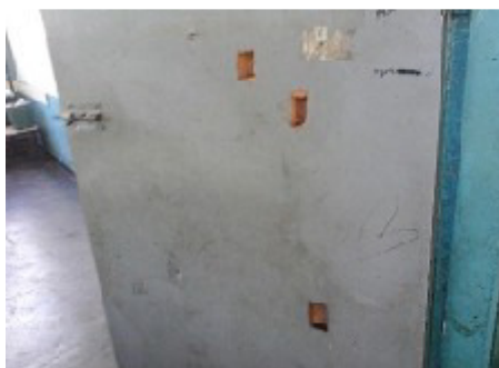
Porta danificada – sala 15
