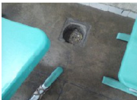
Ausência de tampa no ralo – sala 7
