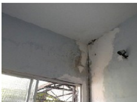
Infiltração (situação sinalizada em 2015)
