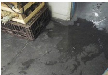
Empoçamento na entrada da despensa oriunda do freezer com defeito
