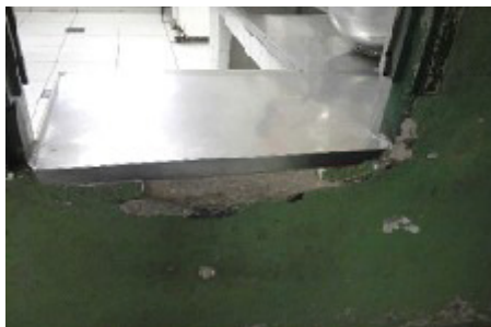
Queda de reboco
