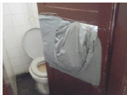
Porta danificada (1 boxe) – banheiro feminino
