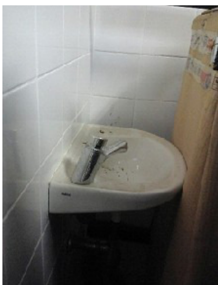
Ausência de barras de apoio junto ao lavatório – vestiário para portador de necessidades especiais
