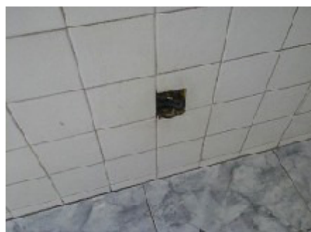
Fiação exposta - vestiário masculino
