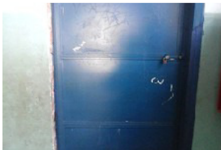
Banheiros masculino e feminino desativados – 1º andar
