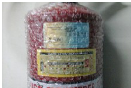
Extintor de incêndio vencido
