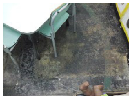
Piso precário – sala 20 (situação sinalizada desde 2013)
