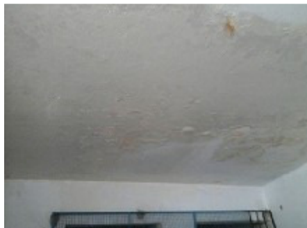
Infiltração - antiga casa do morador (situação sinalizada em 2015)
