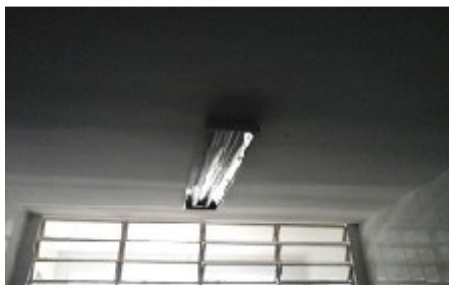
Lâmpadas queimadas – banheiro feminino térreo
