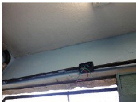
Fiação da distribuição elétrica interna para uso dos aparelhos de ar-condicionado exposta – sala 2
