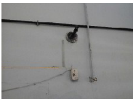
Ausência de 1 ventilador – diversas salas
