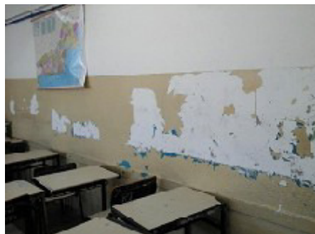
Pintura desgastada – diversas salas
