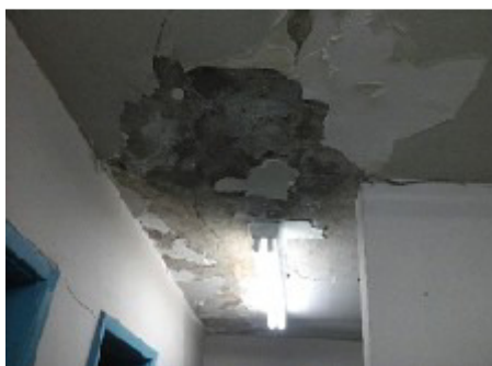
Infiltração – acesso ao laboratório de ciências
