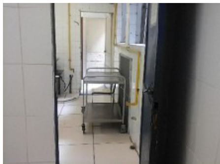
Instalações sanitárias em comunicação direta com a área de armazenamento de alimentos (situação sinalizada desde 2014)
