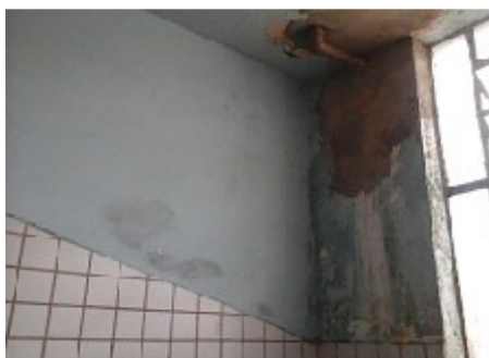
Pintura desgastada decorrente de vazamento sanado, conforme informado pela Direção – acesso ao 1º andar
