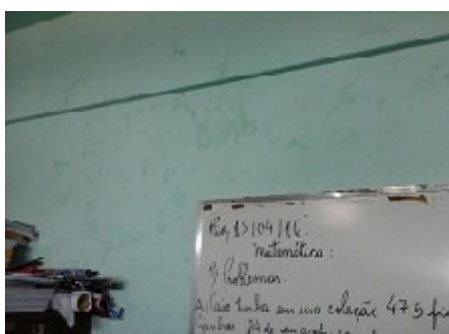
Pintura desgastada decorrente de infiltração sanada, conforme informado pela Direção – sala 8
