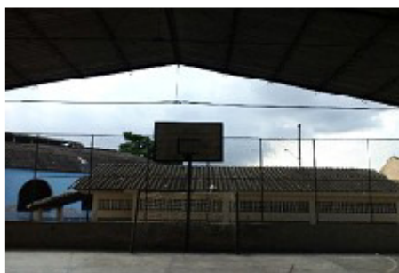
Ausência de tela de proteção (situação sinalizada em 2014)
