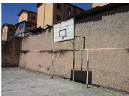
Equipamento danificado (tabela de basquete). Situação sinalizada desde 2014.
