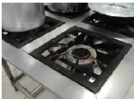
Necessidade de manutenção do fogão (situação sinalizada desde 2014)
