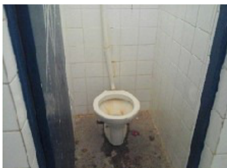
Ausência de assento sanitário (1 boxe) – vestiário feminino
