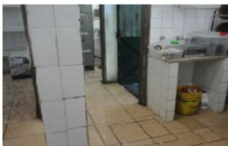
Instalações sanitárias em comunicação direta com a área de armazenamento de alimentos (situação sinalizada desde 2014)
