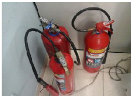
Extintores de incêndio armazenados num mesmo local (secretaria)
