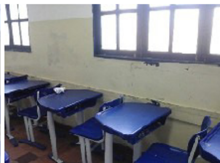
Pintura desgastada – diversas salas
