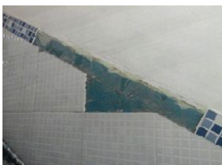
Queda de revestimento – acesso ao 1º andar
