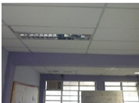
Lâmpadas queimadas (situação sinalizada em 2015)
