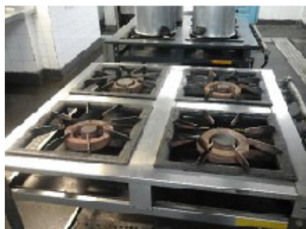
Necessidade de manutenção nos fogões
