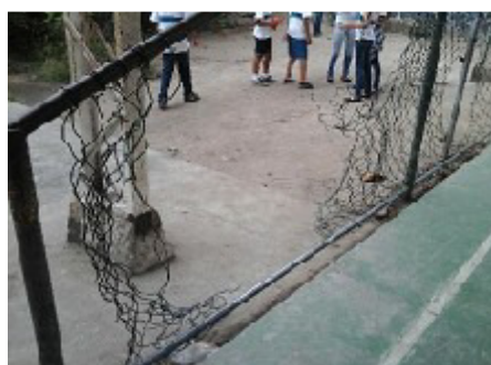
Alambrado danificado (situação sinalizada em 2015)
