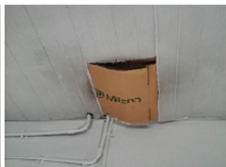
Forro danificado – sala 16 (situação sinalizada em 2015)
