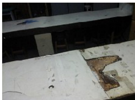
Bancadas danificadas - laboratório de ciências
