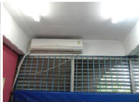
Único aparelho de ar-condicionado existente com defeito – sala de leitura
