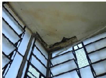
Queda de reboco – sala 4
