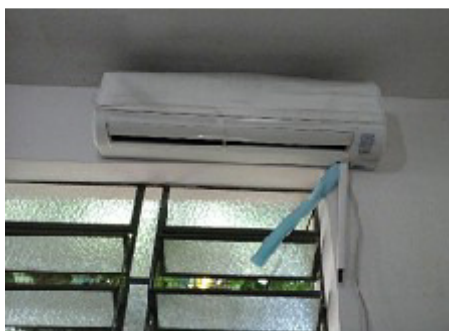
Todos os aparelhos de ar-condicionado com instalação danificada - sala 11
