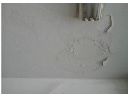
Infiltração – sala 14 (situação sinalizada em 2015)
