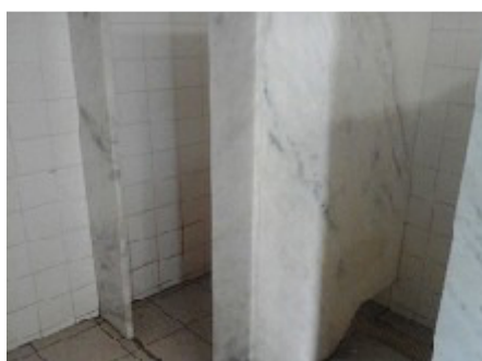
Ausência de porta (4 boxes de chuveiro) – vestiário masculino
