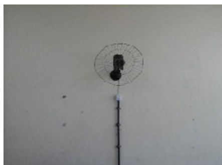
Único ventilador existente danificado – salas 3 e 22
