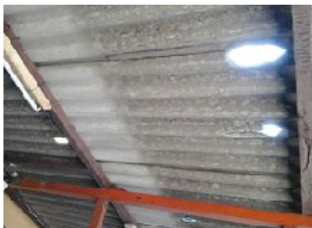
Telhado danificado - entrada do prédio principal (situação sinalizada desde 2014)
