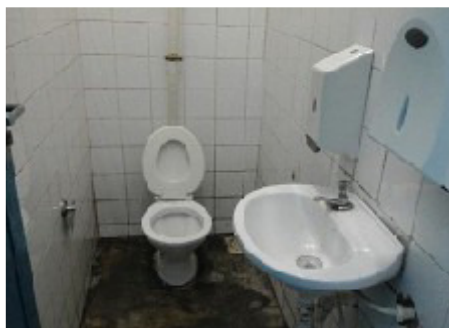
Ausência de água nos banheiros da Educação Infantil - prédio anexo
