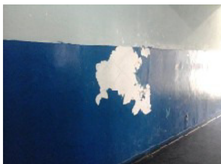
Pintura desgastada – corredor térreo prédio principal (situação sinalizada em 2015)
