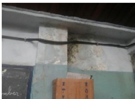
Infiltração - sala 17 (situação sinalizada em 2015)
