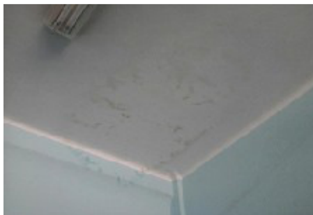
Pintura desgastada decorrente de infiltração sanada, conforme informado pela Direção – sala 14 (situação sinalizada em 2015)
