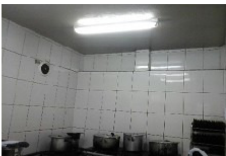
Ausência de coifa (situação sinalizada em 2015)
