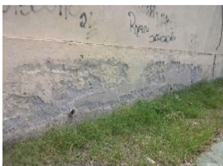
Queda de reboco – muro
