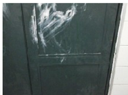
Boxe desativado – banheiro masculino térreo
