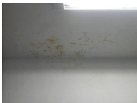
Pintura desgastada decorrente de infiltração sanada, conforme informado pela Direção – corredor 1º andar próximo à sala 11
