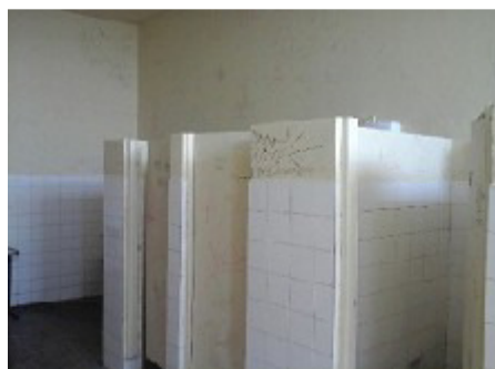
Pichações – banheiro masculino 2º andar
