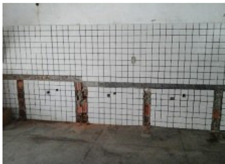
Ausência de acabamento – térreo próximo ao refeitório
