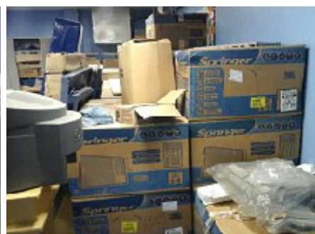
Aparelhos de ar-condicionado armazenados na sala 7 (desativada). Situação sinalizada em 2015.
