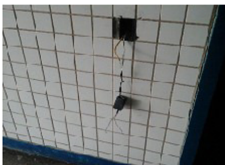
Fiação exposta e ausência de validador (Riocard) - térreo próximo à sala do núcleo
