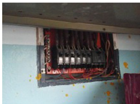
Fiação exposta - sala de artes (situação sinalizada em 2015)
