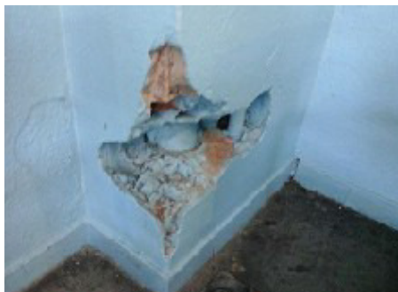
Queda de reboco – sala 8
