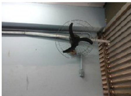
Ventilador com defeito – sala 6
