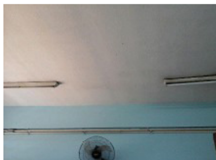
Lâmpadas queimadas – diversas salas e laboratório de ciências
