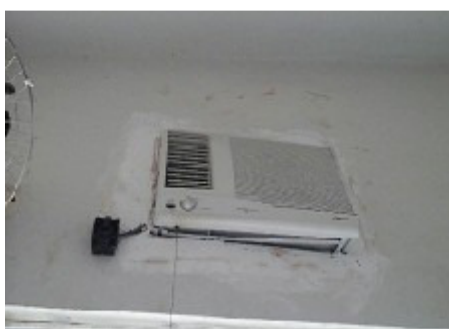
Aparelho de ar-condicionado danificado (ausência da fiação) - sala 14
