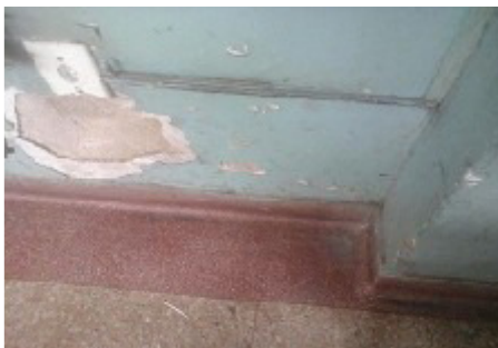
Queda de reboco - sala 16
