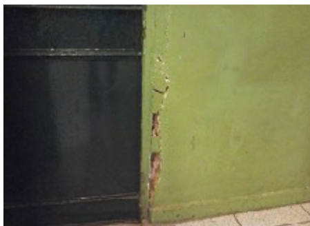
Queda de reboco – acesso à quadra
