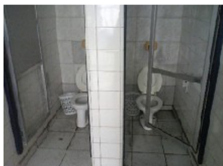
Porta danificada em todos os boxes - banheiro masculino térreo (antigo banheiro da Educação Infantil). Situação sinalizada em 2015.
