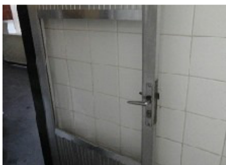
Porta danificada – entrada do banheiro masculino térreo
