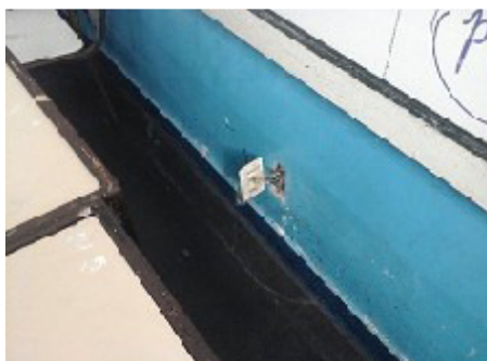
Fiação exposta – sala 7
