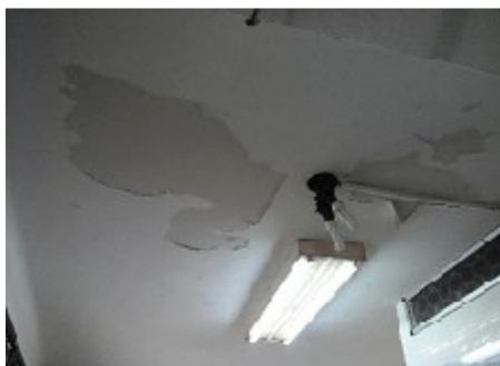
Pintura desgastada – entrada do refeitório (situação sinalizada em 2015)
