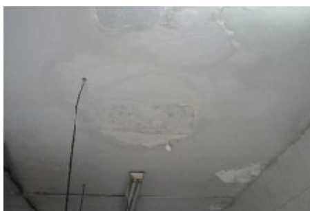
Pintura desgastada decorrente de infiltração sanada, conforme informado pela Direção (situação sinalizada desde 2014)
