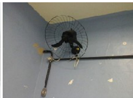
Ventilador danificado – sala 1
