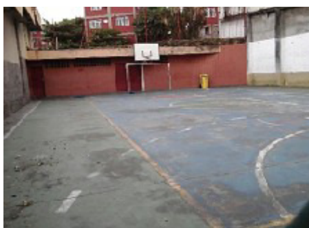
Quadra descoberta (situação sinalizada desde 2014)
