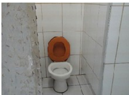
Ausência de porta (1 boxe) – banheiro masculino térreo
