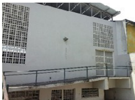
Ausência de longarinas ou balaústres entre o piso e o corrimão, situação que pode ocasionar acidentes – rampa de acesso à quadra. Situação sinalizada em 2014.
