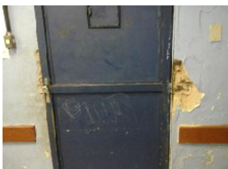
Queda de reboco – sala 5
