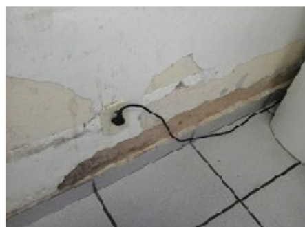
Queda de reboco – sala de estudos
