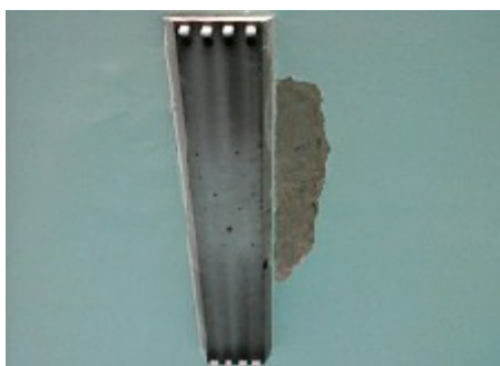
Queda de reboco – sala 4 (situação sinalizada em 2015). Ver comentário.
