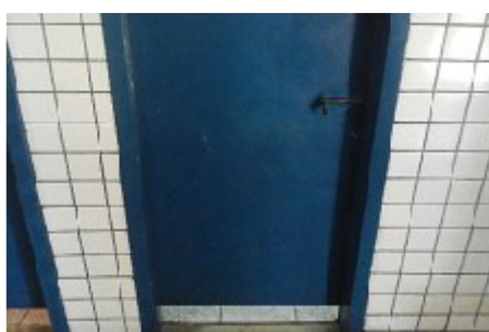
Banheiro masculino interditado devido a problemas hidráulicos - prédio anexo
