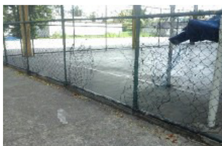
Alambrado danificado (situação sinalizada em 2015)
