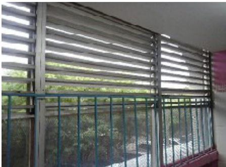
Ausência de grade/tela de proteção em parte da janela – banheiro feminino 1º andar
