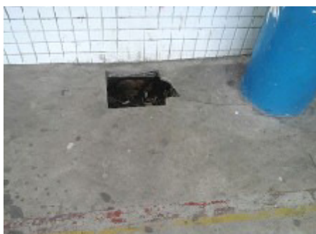
Ausência de tampas nos ralos
