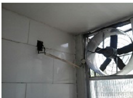
Fiação exposta (situação sinalizada em 2015)
