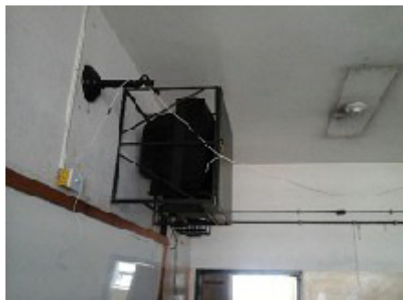
Fiação exposta – sala 5
