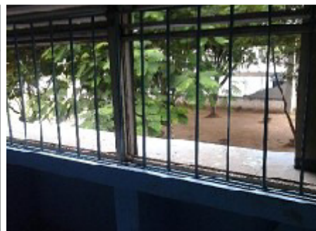
Vidros danificados/ausentes no basculante – banheiro masculino 1º andar
