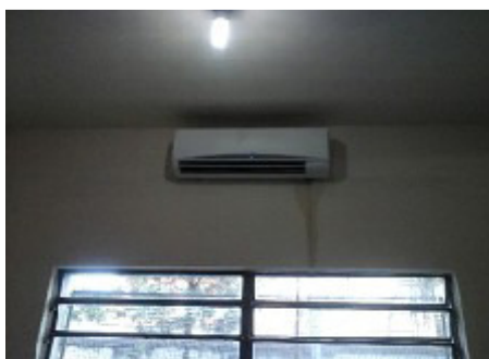
Infiltração oriunda do aparelho de ar-condicionado - sala 6
