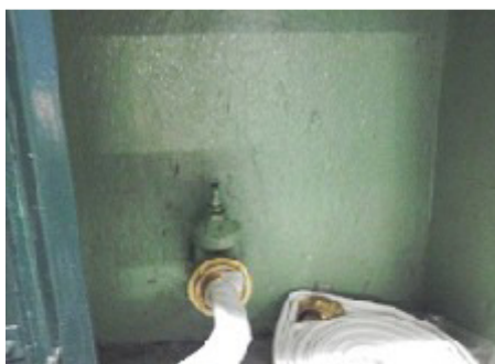
Registro da tubulação da mangueira de combate a incêndio danificada – 1º e 2º andares
