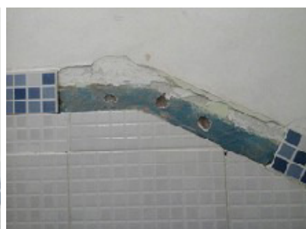
Queda de revestimento – acesso ao 2º andar
