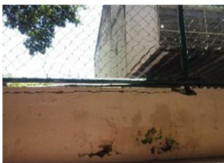
Rachadura (situação sinalizada em 2015)
