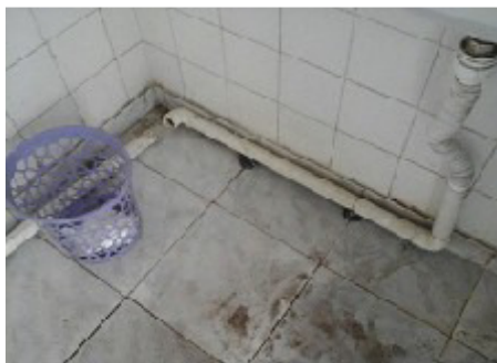
Tubulação danificada – banheiro feminino térreo
