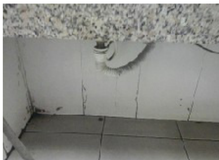
Tubulação danificada - banheiro feminino
