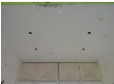
Ausência de lâmpadas (situação sinalizada desde 2014)
