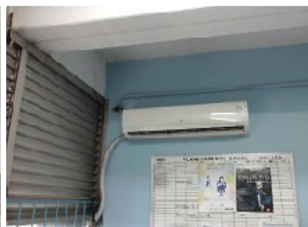
Único aparelho de ar-condicionado existente com defeito – sala da Direção
