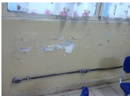
Pintura desgastada – sala de recursos
