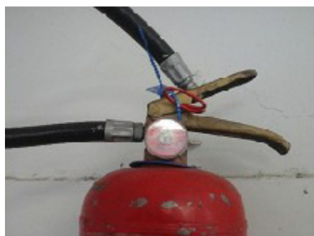
Necessidade de recarga de extintor de incêndio, conforme manômetro.
