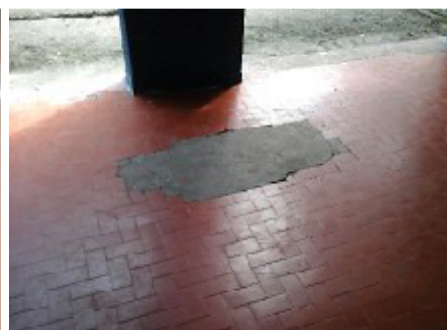
Piso danificado – pátio (situação sinalizada desde 2013)
