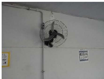
Ventilador com defeito
