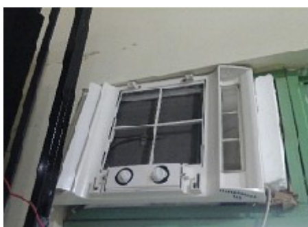
Aparelho de ar-condicionado danificado - sala 14
