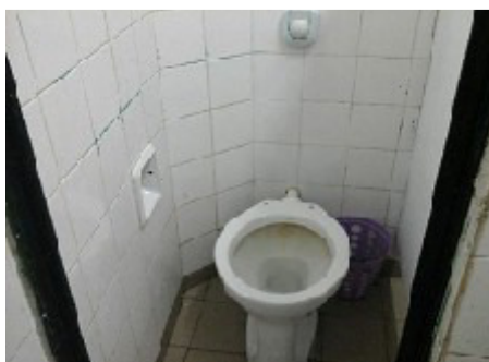
Ausência de porta e de assento sanitário (1 boxe) – banheiro feminino térreo
