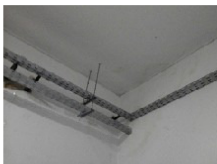
Pintura desgastada decorrente de infiltração sanada, conforme informado pela Direção – corredor 1º andar em frente ao auditório
