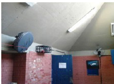
Todos os ventiladores com defeito – sala do Mais Educação (sala 9) e sala de música
