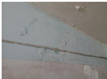
Infiltração – corredor 1º andar próximo à sala 16 (situação sinalizada em 2015)
