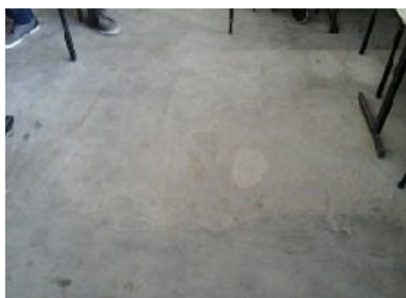
Piso danificado – sala 16 (situação sinalizada em 2015)
