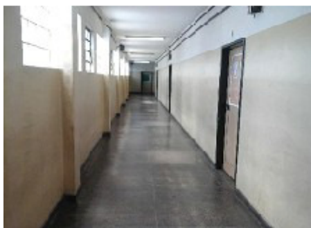
Ausência de extintor de incêndio nos corredores – prédio principal (situação sinalizada desde 2014)
