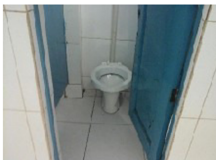
Ausência de assento sanitário (2 boxes) – banheiro feminino 1º andar
