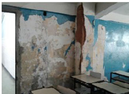
Infiltração e queda reboco – sala 14 (situação sinalizada desde 2014)
