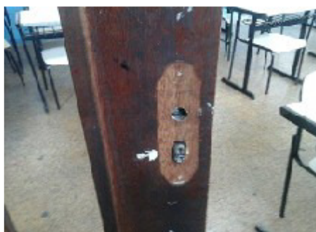
Ausência de maçaneta na porta – sala 6
