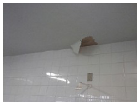
Pintura danificada - vestiário feminino
