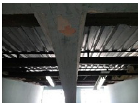
Forro danificado – corredor 1º andar (situação sinalizada desde 2011)
