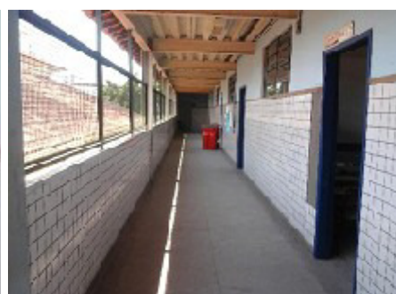
Ausência de extintor de incêndio nos corredores – prédio anexo 2 (situação sinalizada desde 2013)
