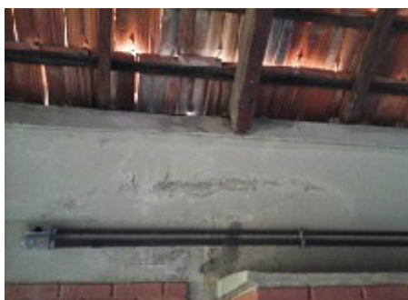
Pintura desgastada decorrente de infiltração sanada, conforme informado pela Direção – corredor próximo à sala 2
