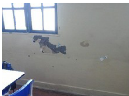
Queda de reboco – sala 11
