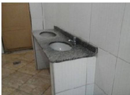
Ausência de lavatório adaptado para portadores de necessidades especiais – banheiro feminino
