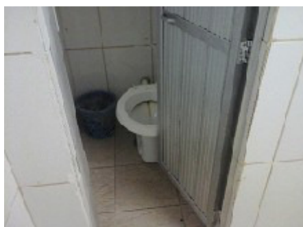
Ausência de assento sanitário (1 boxe) – banheiro feminino próximo ao refeitório
