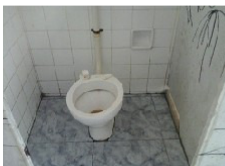
Ausência de assento sanitário e de porta no único box de vaso – vestiário masculino
