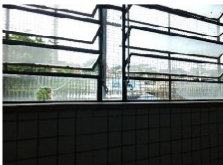
Vidros danificados/ausentes no basculante – acesso ao 1º andar (situação sinalizada em 2015)
