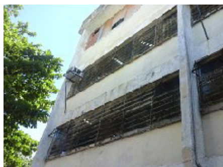
Grades de proteção danificadas - salas 1 e 4 (situação sinalizada desde 2013)
