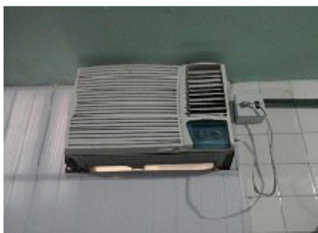
Único aparelho de ar-condicionado existente com defeito – sala 17
