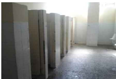
Ausência de banheiro adaptado para portadores de necessidades especiais
