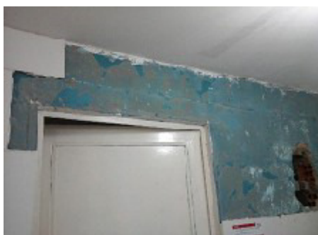
Queda de revestimento e alvenaria danificada – próximo à entrada da despensa
