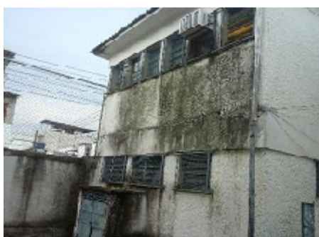
Infiltração - área externa próximo à quadra (situação sinalizada em 2015)
