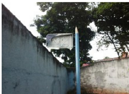
Totem danificado (situação sinalizada em 2015)
