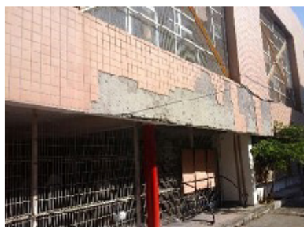
Queda de revestimento – área externa (situação sinalizada em 2015)
