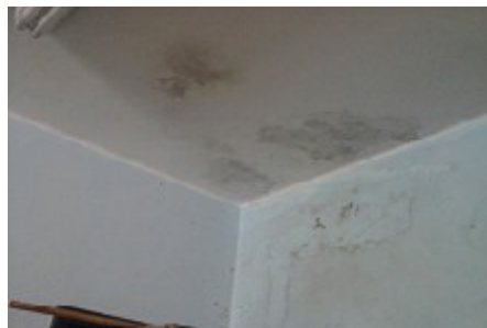
Pintura desgastada decorrente de infiltração sanada, conforme informado pela Direção – sala de artes (situação sinalizada em 2015)
