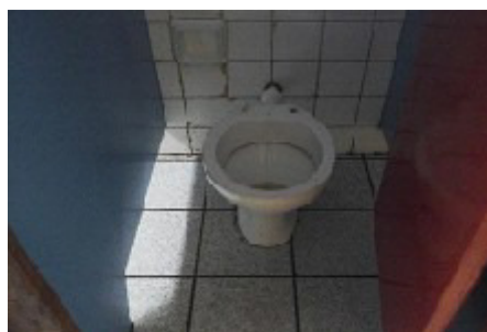
Ausência de assento sanitário em todos os boxes – banheiro masculino térreo
