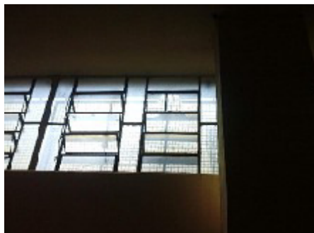
Vidro danificado no basculante – banheiro masculino 1º andar
