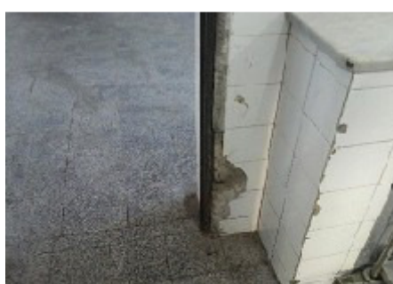
Queda de revestimento
