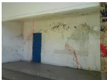
Pintura danificada por invasores, conforme informado pela Direção - entrada da sala de artes (situação sinalizada em 2015)
