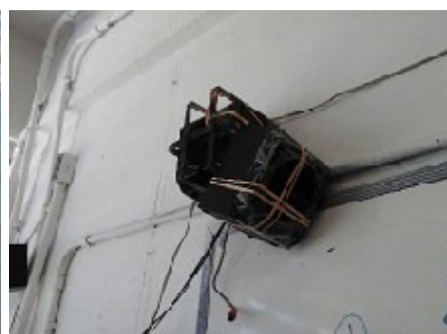
Caixa de som solta - sala 11
