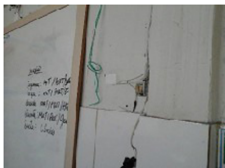
Fiação exposta – sala 8
