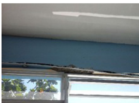
Queda de reboco – sala 12
