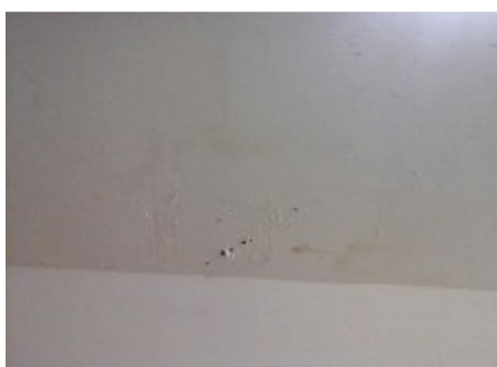
Pintura desgastada decorrente de infiltração sanada, conforme informado pela Direção – banheiro masculino 1º andar
