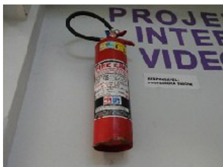
Extintor de incêndio vencido
