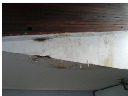
Infiltração – acesso ao 1º andar (situação sinalizada em 2015)
