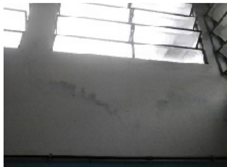
Infiltração - sala 7 (situação sinalizada em 2015)
