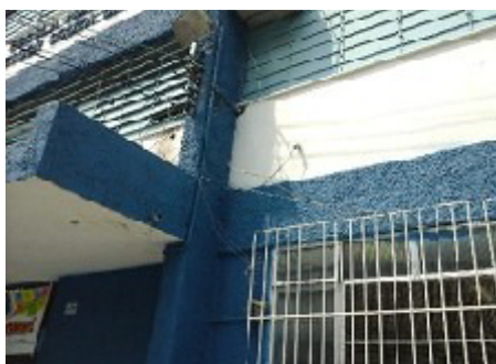
Fiação exposta – área externa
