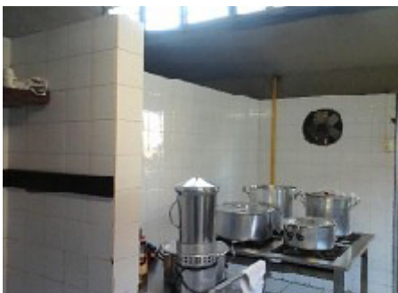
Ausência de coifa (situação sinalizada desde 2014)
