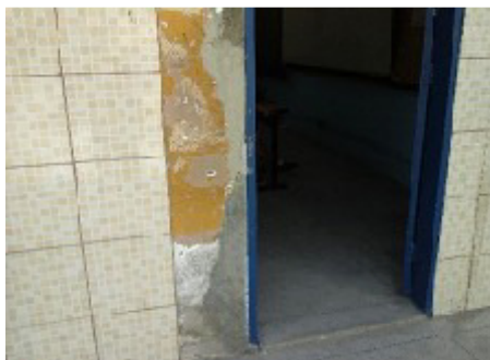
Queda de revestimento – entrada da sala 14 (situação sinalizada desde 2014)
