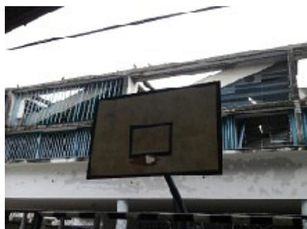
Equipamento danificado (tabela de basquete). Situação sinalizada em 2015.
