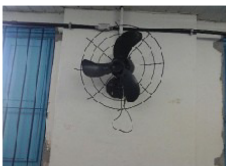
Ausência de grade de proteção no ventilador – auditório e sala de recursos
