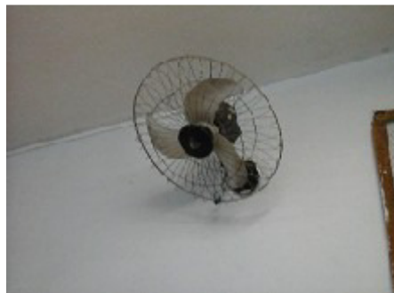
Ventilador com defeito
