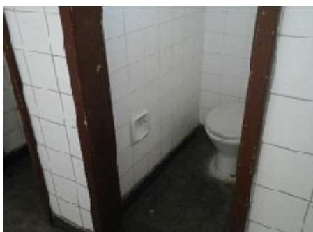
Ausência de porta (1 boxe) – banheiro feminino
