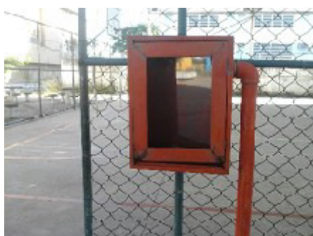
Ausência de mangueira de combate a incêndio e compartimento danificado – área externa (situação sinalizada em 2015)
