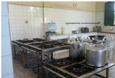
Ausência de coifa (situação sinalizada desde 2014)
