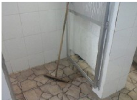
Porta danificada (1 boxe) – banheiro feminino térreo próximo ao acesso ao 1º andar
