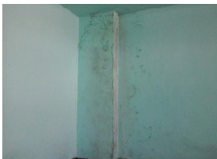
Infiltração – sala 4 (situação sinalizada desde 2013)
