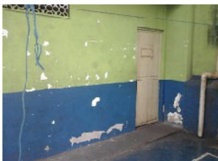
Vestiário 2 desativado (situação sinalizada desde 2013)
