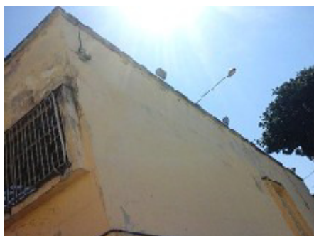
Refletores pendurados - área externa fundos (situação sinalizada desde 2013)
