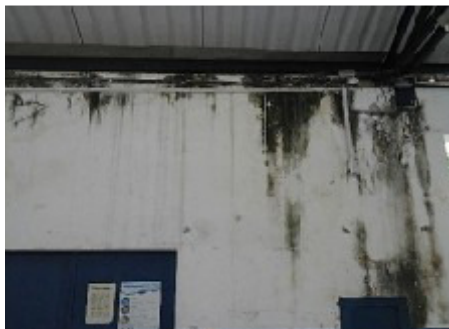
Infiltração - entrada do refeitório (situação sinalizada em 2012 e 2015)
