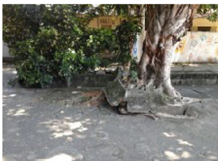
Piso danificado no entorno da árvore (situação sinalizada desde 2014)
