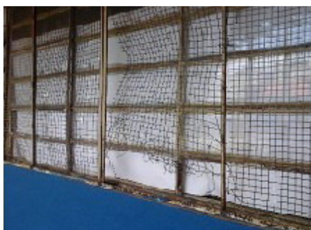
Grade de proteção danificada – anexo 3
