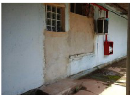
Ausência de acabamento – área externa (situação sinalizada em 2015)
