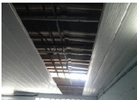
Forro danificado - corredor prédio anexo
