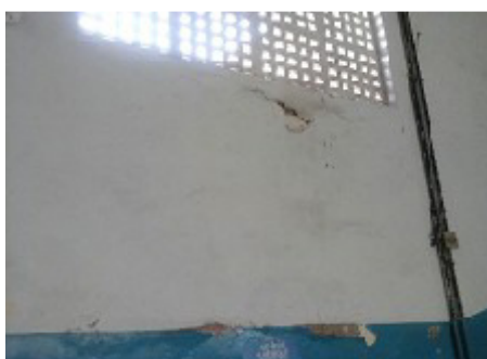
Infiltração e queda de reboco - auditório (situação sinalizada em 2015)
