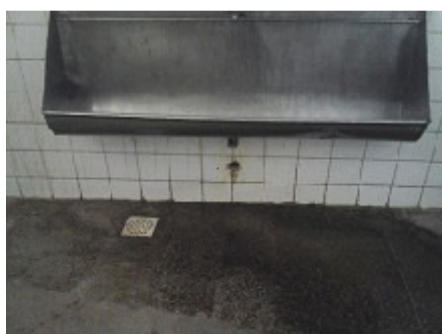
Tubulação danificada no mictório - vestiário masculino
