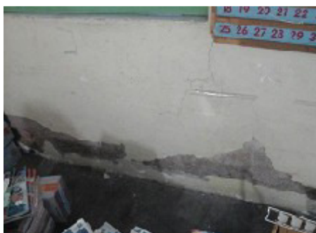
Queda de reboco – sala 12 (situação sinalizada em 2015)
