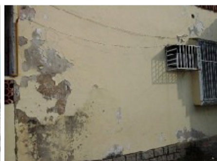
Pintura desgastada – área externa
