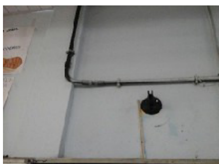
Ausência de 2 ventiladores – salas 4, 6 e 14
