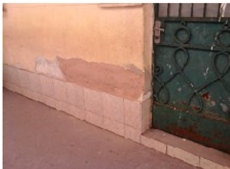
Queda de reboco – área externa prédio principal
