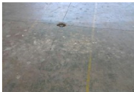
Presença de dejetos de pombos no piso (situação sinalizada em 2015)
