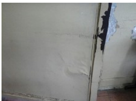
Porta danificada - sala 8
