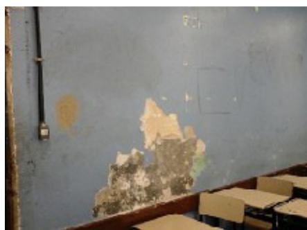
Pintura desgastada – diversas salas (situação sinalizada em 2015)
