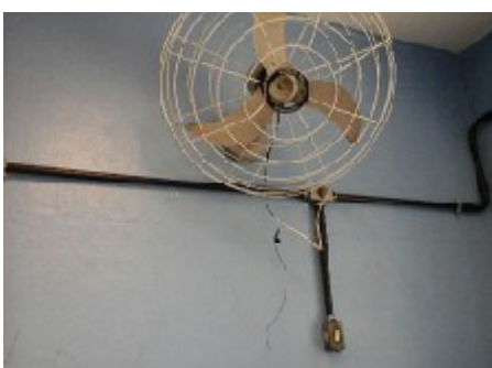
Ventilador com defeito e com fiação exposta – sala 16
