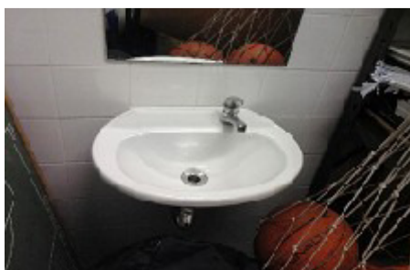
Ausência barras de apoio junto ao lavatório – vestiário para portador de necessidades especiais
