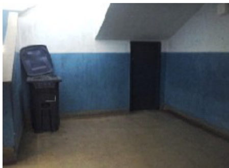
Ausência de extintor de incêndio no corredor das salas 11 a 17 (situação sinalizada desde 2013)
