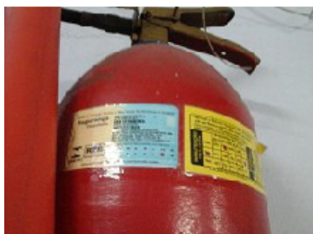
Extintores de incêndio vencidos
