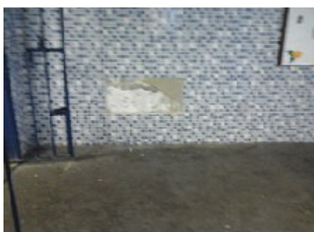
Queda de revestimento – térreo próximo ao refeitório
