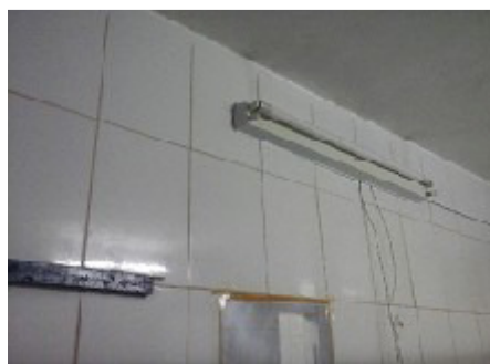
Lâmpadas queimadas/ausentes – banheiro masculino próximo ao refeitório
