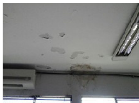
Pintura desgastada decorrente de infiltração sanada, conforme informado pela Direção – sala 5
