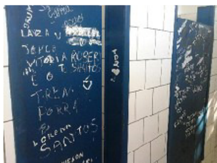
Pichações nas portas – banheiro feminino térreo
