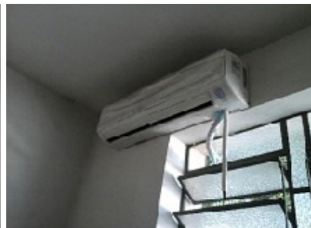
Todos os aparelhos de ar-condicionado com instalação danificada - salas 2 e 3 prédio principal
