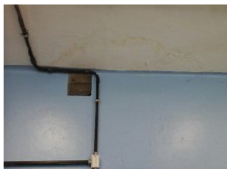
Pintura desgastada decorrente de infiltração sanada, conforme informado pela Direção – sala 10
