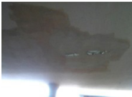
Pintura desgastada – pátio
