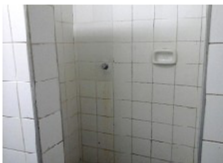
Ausência de porta (único boxe de chuveiro) - vestiário masculino. Situação sinalizada desde 2014.
