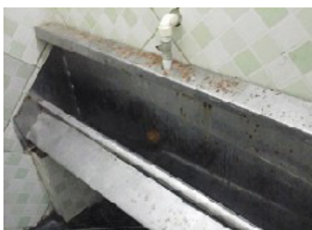
Mictório danificado – banheiro masculino
