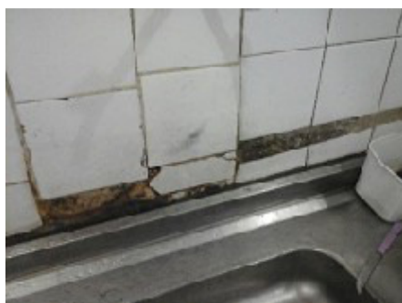
Queda de revestimento (situação sinalizada desde 2014)
