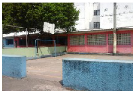
Ausência de alambrado - 2ª quadra (situação sinalizada em 2015)
