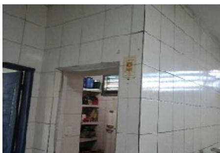
Ausência de extintor de incêndio (situação sinalizada desde 2014)
