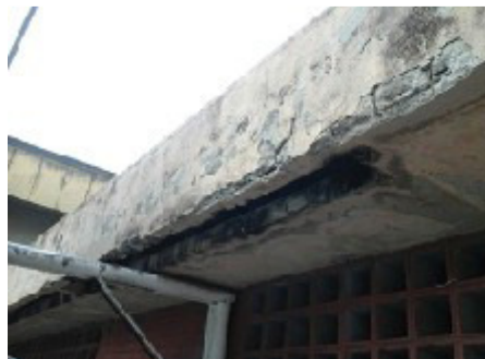
Queda de reboco com ferragem exposta (situação sinalizada em 2015)
