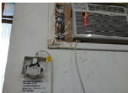
Fiação exposta – auditório (situação sinalizada em 2015)
