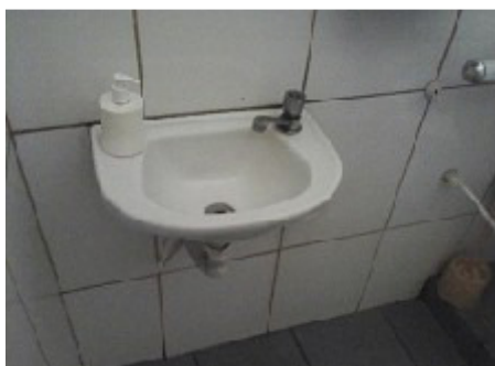
Ausência de barras de apoio junto ao lavatório e torneira de acionamento inadequado – banheiro para portador de necessidades especiais
