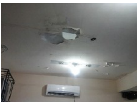
Infiltração decorrente de problemas no telhado, conforme informado pela Direção – sala 14
