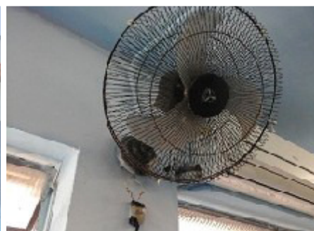
Ventilador com defeito e com fiação exposta – sala 12
