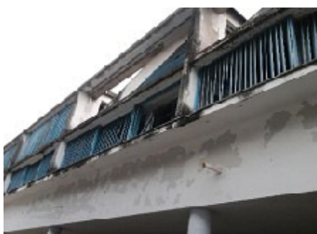
Pintura desgastada - área externa (situação sinalizada desde 2013)
