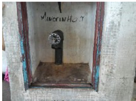
Ausência de mangueira de combate a incêndio (situação sinalizada em 2015)
