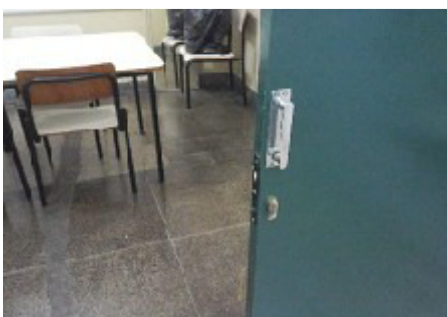
Ausência de maçaneta do tipo alavanca – banheiro para portador de necessidades especiais
