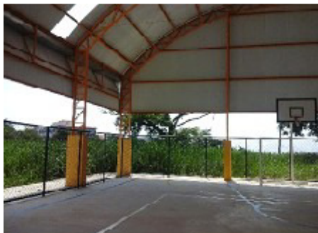
Ausência de tela de proteção
