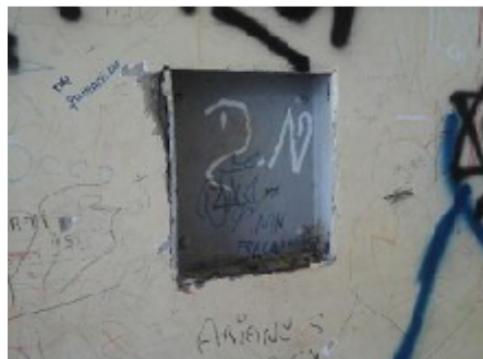
Disjuntor danificado ocasionando ausência de luz na quadra (situação sinalizada desde 2012)
