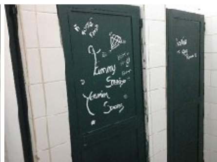
Pichações nas portas – banheiro feminino térreo
