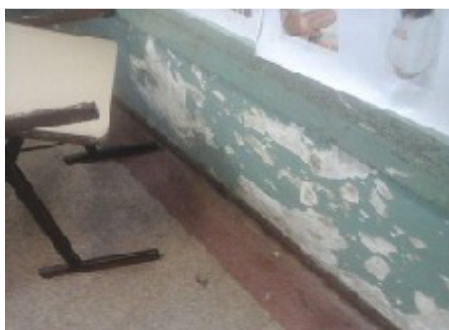
Queda de reboco - sala 15
