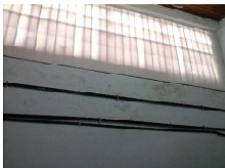
Infiltração – sala 11 (situação sinalizada desde 2014)
