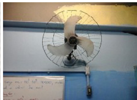
Ausência de grade de proteção no ventilador – salas 1 e 3
