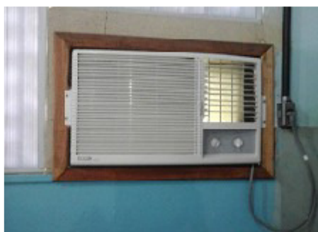
1 Aparelho de ar-condicionado com defeito – salas 3, 4, 5, 7 e 8
