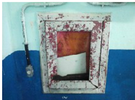
Ausência de mangueira de combate a incêndio e compartimento danificado – 1º andar (situação sinalizada em 2015)
