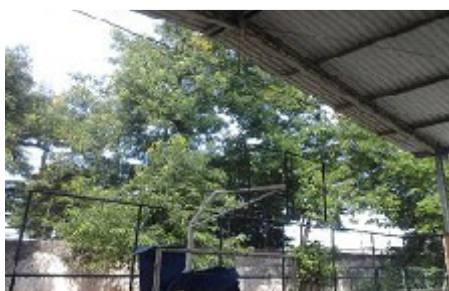
Equipamentos danificados (tabelas de basquete)
