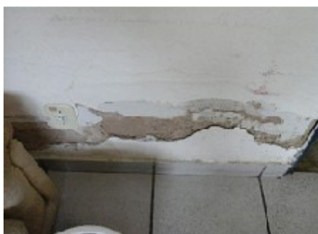
Queda de reboco – sala de estudos (situação sinalizada em 2015)
