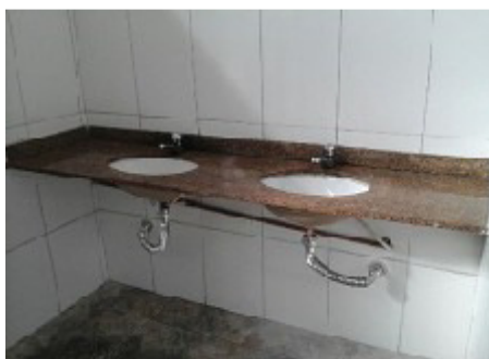
Ausência de lavatório adaptado para portadores de necessidades especiais – banheiro feminino prédio principal
