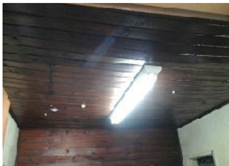
Forro apresentando curvatura – banheiro masculino do corredor
