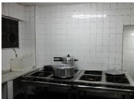
Ausência de coifa (situação sinalizada desde 2014)
