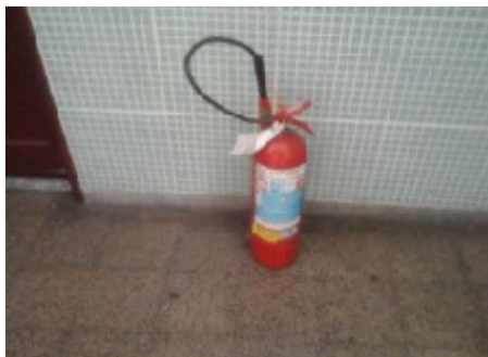
Extintor de incêndio instalado de forma inadequada - corredor térreo e 1º andar
