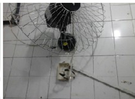
Fiação exposta no ventilador – sala 16
