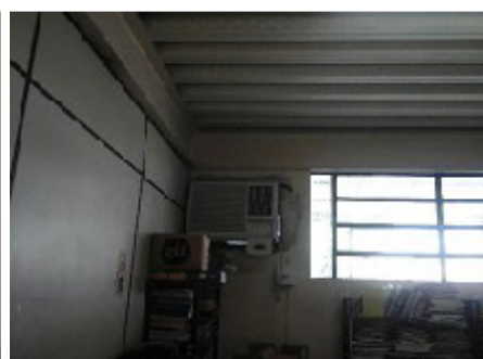
Aparelho de ar-condicionado com defeito – sala de leitura
