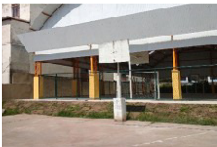
Equipamentos danificados (tabelas de basquete) – 2ª quadra (situação sinalizada desde 2014)
