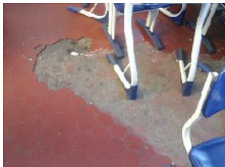
Piso danificado - salas 1, 2 e 3 (situação sinalizada em 2015)
