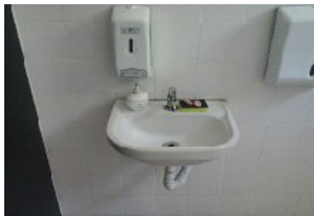
Ausência de barras de apoio junto ao lavatório - banheiro para portador de necessidades especiais
