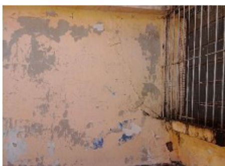
Rachadura – acesso à quadra (situação sinalizada em 2015)
