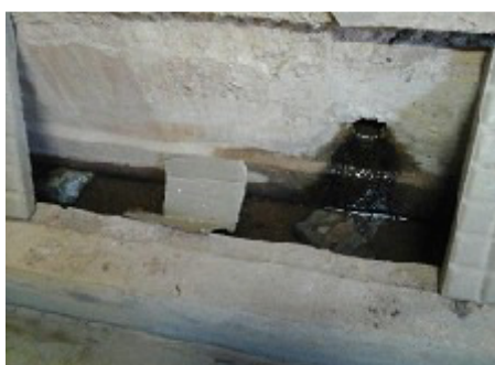
Acúmulo de água – corredor subsolo
