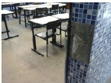
Queda de revestimento – entrada da sala 5
