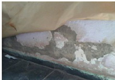
Infiltração e queda de reboco – sala 1 da classe especial (situação sinalizada em 2015)
