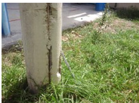
Poste com ferragem exposta - área externa próximo à quadra
