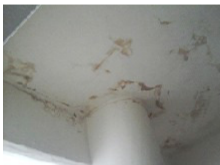
Infiltração – almoxarifado (situação sinalizada em 2015)
