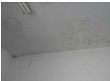
Infiltração (situação sinalizada em 2015)
