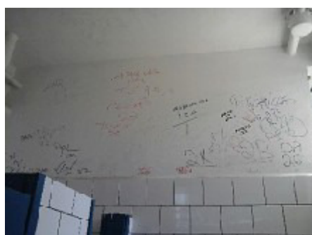
Pichações – banheiro masculino térreo
