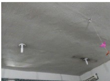
Lâmpadas queimadas – sala de leitura
