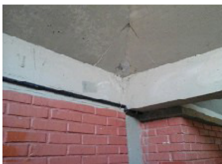
Pintura desgastada decorrente de infiltração sanada, conforme informado pela Direção – corredor próximo à sala 5
