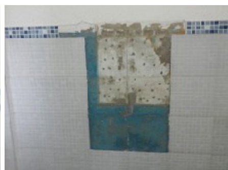
Queda de revestimento – corredor 3º andar
