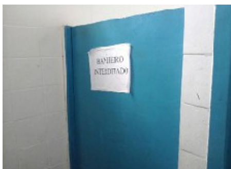
Boxe interditado – banheiro feminino corredor das salas 22 a 24
