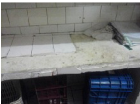
Queda de revestimento (situação sinalizada em 2015)
