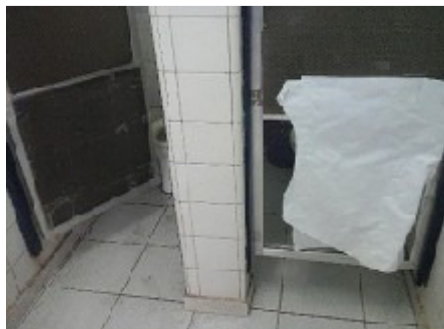
Porta danificada em todos os boxes – banheiro feminino térreo (antigo banheiro da Educação Infantil). Situação sinalizada em 2015.
