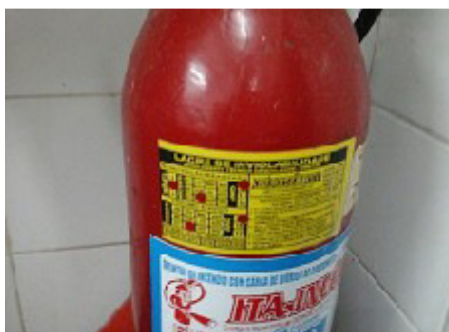
Extintor de incêndio vencido
