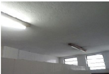
Lâmpadas queimadas – banheiro feminino prédio anexo
