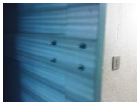
Ausência de maçaneta na porta – diversas salas
