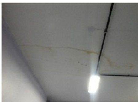
Infiltração recorrente (situação sinalizada em 2015) – auditório
