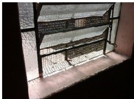
Ausência de vidro no basculante
