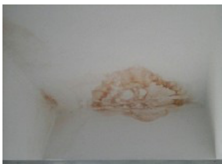
Infiltração – banheiro para portador de necessidades especiais (na sala 4). Situação sinalizada desde 2014.
