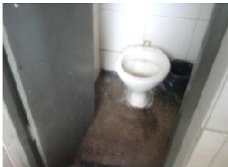
Ausência de assento sanitário (1 boxe) – banheiro masculino
