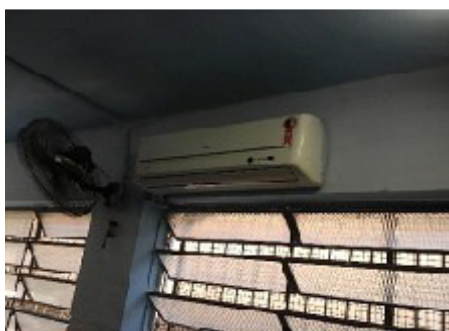
Aparelho de ar-condicionado com defeito – sala 12 (situação sinalizada em 2015)
