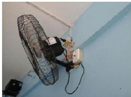
Queda de reboco – sala 11 (situação sinalizada em 2015)
