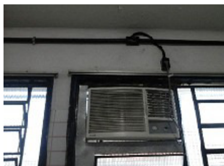
Único aparelho de ar-condicionado existente com defeito – salas 5 e 7
