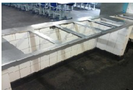
Ausência de balcão térmico
