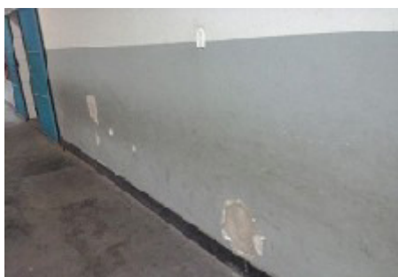
Queda de reboco
