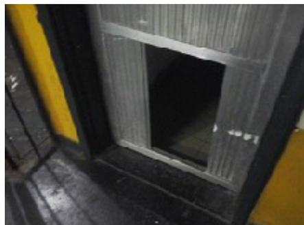
Porta danificada – entrada do banheiro masculino subsolo
