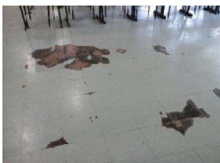
Piso danificado – auditório (situação sinalizada em 2015)
