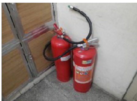
Extintores de incêndio armazenados num mesmo local (sala da Direção)
