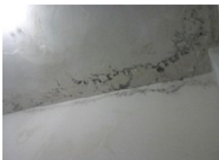
Pintura desgastada decorrente de infiltração sanada, conforme informado pela Direção – banheiro masculino térreo
