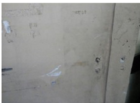
Ausência de maçaneta na porta – todas as salas de aula (situação sinalizada em 2015)
