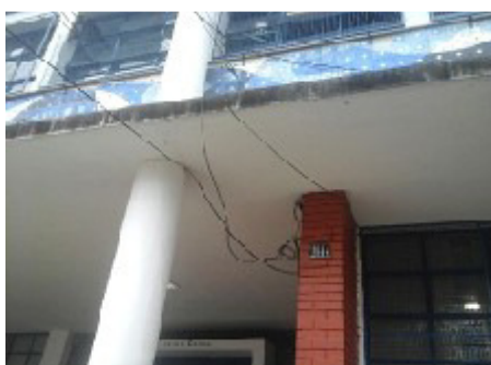
Fiação exposta – área externa (situação sinalizada desde 2013)
