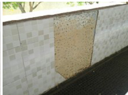
Queda de revestimento – acesso ao 1º andar
