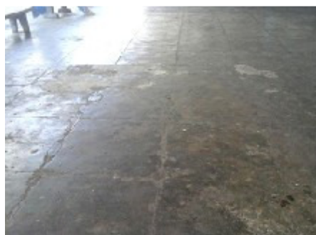
Piso danificado – pátio coberto
