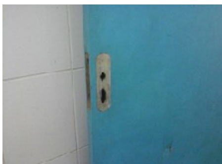
Ausência de maçaneta - entrada do banheiro masculino térreo próximo ao acesso ao 1º andar
