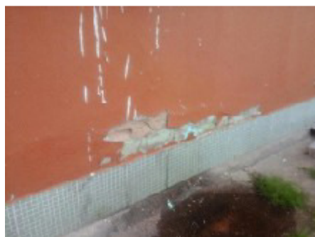
Queda de reboco – área externa
