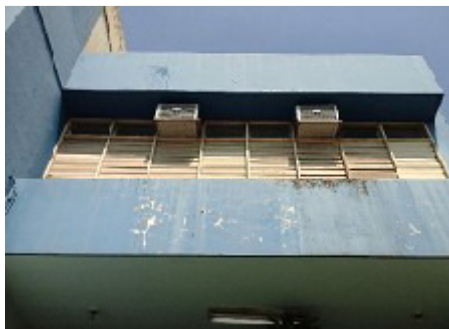
Pintura desgastada – área externa (situação sinalizada em 2015)
