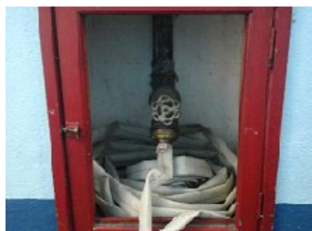
Porta do compartimento de mangueira de combate a incêndio danificada – corredor próximo à cozinha
