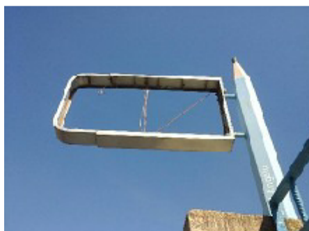
Totem danificado (situação sinalizada em 2015)
