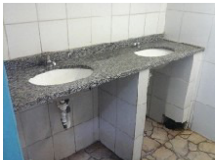
Torneiras danificadas - banheiro masculino térreo próximo ao acesso ao 1º andar
