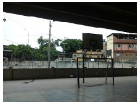
Ausência de tela de proteção
