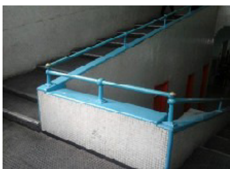
Guarda-corpo com altura inadequada, situação que pode ocasionar acidentes – acesso ao 1º andar prédio principal (situação sinalizada desde 2013)
