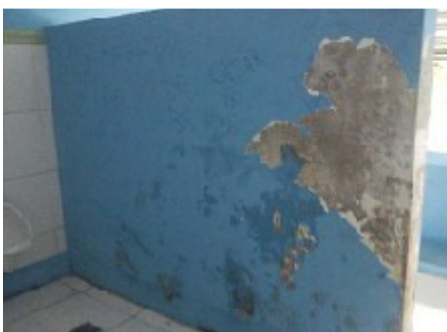
Pintura desgastada – banheiro masculino 1º andar
