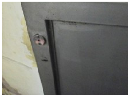
Ausência de maçaneta na porta – salas prédio anexo
