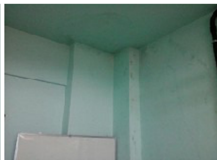
Infiltração – sala 7 (situação sinalizada em 2015)
