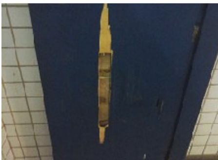
Porta danificada – entrada do banheiro masculino prédio anexo
