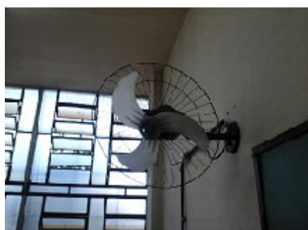
Ausência de grade de proteção no ventilador – salas 1, 2 e 6
