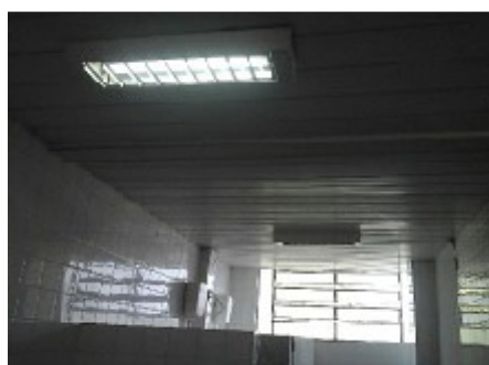
Lâmpadas queimadas - banheiro masculino prédio anexo 2
