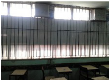
Vazamento de água oriunda do aparelho de ar-condicionado – sala 1
