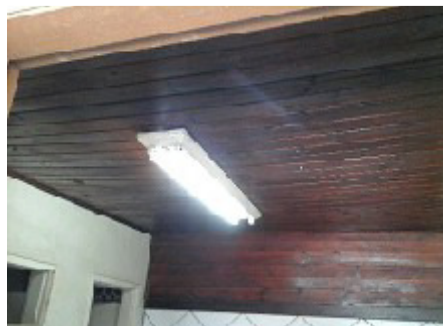
Forro apresentando curvatura – banheiro feminino do corredor
