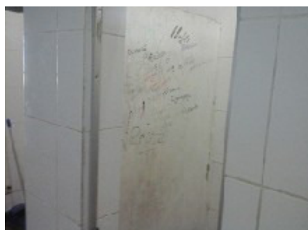
Pichações - banheiro feminino térreo próximo ao acesso ao 1º andar
