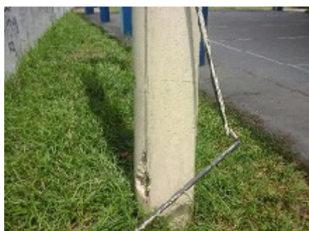
Poste com fiação exposta - área externa próximo à quadra (situação sinalizada desde 2014)
