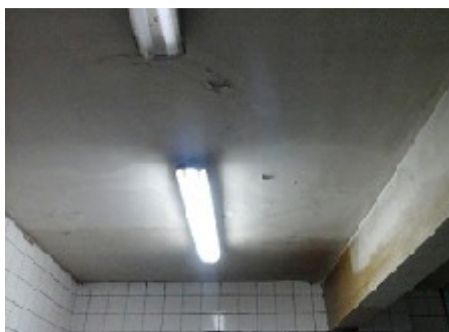
Pintura desgastada (situação sinalizada em 2014)
