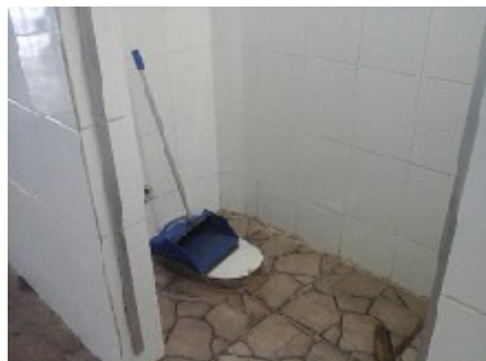
Ausência de vaso sanitário (1 boxe) - banheiro feminino térreo próximo ao acesso ao 1º andar
