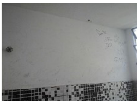
Pichações – banheiro feminino 2º andar
