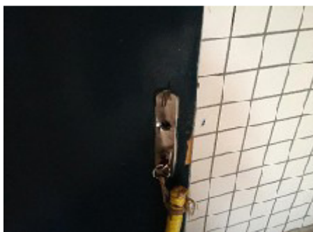
Ausência de maçaneta na porta – banheiro para portador de necessidades especiais
