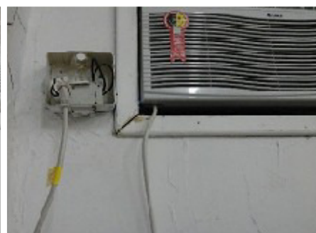
Fiação exposta – auditório
