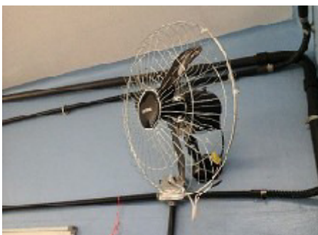
Ventilador com defeito – salas 8 e 18
