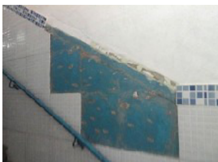
Queda de revestimento – acesso ao 2º andar
