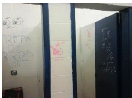
Pichações – banheiro masculino térreo
