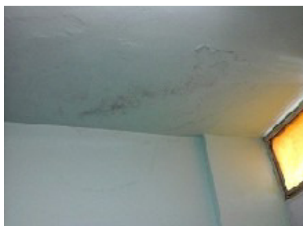
Pintura desgastada decorrente de infiltração sanada, conforme informado pela Direção – sala 7
