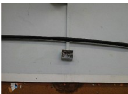
Fiação exposta – sala 7 (situação sinalizada desde 2014)
