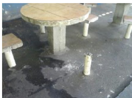
Banco danificado (situação sinalizada em 2015)
