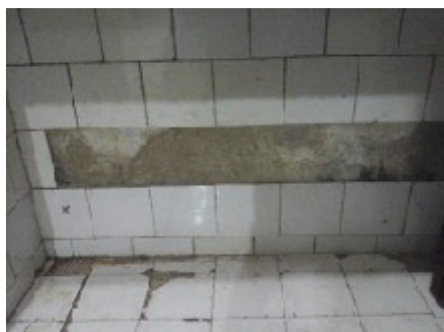
Revestimento danificado (situação sinalizada em 2015)
