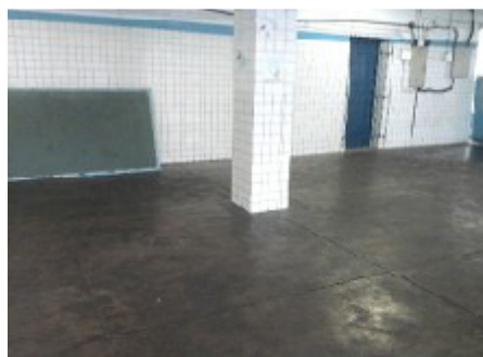
Ausência de extintor de incêndio no corredor - térreo (situação sinalizada em 2015)
