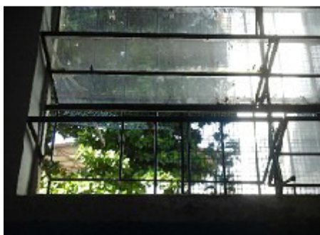
Ausência de vidro no basculante e grade de proteção danificada - sala 7
