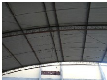
Ferro da cobertura da quadra solto (situação sinalizada desde 2014)
