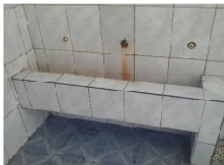
Mictório danificado – banheiro masculino prédio principal
