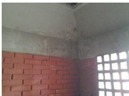
Pintura desgastada decorrente de infiltração sanada, conforme informado pela Direção – corredor próximo à sala 3
