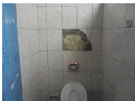
Queda de revestimento - banheiro feminino (situação sinalizada em 2015)
