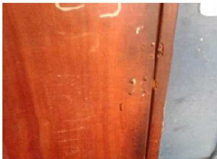
Ausência de maçaneta na porta – todas as salas (situação sinalizada em 2015)
