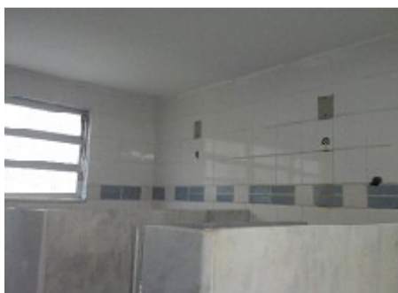
Ausência de chuveiro em todos os boxes – vestiário masculino
