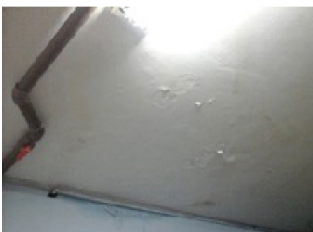
Pintura desgastada decorrente de infiltração sanada, conforme informado pela Direção – térreo próximo ao banheiro (situação sinalizada em 2015)
