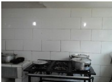
Ausência de coifa (situação sinalizada desde 2013)
