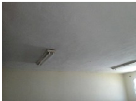
Lâmpadas ausentes/queimadas – diversas salas
