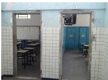
Ausência de acabamento nas portas – diversas salas (situação sinalizada em 2015)
