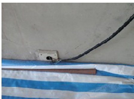
Fiação exposta – sala de judô
