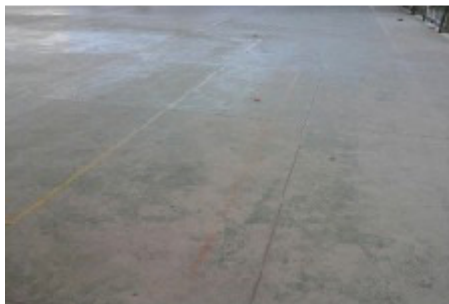
Piso com marcação desgastada (situação sinalizada em 2015)
