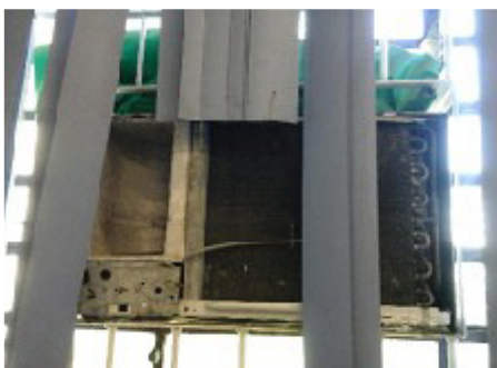
Aparelho de ar-condicionado danificado
