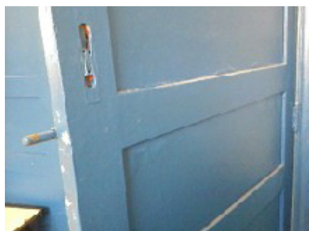
Ausência de maçaneta na porta – diversas salas (situação sinalizada em 2015)
