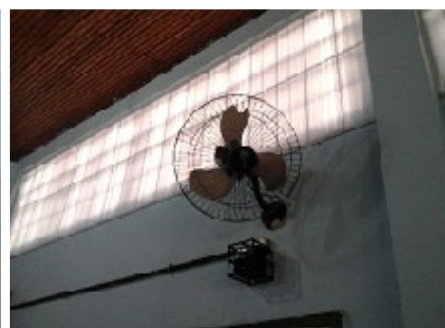
Ventilador com defeito – sala 5
