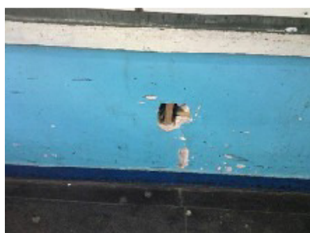
Fiação exposta – sala 4
