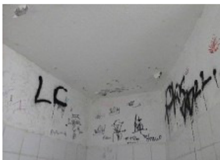
Pichações – vestiário masculino (situação sinalizada em 2015)
