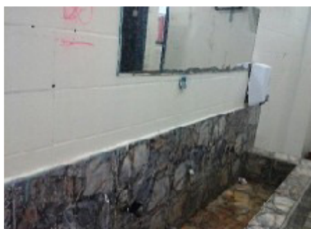
Ausência de torneira – banheiros masculino e feminino térreo
