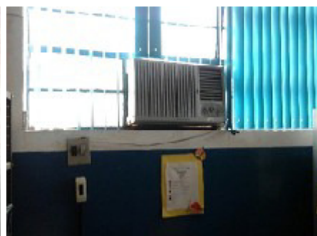
Único aparelho de ar-condicionado existente com defeito – sala de leitura (situação sinalizada em 2015)
