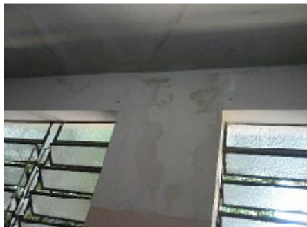
Infiltração – sala 13 (situação sinalizada em 2015)
