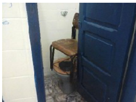
Boxes interditados (3 boxes) - banheiro masculino térreo
