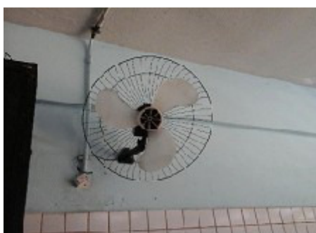
Ausência de grade de proteção no ventilador – sala 1 prédio principal
