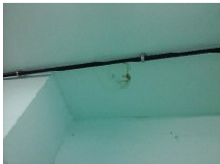
Pintura desgastada decorrente de infiltração sanada, conforme informado pela Direção – sala 20
