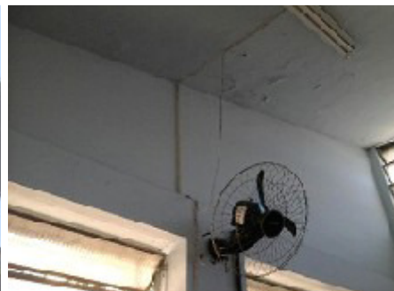
Fiação exposta – sala 7
