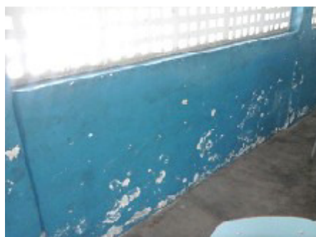
Pintura desgastada – corredor prédio anexo
