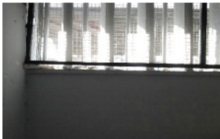
Ausência de tela de proteção milimétrica em parte da janela - área de freezers
