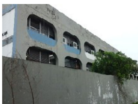
Pintura desgastada – área externa
