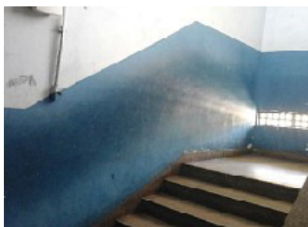
Pintura desgastada - acesso ao corredor das salas 11 a 17 (situação sinalizada em 2015)
