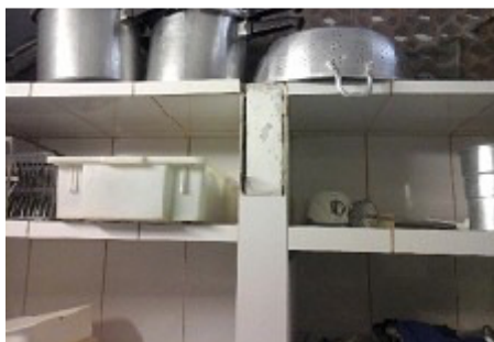
Queda de revestimento
