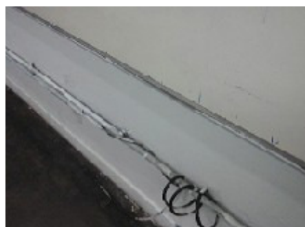
Canaleta danificada – sala 10
