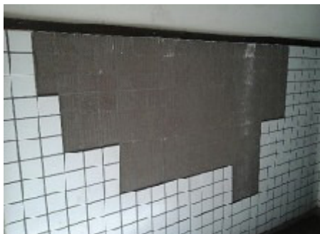
Queda de revestimento – térreo prédio anexo 2
