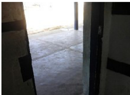
Ausência de porta – sala 5
