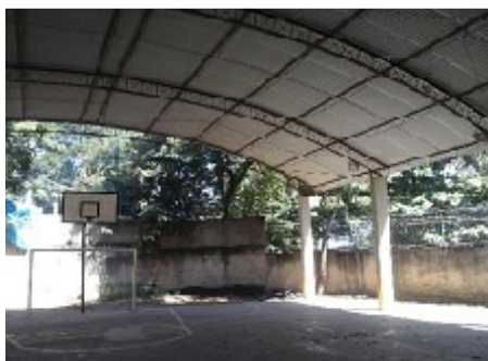
Ausência de tela de proteção (situação sinalizada desde 2012)
