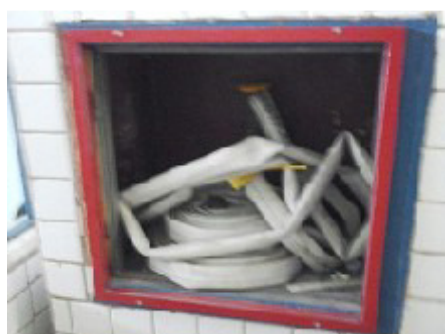
Ausência de porta no compartimento de mangueira de combate a incêndio – 3º andar
