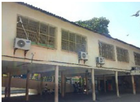
Pintura desgastada - área externa prédio principal (situação sinalizada em 2015)
