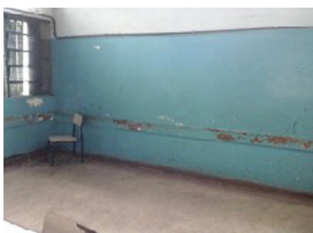
Pintura desgastada – diversas salas (situação sinalizada desde 2013)
