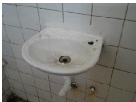
Pia danificada - vestiário masculino
