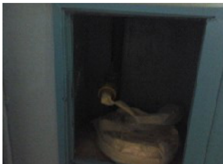
Registro da tubulação da mangueira de combate a incêndio danificada – todos os andares (situação sinalizada desde 2014)
