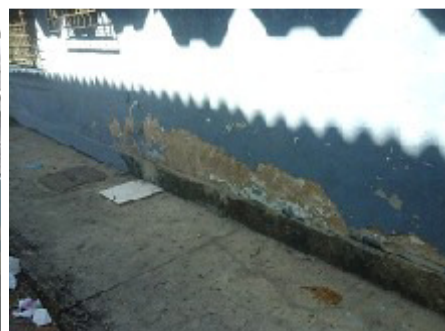
Queda de reboco - área externa prédio anexo (situação sinalizada em 2015)
