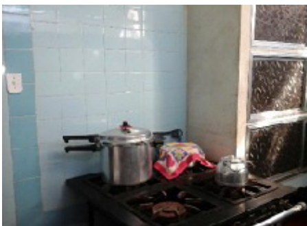
Ausência de coifa (situação sinalizada em 2015)
