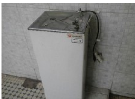
Bebedouro com defeito – corredor 1º andar prédio principal (situação sinalizada em 2015)
