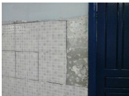
Queda de revestimento – entrada da sala 5
