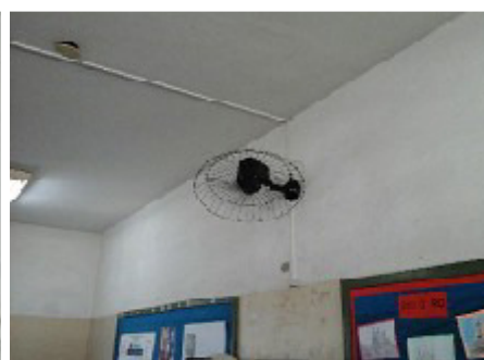
Ausência de grade de proteção no ventilador – diversas salas
