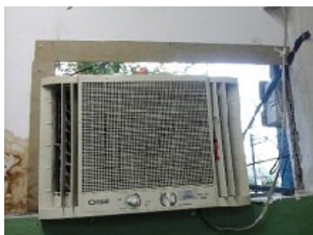
Ausência de vedação ao redor do aparelho de ar-condicionado - sala 5
