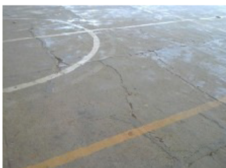
Piso danificado (situação sinalizada desde 2012)
