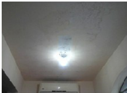
Pintura desgastada decorrente de infiltração sanada, conforme informado pela Direção. Situação sinalizada em 2014.
