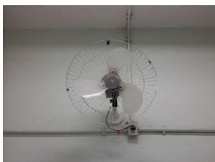
Ausência de grade de proteção no ventilador – auditório e salas 1, 2, 4, 5 e 8
