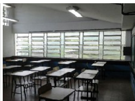
Ausência de aparelho de ar-condicionado – sala 2
