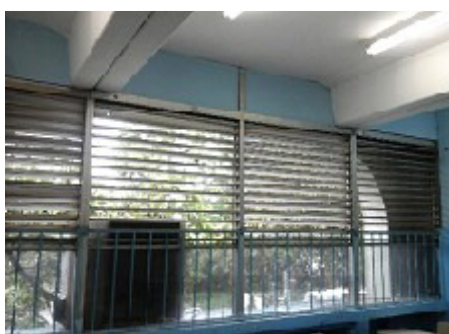
Ausência de grade/tela de proteção em parte da janela – diversas salas
