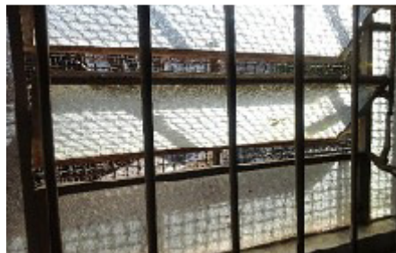
Ausência de tela de proteção milimétrica - despensa de alimentos (situação sinalizada em 2012 e 2015)
