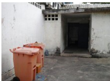
Vestiários desativados (situação sinalizada desde 2013)
