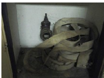
Mangueira de combate a incêndio danificada – térreo
