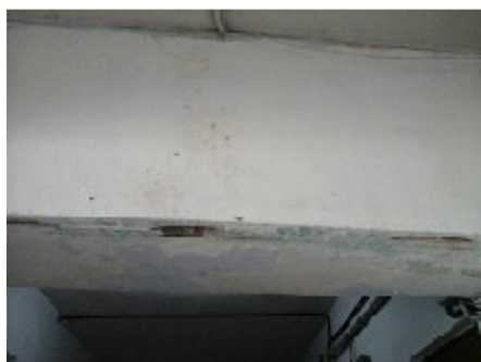
Infiltração e queda de reboco – térreo próximo ao refeitório
