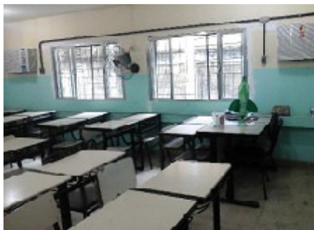
Aparelhos de ar-condicionado desligados devido à necessidade de aumento de carga elétrica, conforme informado pela Direção – todas as salas de aula
