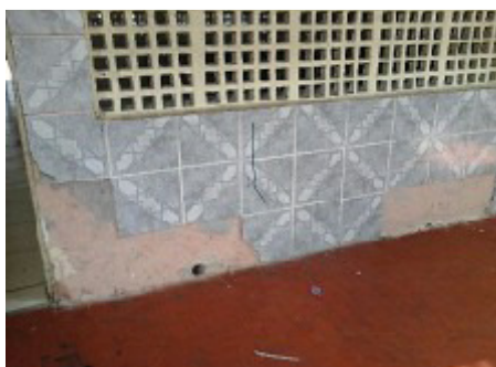
Queda de revestimento – entrada do refeitório (situação sinalizada em 2015)
