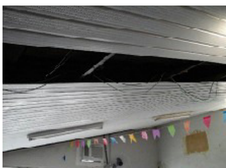
Fiação exposta – sala 10
