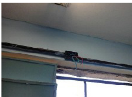
Fiação da distribuição elétrica interna para uso dos aparelhos de ar-condicionado exposta – sala 3
