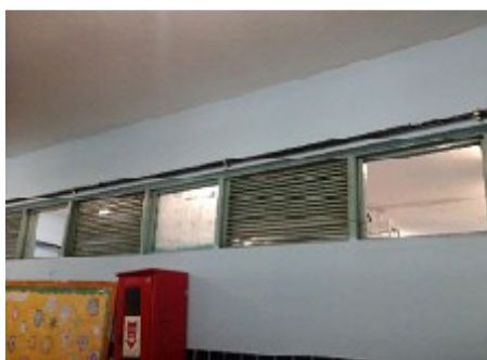
Ausência de vidro – corredor 1º andar (situação sinalizada em 2015)
