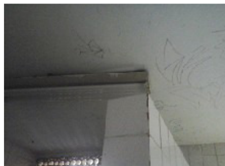
Lâmpadas queimadas - vestiário 1
