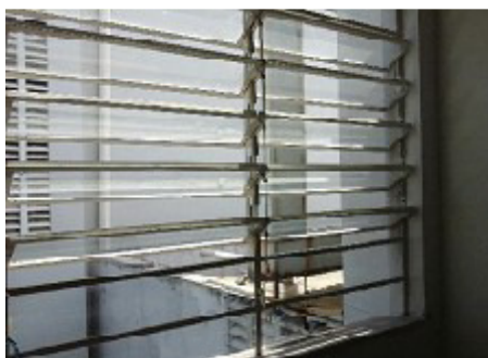
Ausência de grade/tela de proteção – salas 3, 4, 7 a 10, laboratórios de ciências e de informática. Situação sinalizada em 2014.
