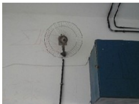
Ausência de grade de proteção no ventilador – salas 1 e 4
