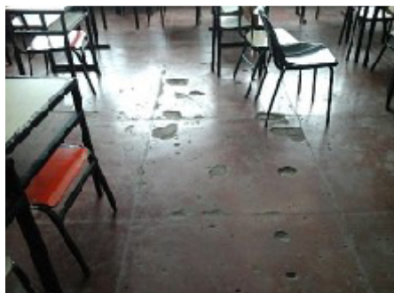
Piso danificado – salas do 1º andar (situação sinalizada desde 2012)
