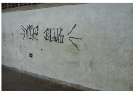
Pintura desgastada e pichações – entrada dos vestiários
