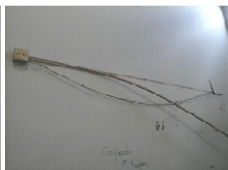
Canaleta danificada com fiação exposta – sala 1
