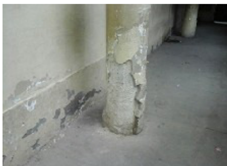
Queda de reboco – coluna fachada principal (situação sinalizada em 2015)
