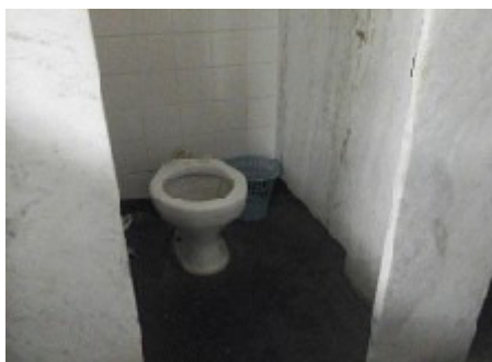
Ausência de assento sanitário (4 boxes) – vestiário feminino
