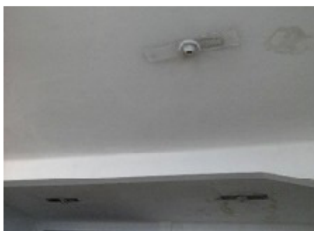
Ausência de lâmpadas – sala de leitura
