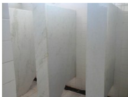
Ausência de porta em todos os boxes de chuveiro - vestiários masculino e feminino (situação sinalizada em 2015)
