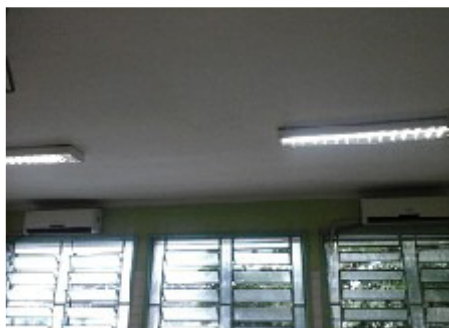
Necessidade de manutenção nos aparelhos de ar-condicionado – sala 10 (situação sinalizada em 2015)
