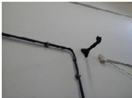
Ausência de 1 ventilador – sala 1
