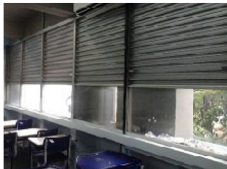
Ausência de grade/tela de proteção – sala 10
