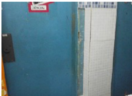
Queda de revestimento – entrada da sala 8
