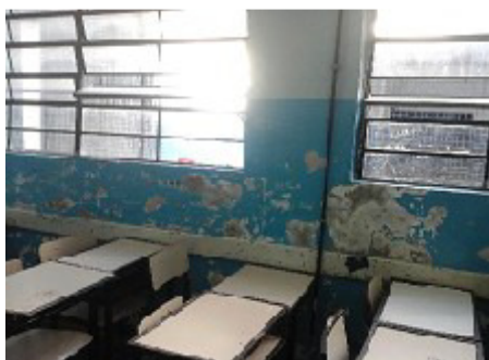
Queda de reboco - sala 6 (situação sinalizada em 2015)
