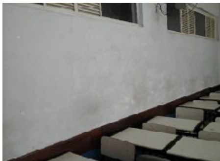
Pintura desgastada – diversas salas
