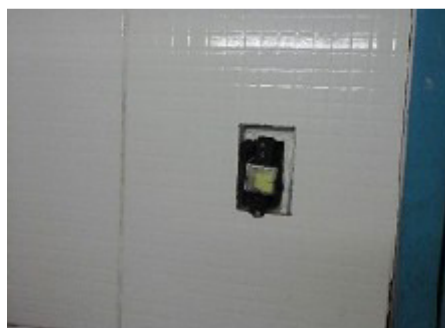
Interruptor danificado – banheiro feminino 1º andar
