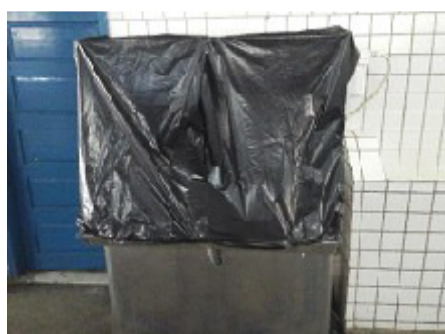
Bebedouro interditado devido a entupimento – térreo
