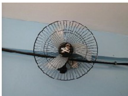
Ventilador com defeito – salas 9 e 11 e sala de leitura
