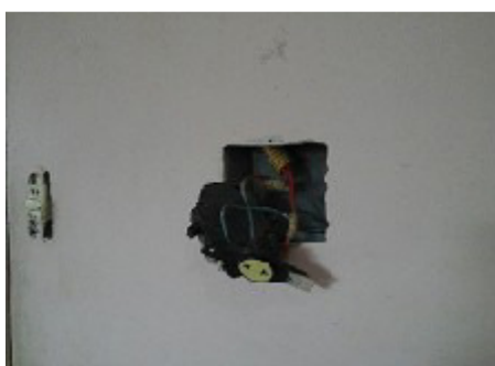
Fiação exposta – sala de vídeo
