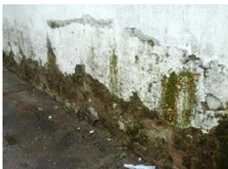
Infiltração - área externa próximo à cozinha
