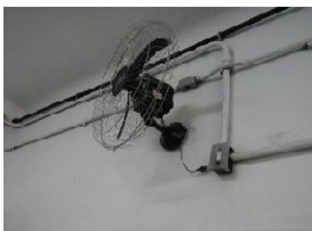
Ventilador com defeito – salas 8 e 12 e sala de recursos
