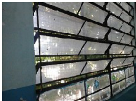
Basculantes não fecham completamente – diversas salas (situação sinalizada em 2015)
