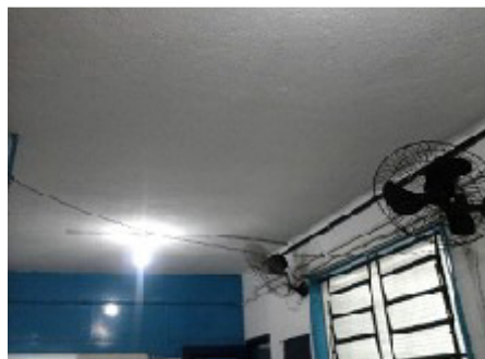
Fiação exposta – sala 11
