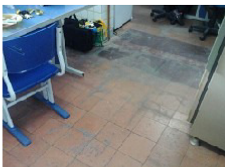
Piso danificado – sala dos professores
