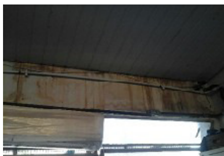
Pintura desgastada decorrente de infiltração sanada, conforme informado pela Direção – sala 1
