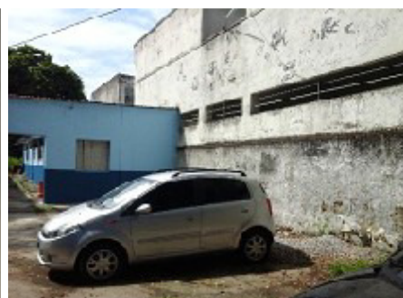
Pichações – área externa (situação sinalizada desde 2014)
