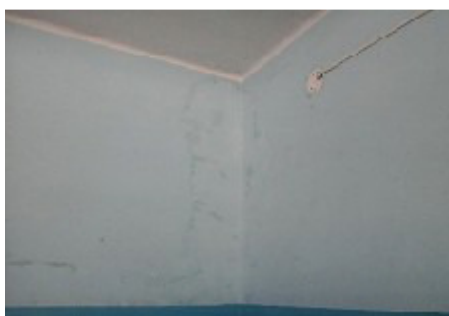
Pintura desgastada decorrente de infiltração sanada, conforme informado pela Direção – sala 15 (situação sinalizada em 2015)
