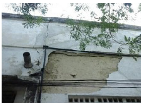
Rachadura e queda de reboco – área externa
