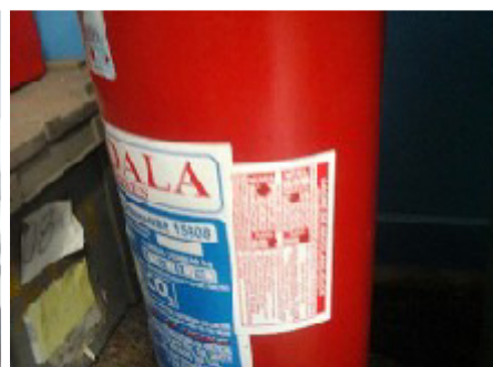
Extintores de incêndio vencidos
