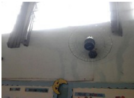
Infiltração - sala 5 (situação sinalizada em 2015)
