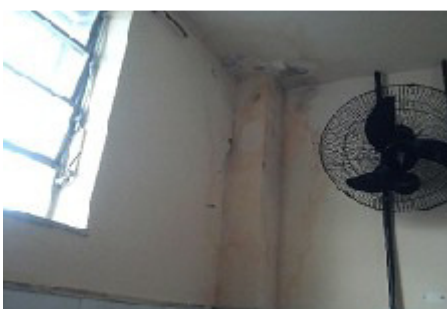
Infiltração decorrente de problemas no telhado, conforme informado pela Direção – sala da Coordenação
