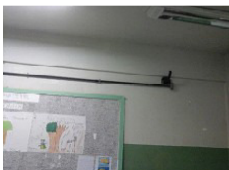
Ausência de 1 ventilador – sala 4
