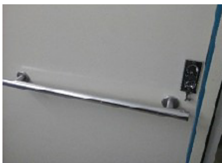
Ausência de maçaneta do tipo alavanca – banheiro para portador de necessidades especiais
