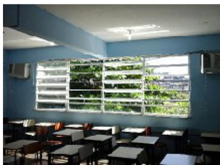
Aparelhos de ar-condicionado desligados devido à necessidade de revisão da parte elétrica (redistribuição interna e aumento de carga elétrica), conforme informado pela Direção – salas 4, 5, 6, 7, 8, 10, 11 e 12
