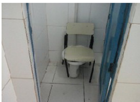
Boxe interditado – banheiro feminino 1º andar
