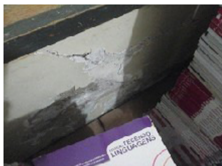
Queda de reboco – sala 12 (situação sinalizada em 2015)
