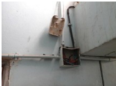
Fiação exposta – corredor 1º andar
