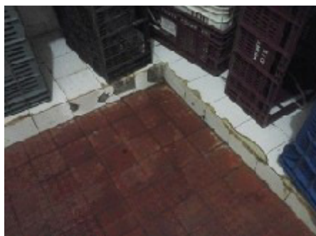
Queda de revestimento
