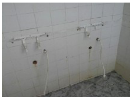
Ausência de pias – vestiário feminino
