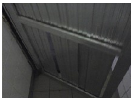
Porta danificada – entrada do banheiro feminino subsolo
