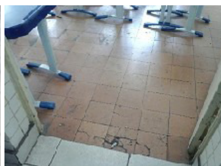
Piso danificado – sala 10
