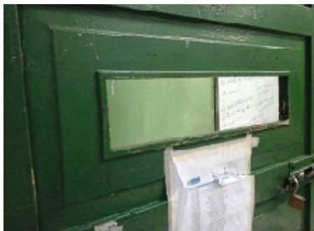
Ausência de vedação nas portas (ambientes climatizados) - diversas salas
