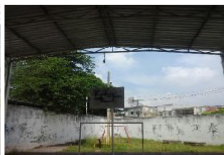
Ausência de tela de proteção (situação sinalizada desde 2014)
