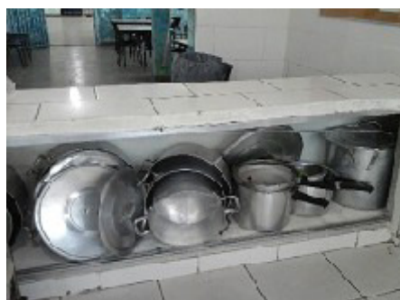
Queda de revestimento (situação sinalizada em 2015)
