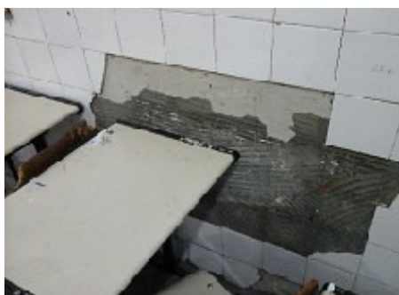
Queda de revestimento – sala 12 (situação sinalizada desde 2013)
