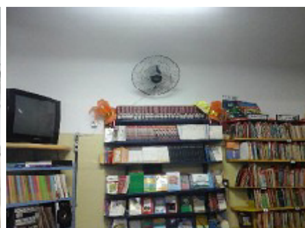
Ventilador com defeito – sala de leitura
