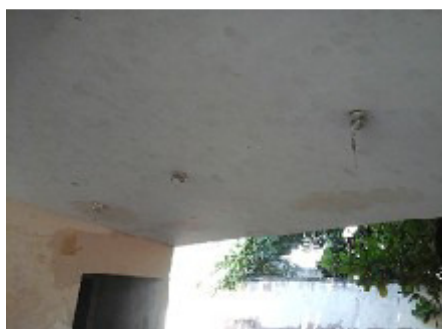
Lâmpadas ausentes/queimadas (situação sinalizada desde 2014)
