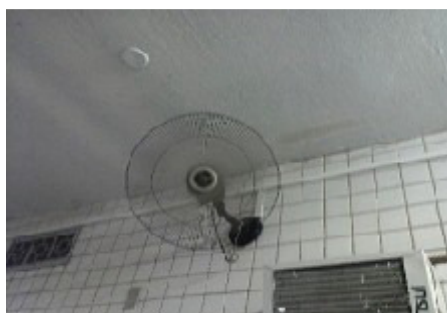
Ausência de grade de proteção no ventilador
