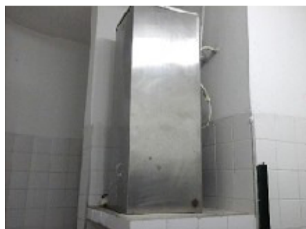
Aparelho para gelar água do bebedouro desativado guardado no banheiro feminino térreo (situação sinalizada em 2015)
