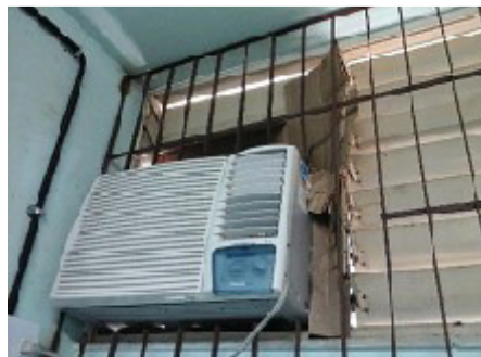
Basculante danificado – sala da Educação Infantil
