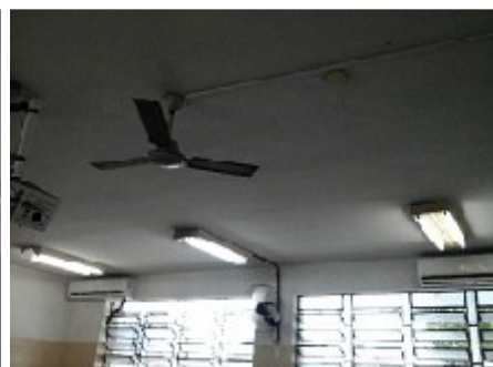
Aparelhos de ar-condicionado desligados devido à necessidade de aumento da carga elétrica (situação sinalizada em 2015) e de redistribuição elétrica interna, conforme informado pela Direção - diversas salas
