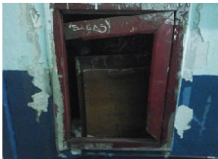
Ausência de mangueira de combate a incêndio e compartimento danificado – 2º andar (situação sinalizada em 2015)
