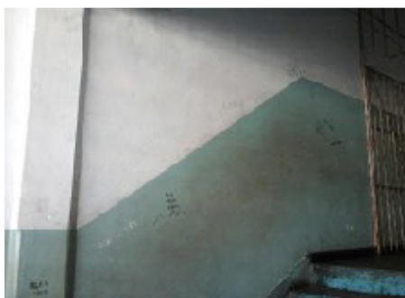
Pintura desgastada e pichações – acessos aos andares
