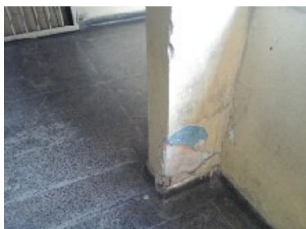
Queda de reboco – corredor 1º andar
