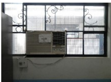
Aparelho de ar-condicionado com defeito – sala 24 (antiga sala 25). Situação sinalizada em 2015.
