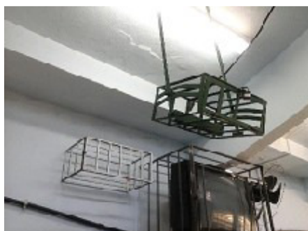
Ausência de projetor – sala 7 (situação sinalizada em 2015)
