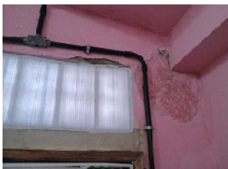
Infiltração – sala 6 (situação sinalizada em 2015)
