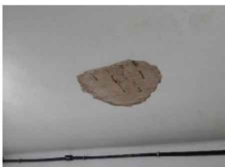
Queda de reboco com ferragem exposta – sala 7 (situação sinalizada em 2015)
