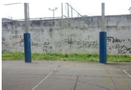
Ausência de alambrado (situação sinalizada desde 2014)
