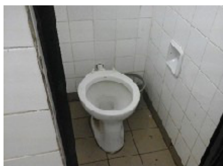
Ausência de assento sanitário em todos boxes – banheiro feminino subsolo
