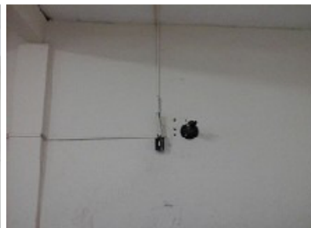
Ausência de 1 ventilador – sala 15
