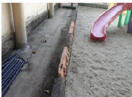
Mureta danificada apresentando inclinação - lateral ao parquinho (situação sinalizada em 2015)
