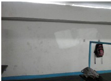
Pintura desgastada – vestiário feminino
