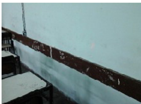
Pintura desgastada – diversas salas (situação sinalizada desde 2014)
