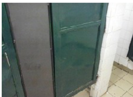
Boxe interditado - banheiro feminino subsolo
