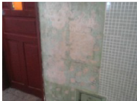
Queda de revestimento – corredor 1º andar
