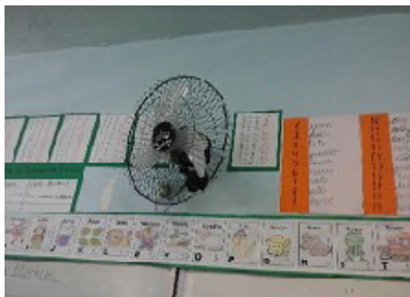
Ventilador com defeito – sala 3 prédio anexo
