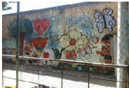
Alambrado danificado (situação sinalizada em 2015)
