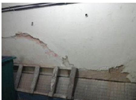
Infiltração com queda de reboco – corredor subsolo
