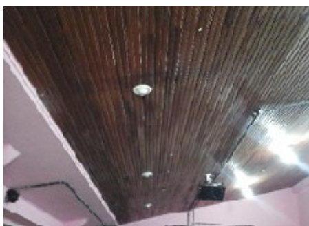
Lâmpadas ausentes/queimadas – diversas salas
