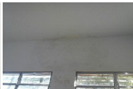
Pintura desgastada decorrente de infiltração sanada, conforme informado pela Direção – sala 3
