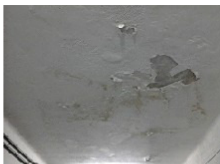
Pintura desgastada decorrente de infiltração sanada, conforme informado pela Direção – corredor 1º andar (situação sinalizada em 2015)
