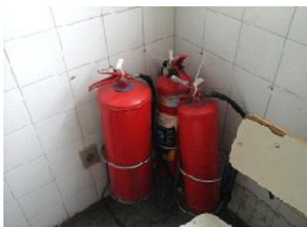
Extintores de incêndio armazenados num mesmo local (sala do núcleo). Situação sinalizada em 2015.
