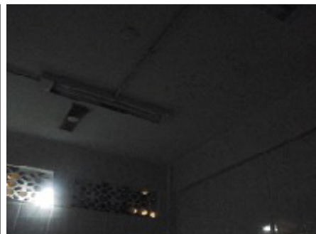
Ausência de iluminação – banheiro masculino
