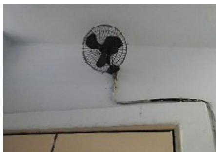
Ventilador com defeito
