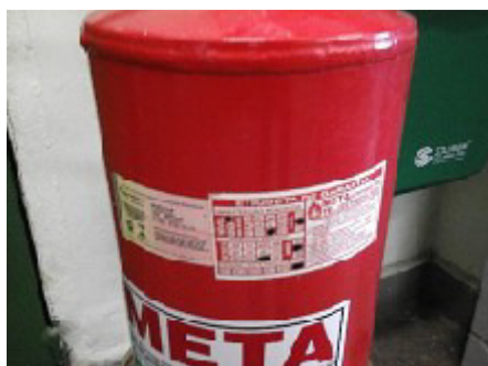
Extintores de incêndio vencidos
