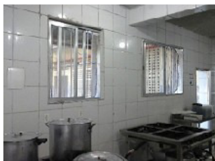
Ausência de coifa (situação sinalizada desde 2014)
