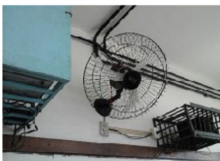
Único ventilador existente com defeito – sala 9
