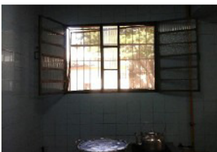
Ausência de coifa (situação sinalizada desde 2014)
