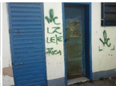
Vestiários desativados (situação sinalizada em 2015)
