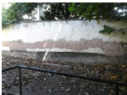
Queda de reboco – muro próximo à quadra (situação sinalizada desde 2014)
