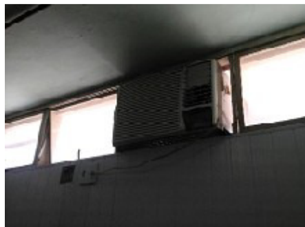
Vazamento de água oriunda do aparelho de ar-condicionado – sala 10
