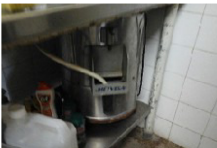
Ausência de instalações hidráulicas para uso do descascador, conforme informado pela Direção.
