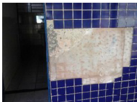
Queda de revestimento – entrada do banheiro feminino (situação sinalizada em 2015)
