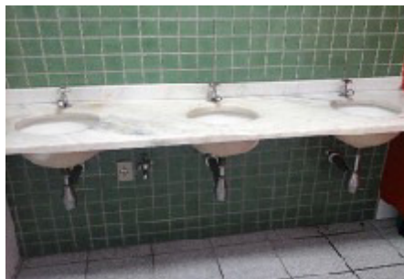
Ausência de lavatório adaptado para portadores de necessidades especiais – banheiros masculino e feminino 2º andar
