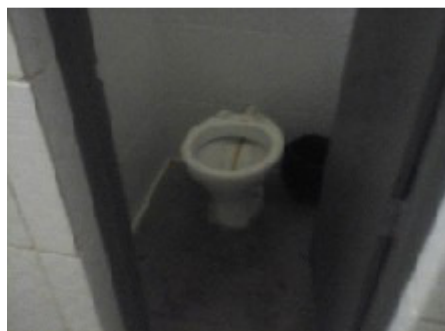
Ausência de assento sanitário (1 boxe) – banheiro feminino
