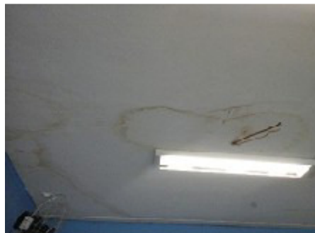
Infiltração recorrente (situação sinalizada em 2015) – sala 16
