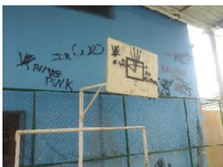
Equipamentos danificados (tabelas de basquete). Situação sinalizada desde 2014.
