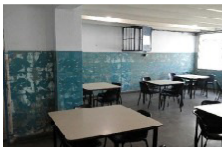
Ausência de revestimento
