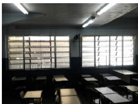
Ausência de aparelho de ar-condicionado – salas 3 a 11 e 15 a 16 (situação sinalizada em 2015)
