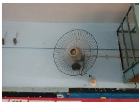
Ausência de grade de proteção no ventilador – salas 2, 4 e 9
