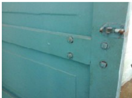
Ausência de maçaneta na porta – salas 3º andar
