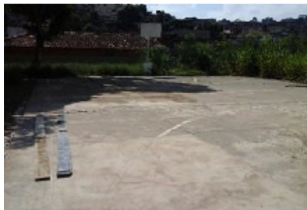
Quadra descoberta com piso precário - 2ª quadra (situação sinalizada desde 2012)
