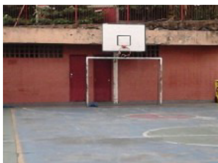
Equipamentos danificados (tabelas de basquete)
