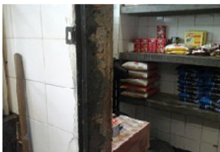
Queda de revestimento
