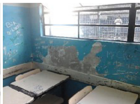
Queda de reboco – sala 5 (situação sinalizada em 2015)
