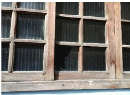
Vidro danificado na janela – antiga sala do projeto cidadão mirim (situação sinalizada em 2015)
