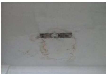
Pintura desgastada decorrente de infiltração sanada, conforme informado pela Direção – sala de leitura
