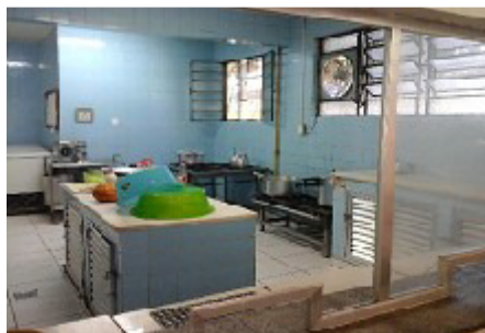
Ausência de vidro no passa prato
