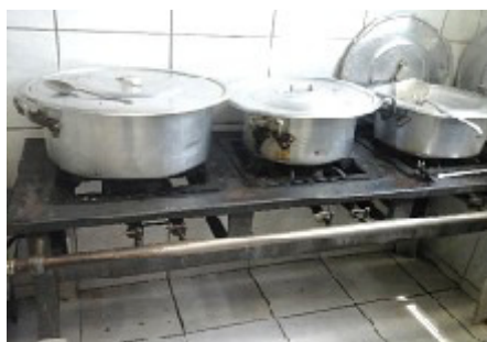
Necessidade de manutenção do fogão
