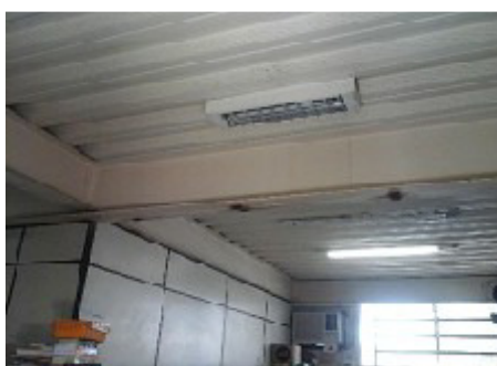
Lâmpadas queimadas – sala de leitura
