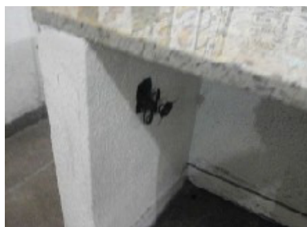
Fiação exposta – bancada da sala de artes (situação sinalizada em 2015)
