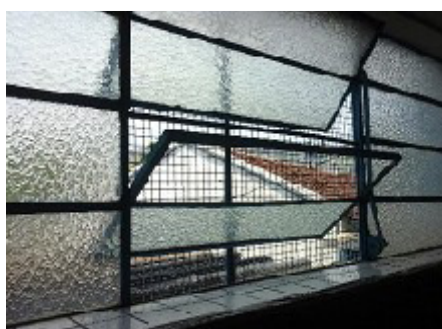
Ausência de vidro no basculante – acesso ao 1º andar
