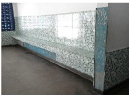
Queda de revestimento – corredor térreo
