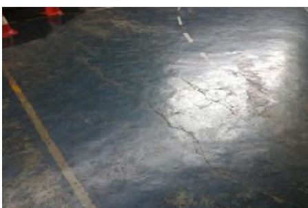
Piso danificado (situação sinalizada desde 2014)
