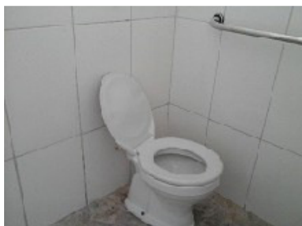
Ausência de barra de apoio junto à bacia sanitária no fundo (boxe para portador de necessidades especiais) – banheiro feminino prédio principal
