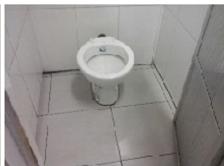
Ausência de assento sanitário (1 boxe) – banheiros masculino e feminino
