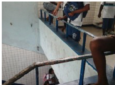
Ausência de grade/tela de proteção – corredor 1º andar
