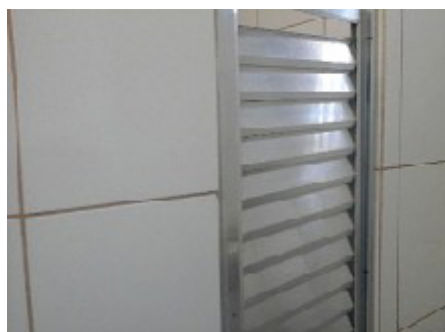
Boxe desativado – banheiro masculino térreo
