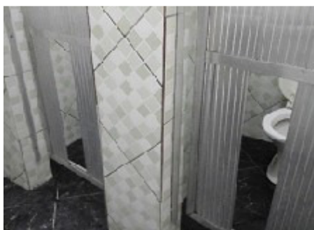
Porta danificada (2 boxes) – banheiro masculino
