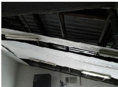
Forro danificado – diversas salas (situação sinalizada desde 2014)
