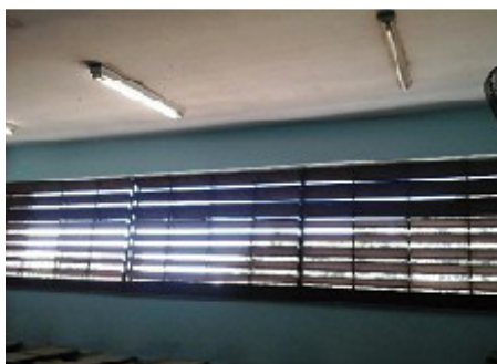
Ausência de aparelho de ar-condicionado – todas as salas de aula (situação sinalizada em 2015)
