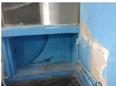
Pintura desgastada decorrente de infiltração (oriunda da condensadora) sanada, conforme informado pela Direção – sala 9
