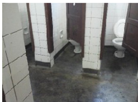
Portas dos boxes com altura inadequada (situação sinalizada em 2014) - banheiro masculino térreo
