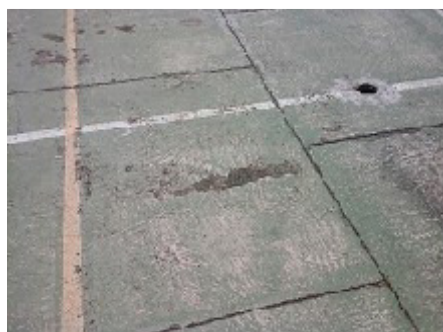
Piso danificado (situação sinalizada desde 2014)
