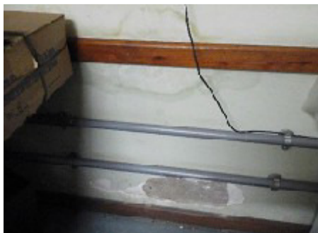
Infiltração com queda de reboco (situação sinalizada em 2015)
