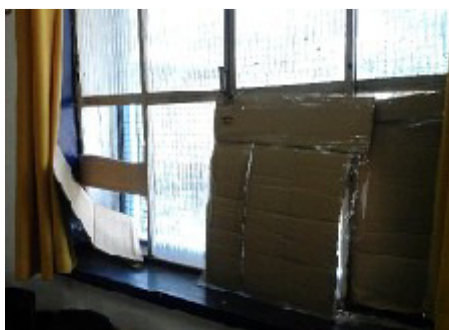
Vidro danificado na janela – auditório (situação sinalizada em 2015)
