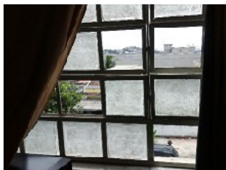
Vidros danificados/ausentes no basculante
