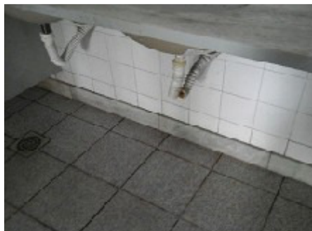
Tubulação danificada – vestiário masculino
