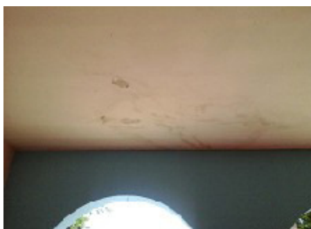
Pintura desgastada decorrente de infiltração sanada, conforme informado pela Direção – pátio (situação sinalizada desde 2013)
