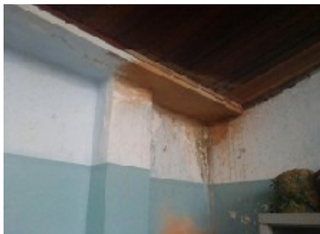
Ausência de acabamento (pintura) – sala 14
