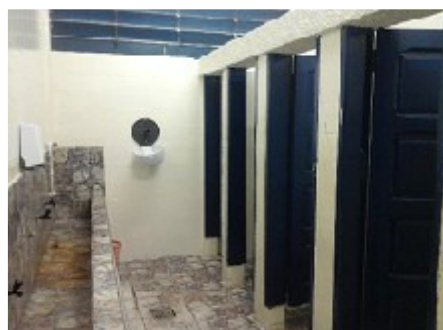
Ausência de banheiro adaptado para portadores de necessidades especiais
