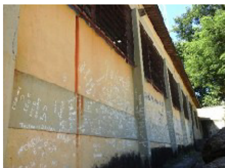
Pichações – área externa prédio anexo (situação sinalizada em 2015)
