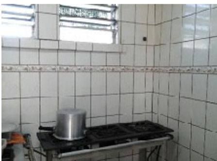
Ausência de coifa (situação sinalizada em 2015)
