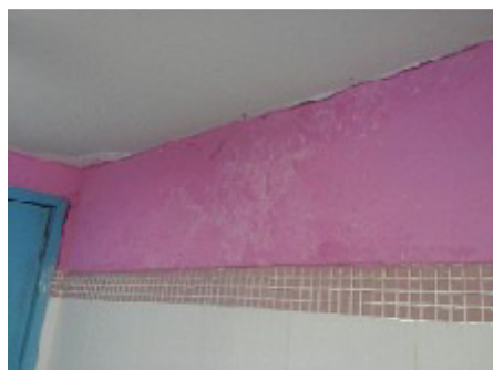
Infiltração – banheiro feminino
