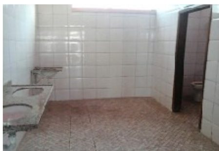
Ausência de banheiro adaptado para portadores de necessidades especiais
