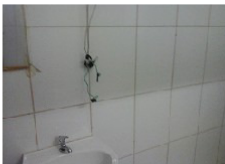
Fiação exposta - banheiro masculino próximo ao refeitório
