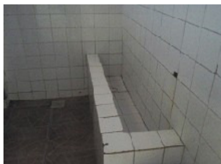
Mictório desativado (situação sinalizada desde 2014)
