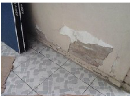
Queda de reboco – corredor de entrada do banheiro feminino
