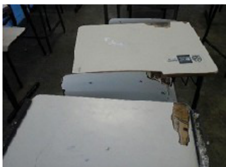
Mobiliário precário – salas do 2º andar
