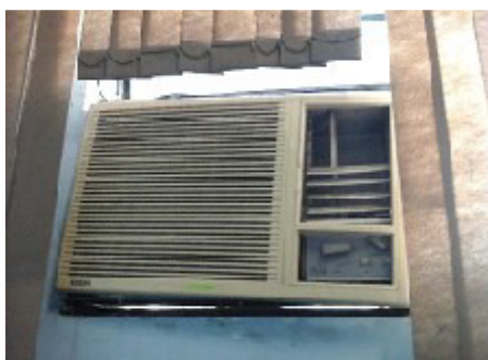
Único aparelho de ar-condicionado existente danificado – sala de vídeo
