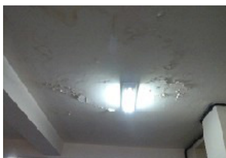
Infiltração decorrente de problemas no telhado, conforme informado pela Direção – corredor 1º andar
