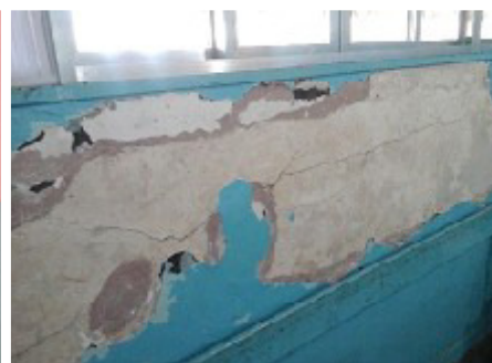
Queda de reboco – sala 7
