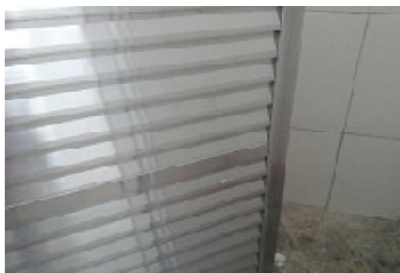
Ausência de maçaneta na porta (boxe para portador de necessidades especiais) – banheiro feminino prédio principal
