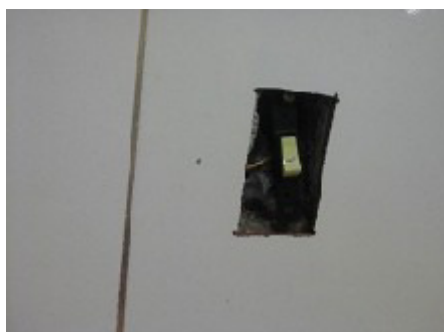
Fiação exposta – banheiro feminino 1º andar
