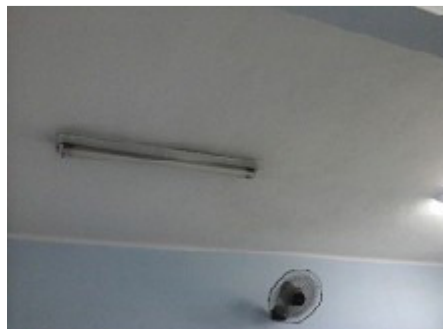
Lâmpadas queimadas – diversas salas
