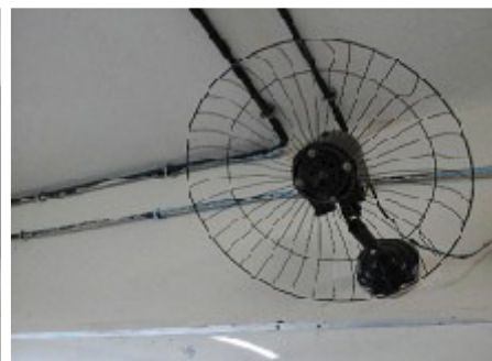
Ventilador danificado – sala 13
