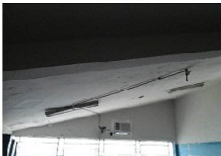
Lâmpadas e ventiladores desligados devido à necessidade de revisão da parte elétrica, conforme informado pela Direção – diversas salas
