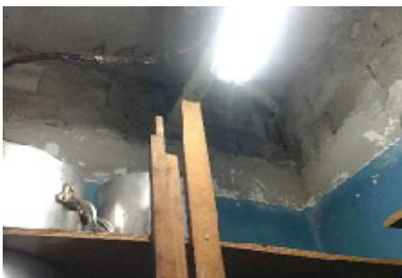
Ausência de forro - área para guarda de panelas
