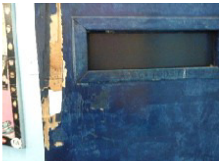
Porta danificada – salas 2 e 3
