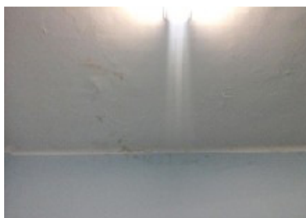
Pintura desgastada decorrente de infiltração sanada, conforme informado pela Direção – sala de vídeo
