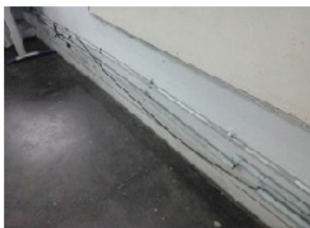
Canaleta danificada – sala 7
