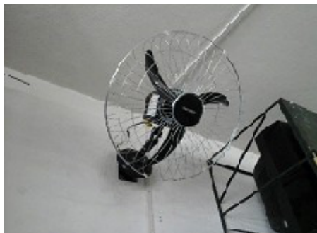
Ventilador com defeito – diversas salas
