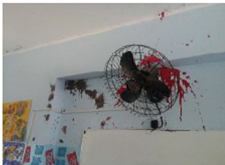
Pintura danificada por invasores, conforme informado pela Direção - sala de artes (situação sinalizada em 2015)
