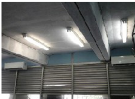
Todos os aparelhos de ar-condicionado com defeito – sala 9
