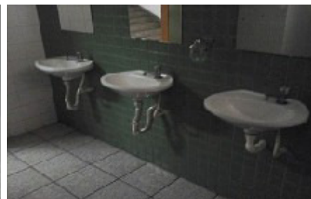
Ausência de lavatório adaptado para portador de necessidades especiais - banheiros masculino e feminino térreo
