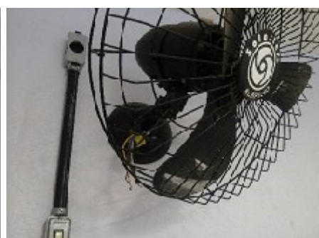
Único ventilador existente com defeito e com fiação exposta – laboratório de ciências
