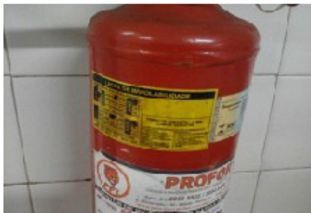
Extintor de incêndio vencido
