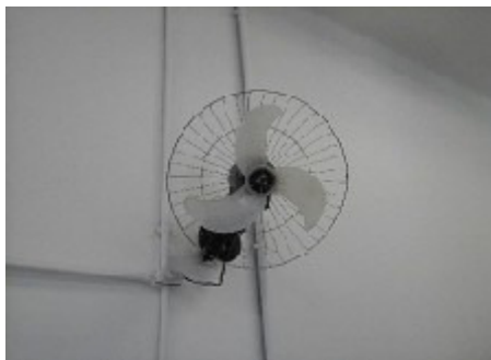
Ventilador com defeito – diversas salas e auditório
