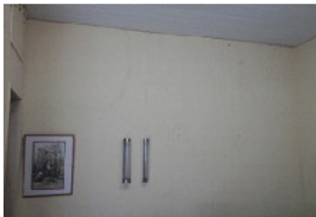
Infiltração – antiga sala de recursos (situação sinalizada em 2015)
