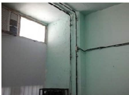
Infiltração – sala 10 (situação sinalizada desde 2013)
