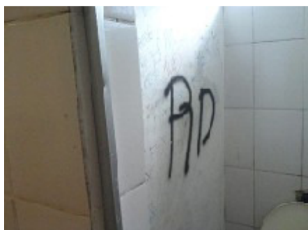
Pichações – banheiro masculino térreo próximo ao acesso ao 1º andar
