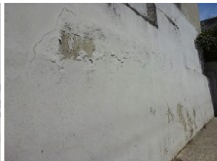
Pintura desgastada - área externa
