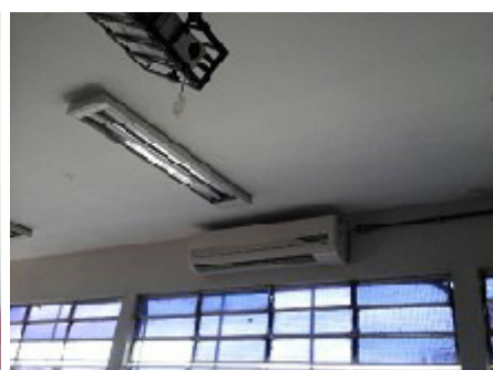
Único aparelho de ar-condicionado existente com defeito – salas 1, 9 e 10
