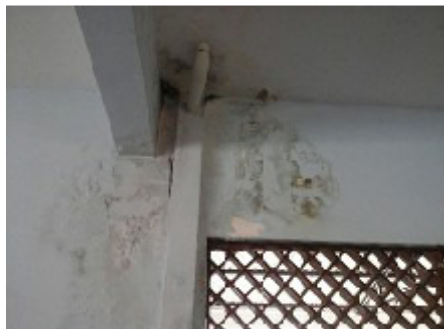
Infiltração (situação sinalizada em 2012 e 2015)
