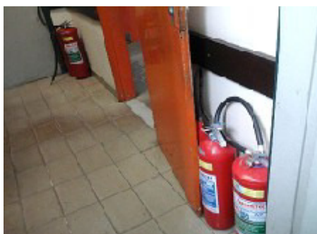
Extintores de incêndio armazenados num mesmo local (acesso à secretaria)
