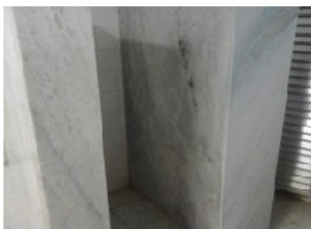
Ausência de porta (1 boxe de chuveiro) – vestiário masculino
