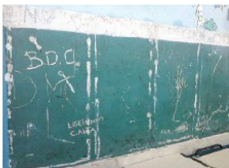
Pichações (situação sinalizada em 2015) e pintura desgastada – diversas salas
