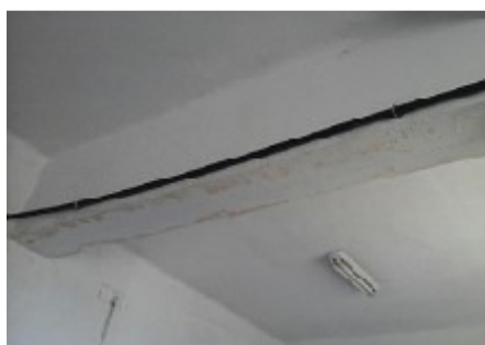
Pintura desgastada decorrente de infiltração sanada, conforme informado pela Direção – depósito 1º andar (antiga sala para guarda de livros). Situação sinalizada em 2015.
