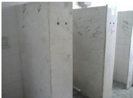
Ausência de porta em todos os boxes - vestiário feminino (situação sinalizada em 2015)
