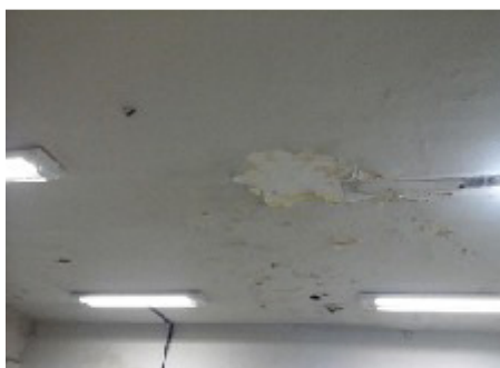
Pintura desgastada decorrente de infiltração sanada, conforme informado pela Direção – sala 12 (situação sinalizada em 2013 e 2014)
