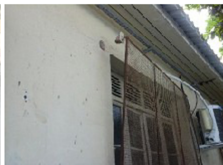
Gradeado danificado – área externa próximo às antigas salas de Educação Especial
