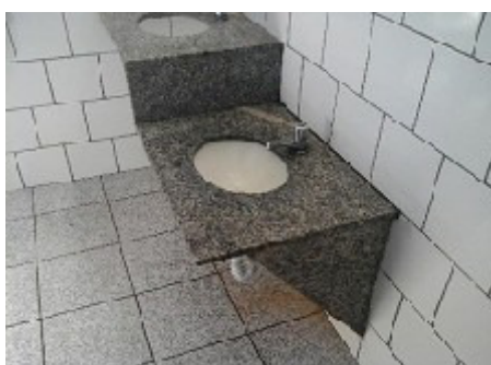
Ausência de lavatório adaptado para portadores de necessidades especiais – banheiros feminino e masculino térreo
