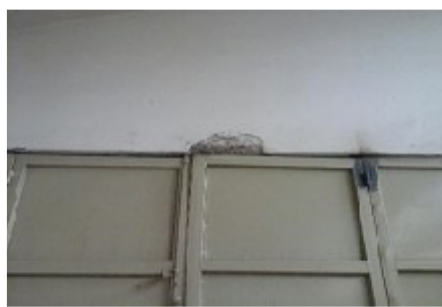
Queda de reboco
