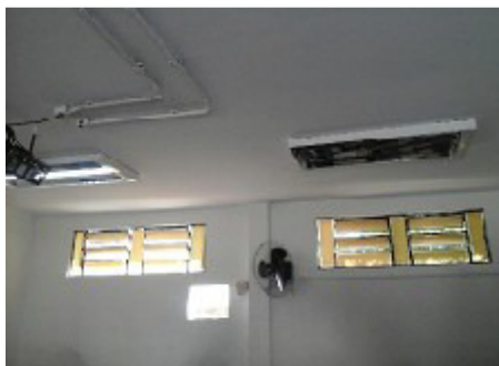
Ausência de aparelho de ar-condicionado – sala 12 (situação sinalizada em 2015)
