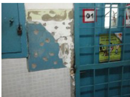
Queda de revestimento – entrada do laboratório de informática
