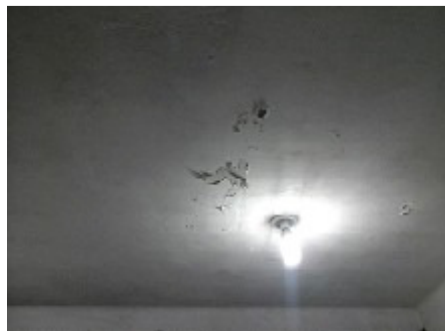
Pintura desgastada – sala 1
