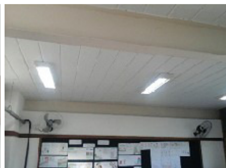
Ventilador com defeito – diversas salas
