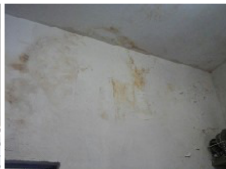
Infiltração (situação sinalizada em 2015)
