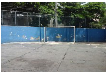
Ausência de equipamentos (tabelas de basquete). Situação sinalizada desde 2011.
