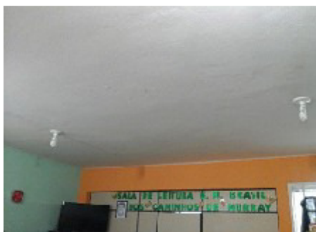
Lâmpadas queimadas – sala de leitura
