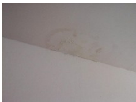
Pintura desgastada decorrente de infiltração sanada, conforme informado pela Direção – banheiro feminino 1º andar
