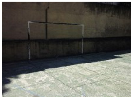
Ausência de equipamento (tabela de basquete). Situação sinalizada desde 2014.
