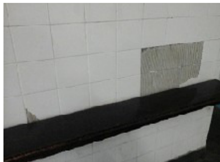
Queda de revestimento – vestiário feminino
