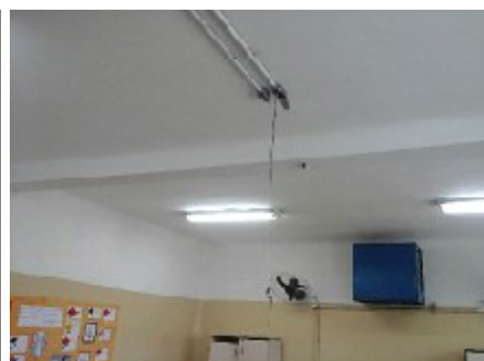
Fiação exposta - sala 8
