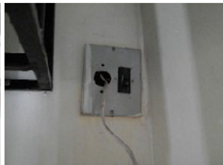
Fiação exposta no aparelho de ar-condicionado – sala 14
