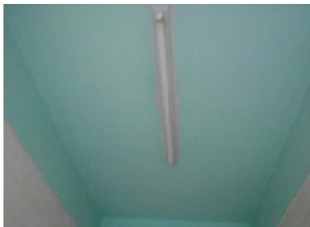
Lâmpada queimada – banheiro masculino térreo
