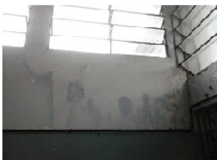
Infiltração - sala 8 (situação sinalizada em 2015)
