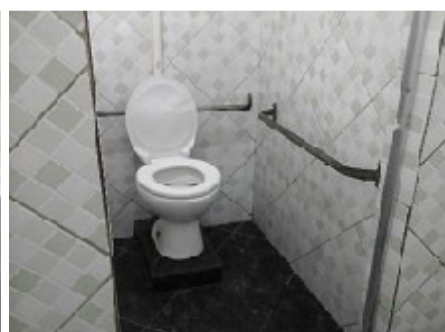
Ausência de porta (boxe para portador de necessidades especiais) – banheiro masculino
