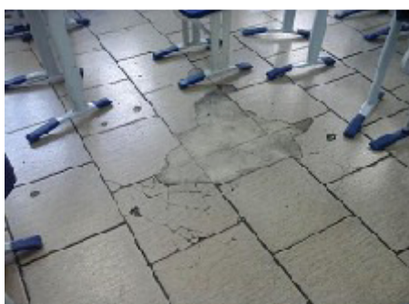
Piso danificado – sala 7
