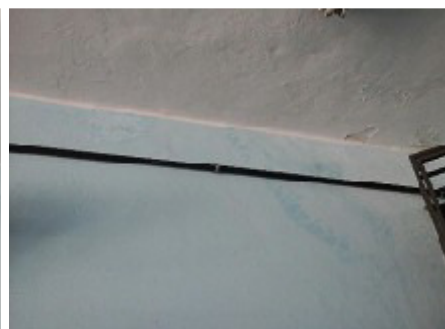
Pintura desgastada decorrente de infiltração sanada, conforme informado pela Direção – sala 12 (situação sinalizada em 2015)
