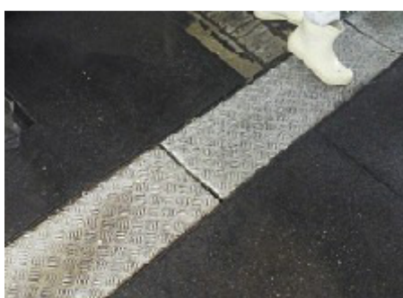
Placa do piso danificada
