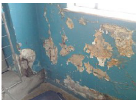
Queda de reboco – auditório (situação sinalizada em 2015)
