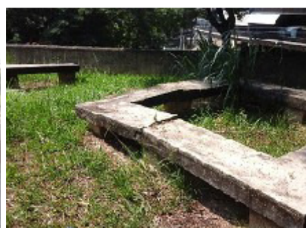
Banco danificado (situação sinalizada em 2015)
