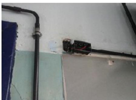
Fiação exposta – sala 10 (situação sinalizada em 2015)
