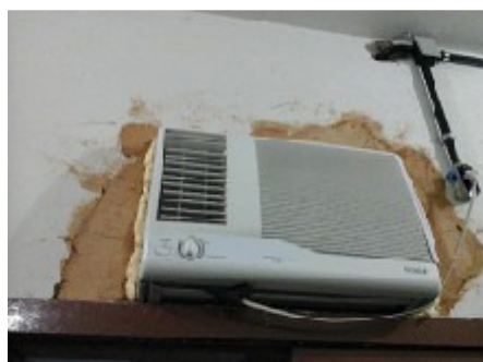
Ausência de acabamento – diversas salas (situação sinalizada em 2015)
