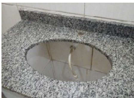
Ausência de cuba e de torneira na pia – banheiro feminino
