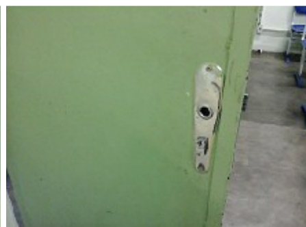
Ausência de maçaneta na porta – sala de vídeo
