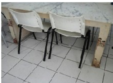
Queda de reboco (situação sinalizada em 2015)
