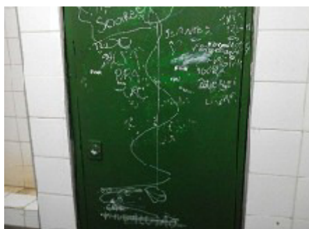
Boxe desativado (1 boxe de vaso sanitário) – vestiário feminino
