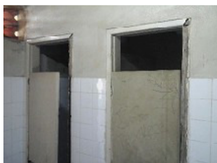
Portal danificado em todos os boxes – banheiro feminino do corredor
