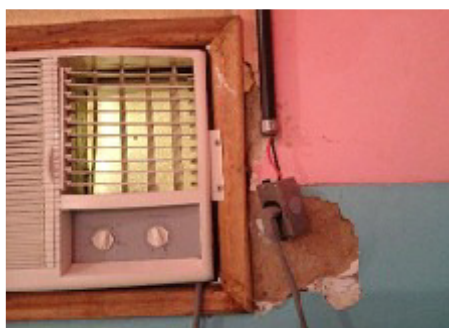
Queda de reboco e fiação exposta – sala 6
