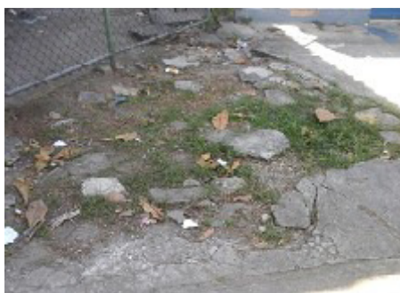
Piso danificado - área externa próximo à quadra
