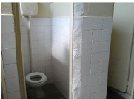
Ausência de acabamento – banheiro feminino 2º andar
