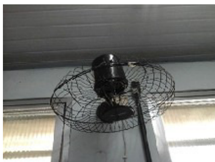
Ventilador danificado – salas 4, 9 e 11
