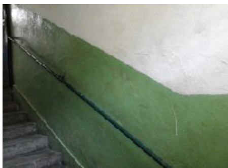
Pintura desgastada – acessos aos andares
