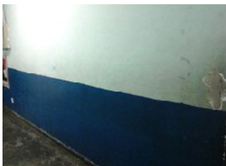
Pintura desgastada – corredores (situação sinalizada desde 2014)
