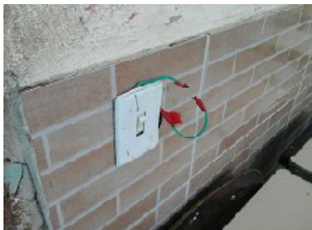
Fiação exposta – sala 16
