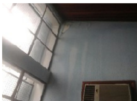
Infiltração - sala 13 (situação sinalizada em 2015)
