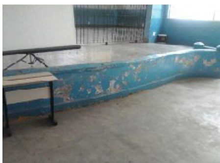
Pintura desgastada - auditório (situação sinalizada desde 2014)
