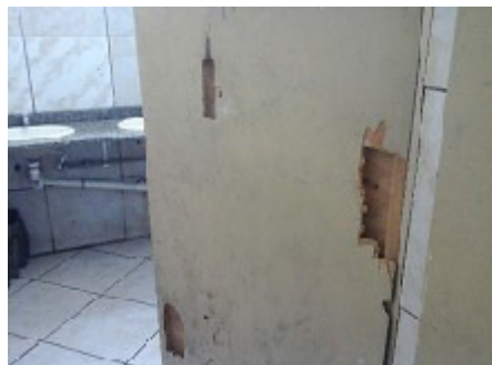
Porta danificada – banheiro masculino térreo
