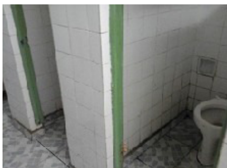
Ausência de porta (2 boxes) – banheiro masculino
