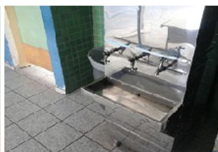
Bebedouro com defeito
