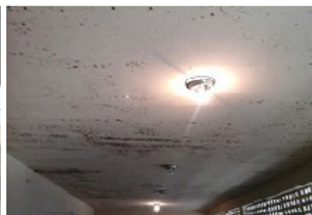
Infiltração decorrente de problemas na caixa d'água, conforme informado pela Direção – vestiário masculino
