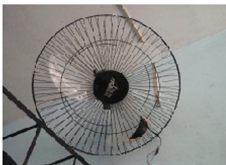
Fiação exposta no ventilador – sala 2 prédio anexo
