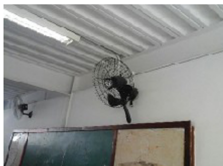
Ventilador danificado – sala 4
