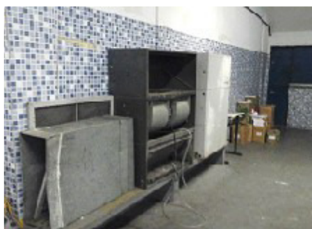
Material armazenado no corredor da Unidade – térreo próximo ao acesso ao 1º andar
