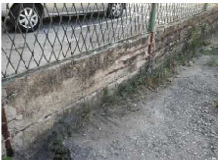
Alvenaria danificada - mureta entre prédios principal e anexo
