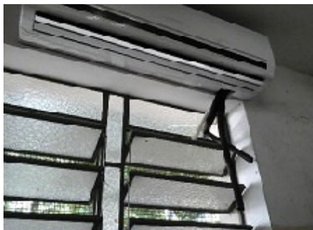
Todos os aparelhos de ar-condicionado com instalação danificada - sala 1 prédio principal
