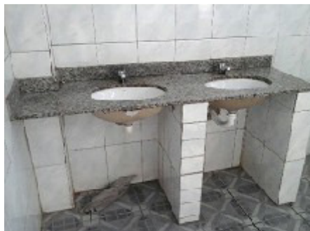
Ausência de lavatório adaptado para portadores de necessidades especiais – banheiro masculino prédio principal
