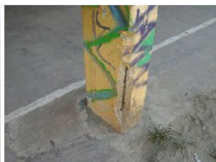
Diversas colunas de sustentação da cobertura com queda de reboco e ferragem exposta (situação sinalizada desde 2014)
