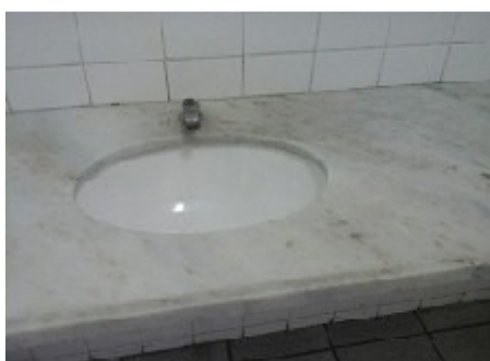
Torneira danificada - banheiro masculino prédio anexo 2
