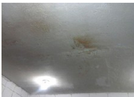
Pintura desgastada (situação sinalizada desde 2014)
