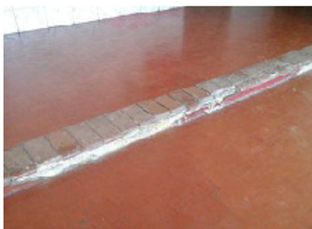
Piso danificado – pátio (situação sinalizada em 2015)
