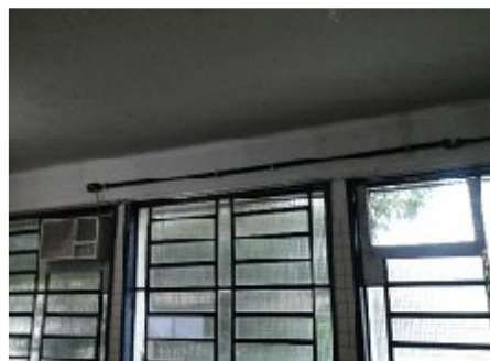
Ausência de 1 aparelho de ar-condicionado – salas 1 a 9, 11 e 12 (situação sinalizada em 2015).
