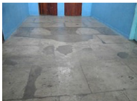
Piso danificado – corredor 1º andar (situação sinalizada desde 2014)
