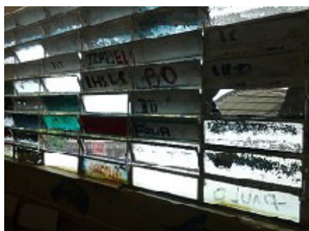
Vidros danificados/ausentes no basculante – diversas salas
