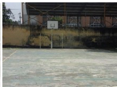
Pintura desgastada - muro (situação sinalizada em 2013)
