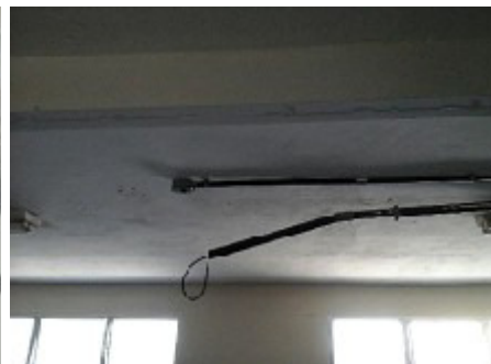
Canaleta danificada e com fiação exposta – sala 17
