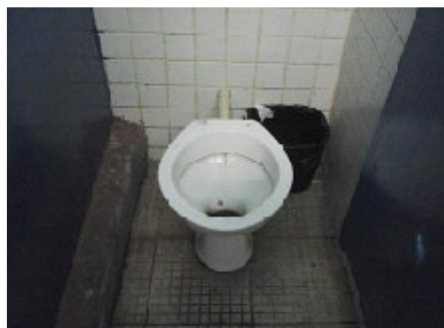
Ausência de assento sanitário no único boxe existente – banheiro feminino prédio anexo
