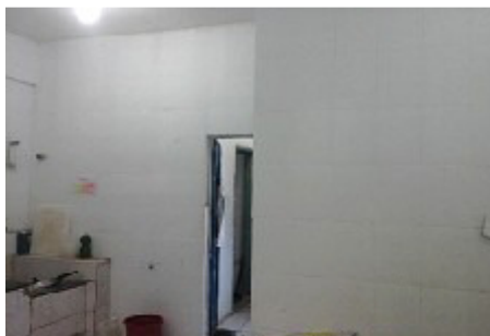
Instalações sanitárias em comunicação direta com a área de preparação de alimentos (situação sinalizada desde 2014)
