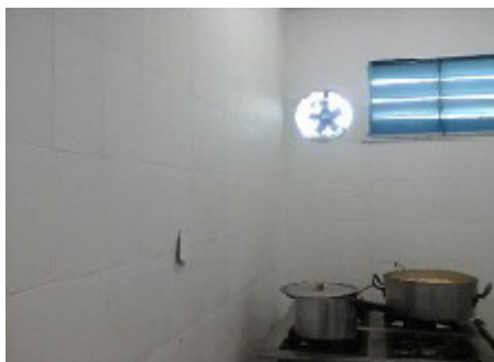
Ausência de coifa (situação sinalizada desde 2014)
