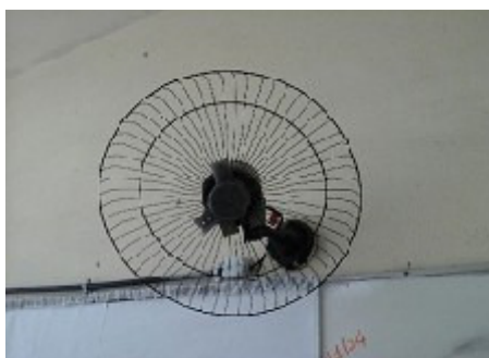
Ventilador danificado – salas 2, 17 e 26
