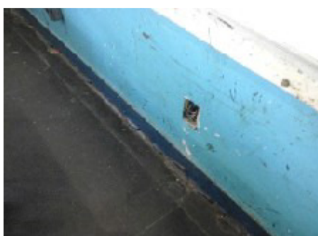
Fiação exposta – sala 3
