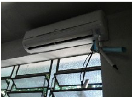
Todos os aparelhos de ar-condicionado com instalação danificada - sala 13
