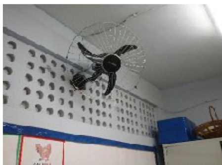
Ventilador com defeito – salas 6 e 7
