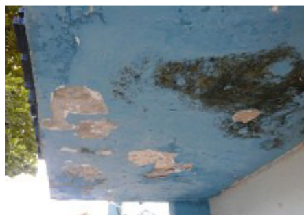
Infiltração – marquise na entrada da Unidade (situação sinalizada em 2015)
