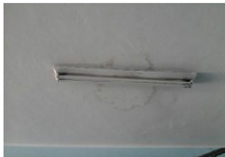
Pintura desgastada decorrente de infiltração sanada, conforme informado pela Direção – sala 14 (situação sinalizada em 2015)
