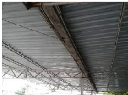
Calha danificada - cobertura do pátio
