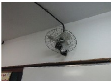
Ventilador danificado – sala 7
