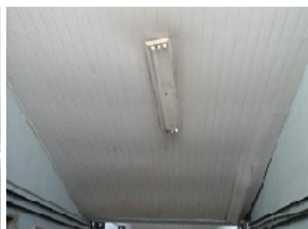
Lâmpadas ausentes/queimadas – corredor 1º andar
