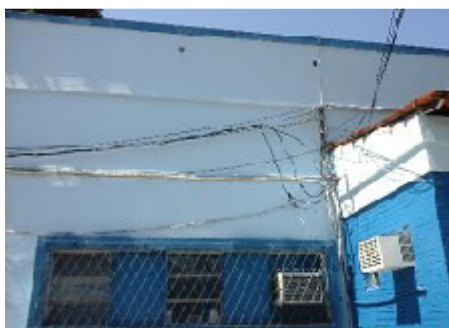
Fiação exposta – fachada principal (situação sinalizada desde 2012)
