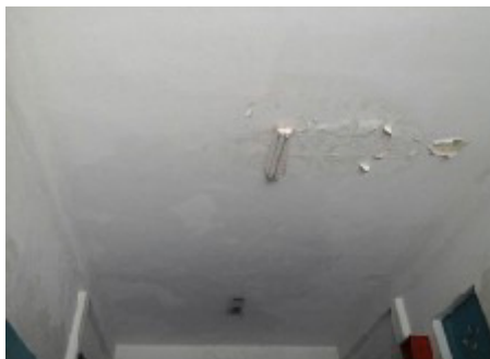
Lâmpadas desligadas devido a problemas na parte elétrica, conforme informado pela Direção – corredor 2º andar
