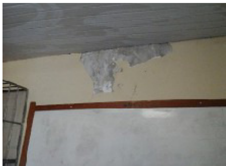
Pintura desgastada decorrente de infiltração sanada, conforme informado pela Direção – auditório 2 (antiga sala de vídeo). Situação sinalizada desde 2013.
