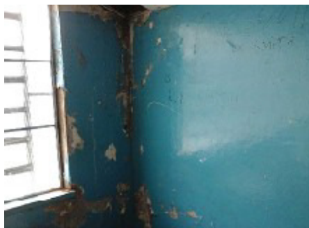
Infiltração e queda de reboco – sala 19
