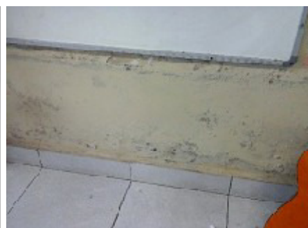
Pintura desgastada decorrente de infiltração sanada, conforme informado pela Direção – sala 1
