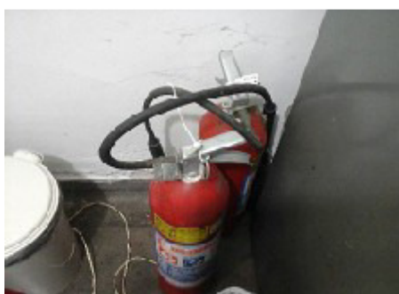
Extintores de incêndio armazenados num mesmo local (arquivo). Situação sinalizada em 2015.
