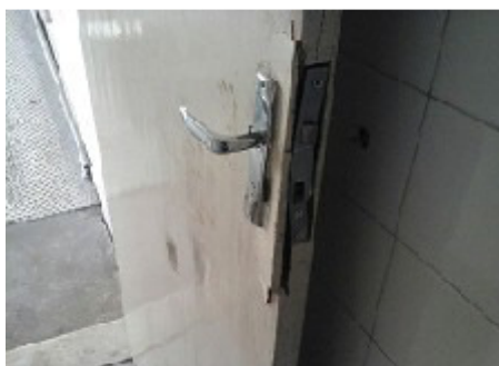
Porta e maçaneta danificadas - vestiário masculino
