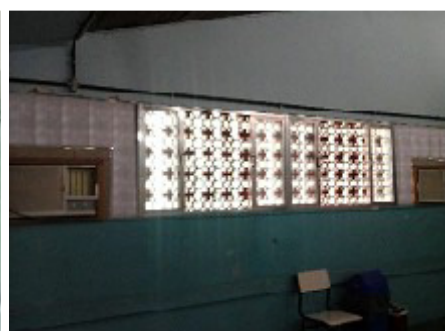
Todos os aparelhos de ar-condicionado com defeito – salas 1, 2 e 6
