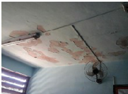
Pintura desgastada decorrente de infiltração sanada, conforme informado pela Direção - sala 4 prédio anexo. Situação sinalizada em 2015.
