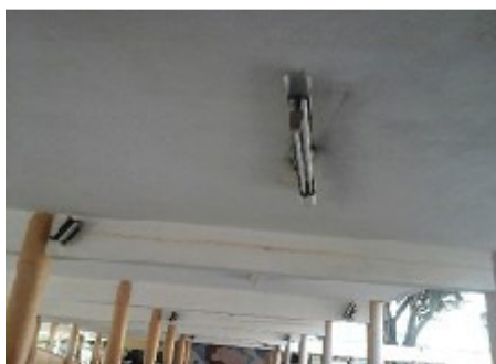
Fiação exposta nas luminárias - pátio
