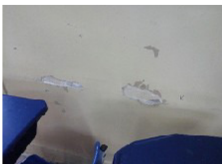
Queda de reboco – sala 9
