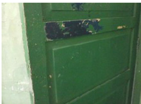
Ausência de maçaneta na porta – diversas salas
