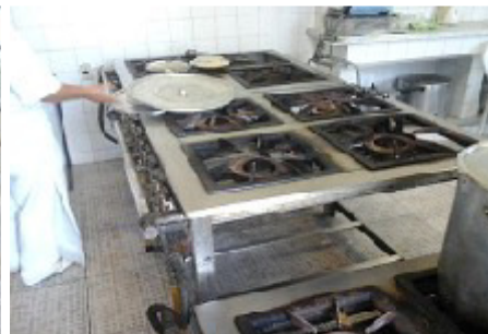
Necessidade de manutenção do fogão (situação sinalizada em 2015)
