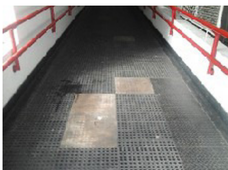
Piso danificado – acesso aos andares
