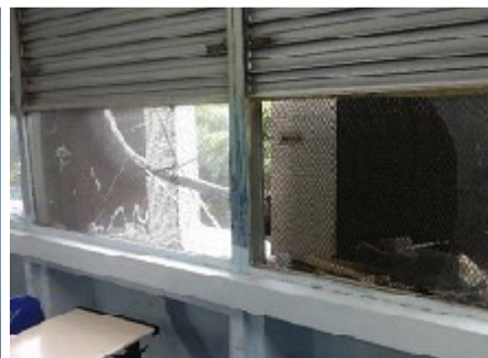
Vidros danificados no basculante - sala 8
