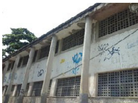
Pintura desgastada e pichações – área externa prédio principal (situação sinalizada desde 2014)
