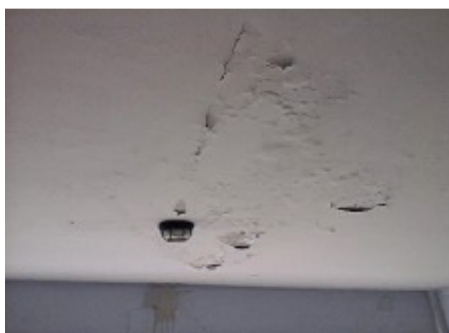
Infiltração – térreo próximo ao refeitório
