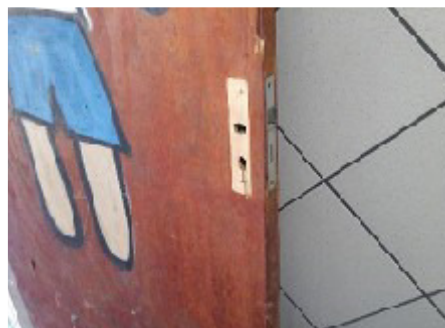
Ausência de maçaneta na porta – banheiro masculino do corredor
