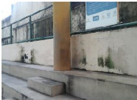
Infiltração (situação sinalizada desde 2014)
