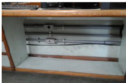
Pintura desgastada (situação sinalizada desde 2014)
