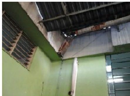
Parte da calha pendurada (situação sinalizada em 2015)
