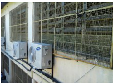
Unidades condensadoras não se conectam aos aparelhos de ar-condicionado localizados no interior das salas de aula - sala 7 e sala de recursos (situação sinalizada em 2015) e salas 5 e 8
