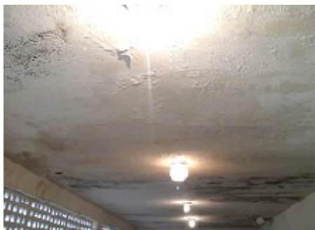
Infiltração decorrente de problemas na caixa d'água, conforme informado pela Direção – vestiário feminino
