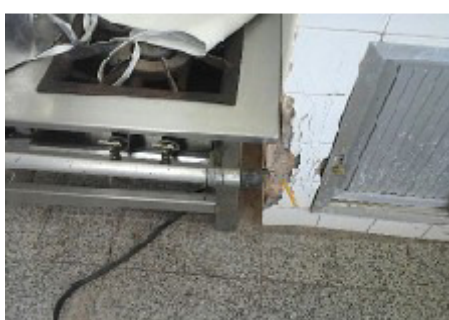
Queda de revestimento (situação sinalizada em 2015)
