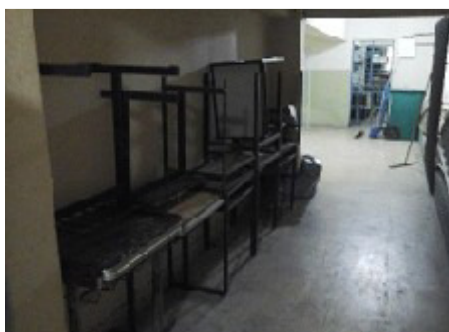
Material armazenado no corredor da Unidade – subsolo
