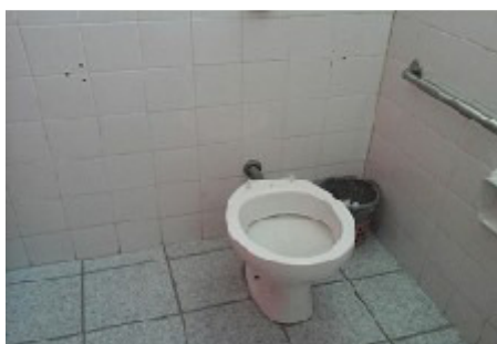
Ausência de barra de apoio junto à bacia sanitária no fundo e de assento sanitário (boxe para portador de necessidades especiais) – banheiro feminino 2º andar
