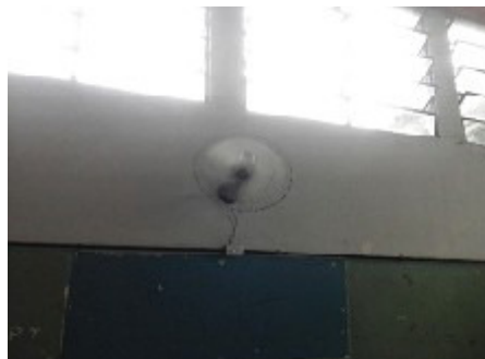
Ausência de grade de proteção no ventilador – sala 11
