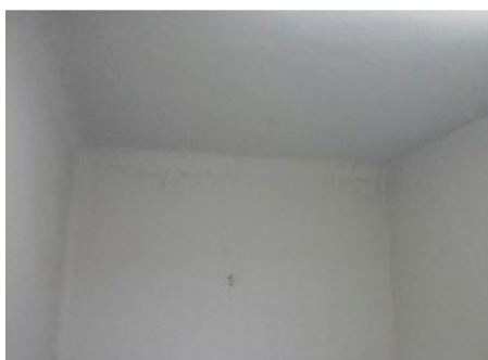
Pintura desgastada decorrente de infiltração sanada, conforme informado pela Direção – 2º andar
