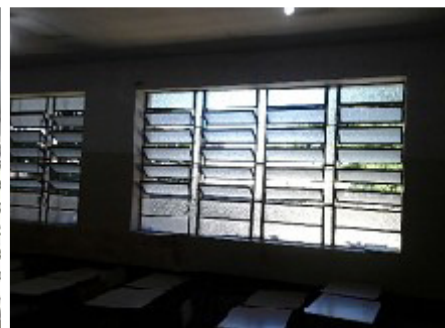
Ausência de aparelho de ar-condicionado - salas 14, 15 e 16 (situação sinalizada em 2015)
