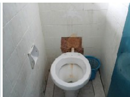
Ausência de acabamento – banheiro feminino corredor das salas 22 a 24
