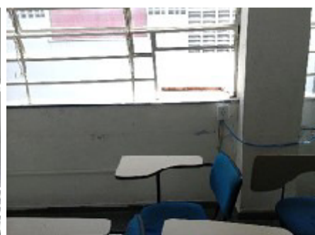
Ausência de aparelho de ar-condicionado e de grade/tela de proteção ocasionando grande abertura – sala do Mais Educação
