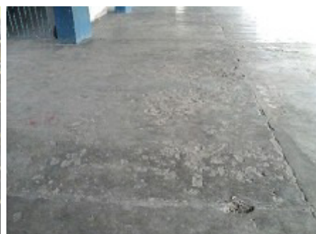
Piso danificado – térreo
