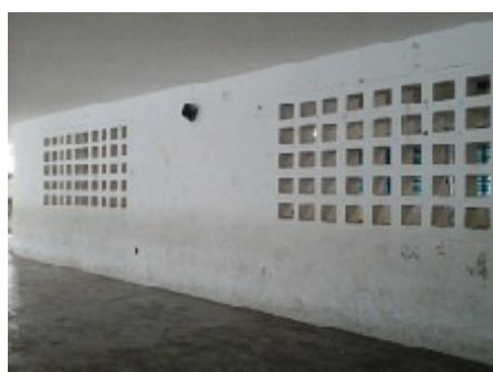
Pintura desgastada - pátio (situação sinalizada em 2015)
