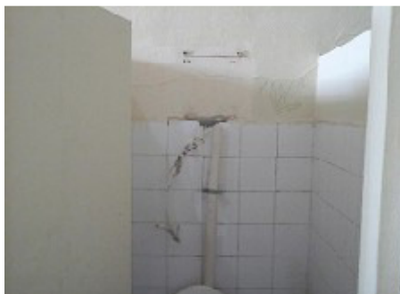
Ausência de descarga (1 boxe) - banheiro feminino 2º andar
