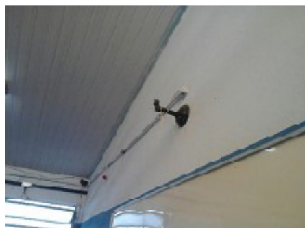
Ausência de 1 ventilador – sala 4
