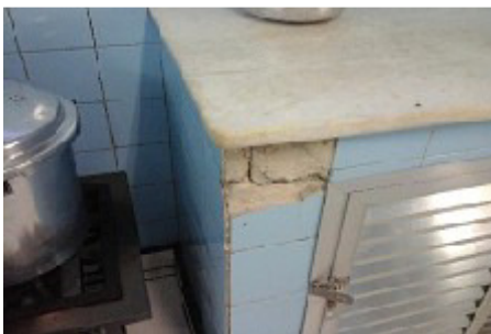
Queda de revestimento (situação sinalizada em 2015)
