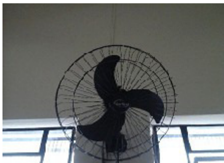
Ventilador com defeito – salas 2 e 8
