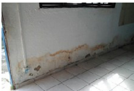
Infiltração e queda de reboco – antiga sala 2 da classe especial (situação sinalizada em 2015)
