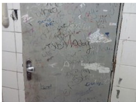
Pichações – porta de entrada do banheiro feminino térreo
