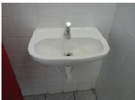
Ausência de barras de apoio junto ao lavatório (boxe para portador de necessidades especiais) – banheiros masculino e feminino 1º andar
