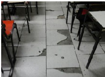
Piso danificado – sala 10
