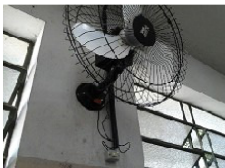
Ventilador com defeito e com fiação exposta – sala 1 prédio principal
