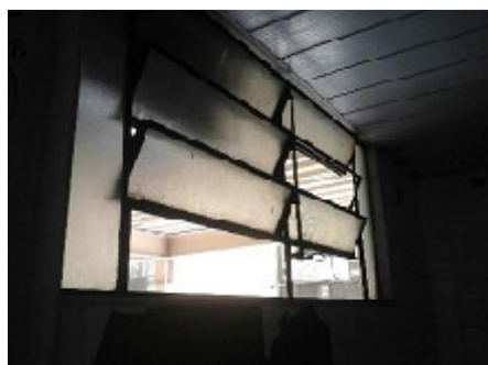
Ausência de vidros no basculante – vestiário masculino
