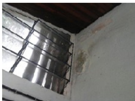
Infiltração - sala 1 (situação sinalizada em 2015)
