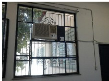
Aparelhos de ar-condicionado desligados devido à necessidade de revisão da parte elétrica (redistribuição interna e aumento de carga elétrica), conforme informado pela Direção – salas 10, 11 e 15 a 21
