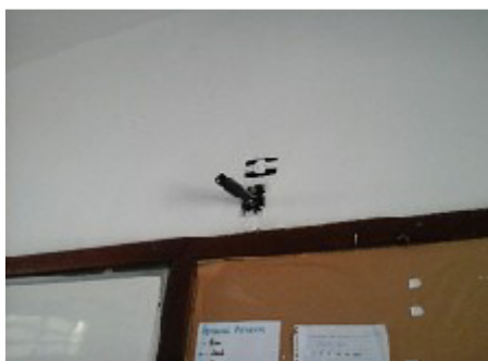
Ausência de 2 ventiladores – sala 14
