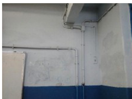
Pintura desgastada – diversas salas (situação sinalizada em 2015)
