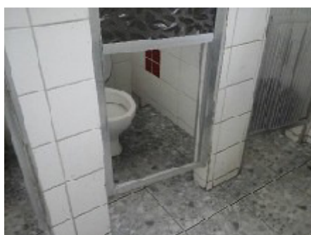
Porta danificada (1 boxe) – banheiro feminino térreo
