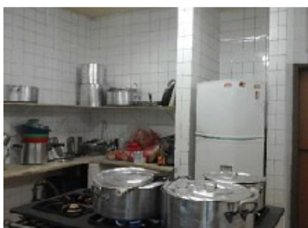
Ausência de coifa (situação sinalizada desde 2014)
