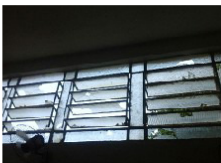
Vidros danificados/ausentes no basculante – diversas salas
