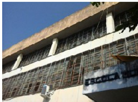
Pintura desgastada – área externa (situação sinalizada em 2015)
