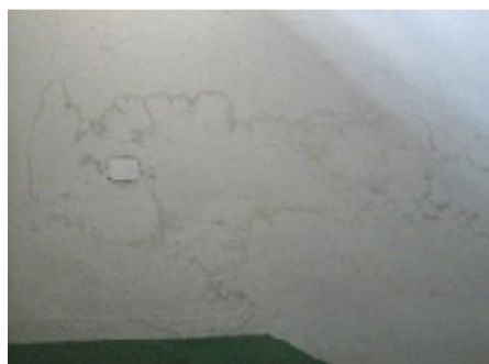
Pintura desgastada decorrente de infiltração sanada, conforme informado pela Direção – acesso ao 3º andar
