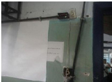
Fiação exposta – sala 15 (situação sinalizada desde 2014)
