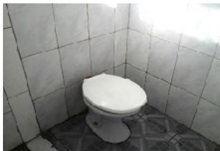
Ausência de barras de apoio (boxe para portador de necessidades especiais) - banheiro masculino prédio principal (situação sinalizada em 2015)
