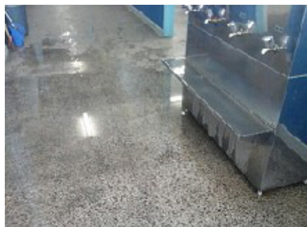
Bebedouro entupido causando alagamento - corredor 1º andar
