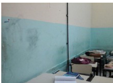
Pintura desgastada – diversas salas
