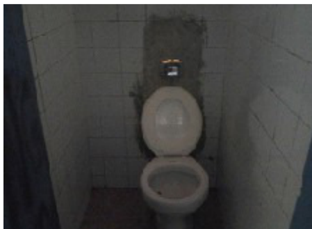
Ausência de revestimento – banheiro masculino
