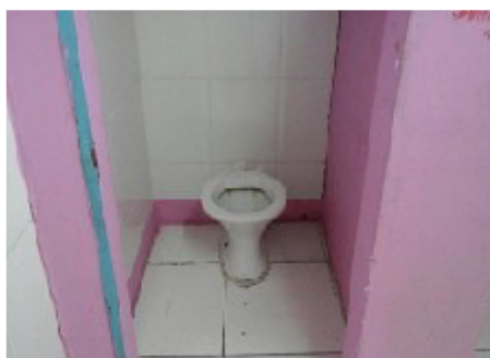
Ausência de assento sanitário (1 boxe) – banheiro feminino 1º andar
