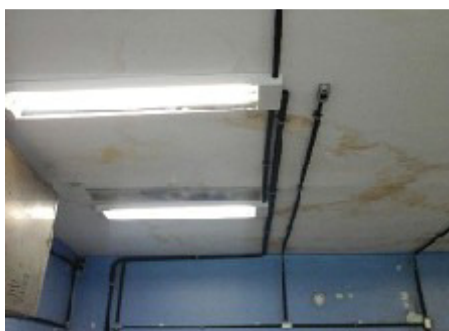
Infiltração recorrente (situação sinalizada em 2015) – sala 17
