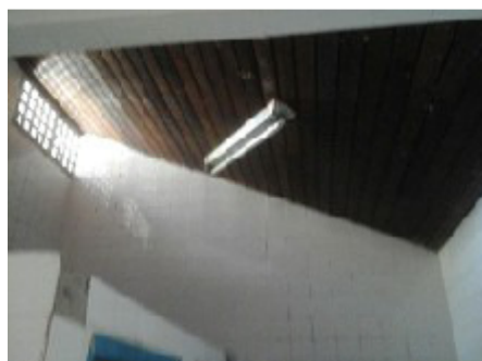
Lâmpadas queimadas – banheiro masculino
