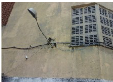
Fiação exposta – área externa
