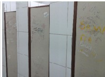
Pichações nas portas – banheiro feminino térreo
