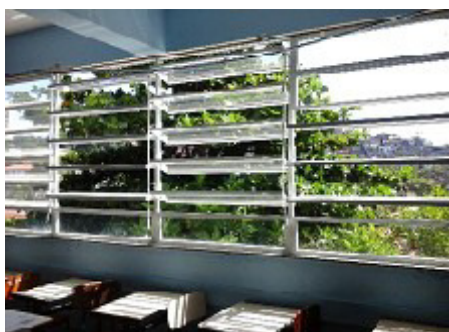
Ausência de grade/tela de proteção – diversas salas (situação sinalizada desde 2014)
