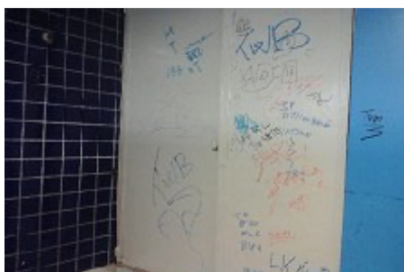
Pichações – banheiro masculino térreo
