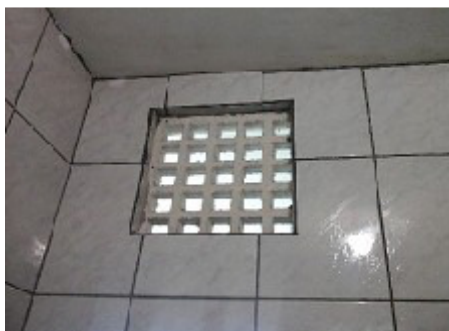
Ausência de tela de proteção milimétrica (situação sinalizada em 2015)
