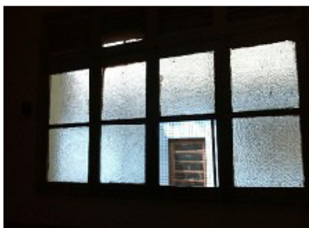
Ausência de vidro na janela – salas 2 e 5
