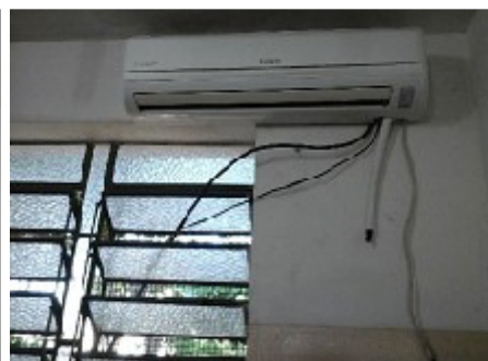
Todos os aparelhos de ar-condicionado com instalação danificada - sala 12
