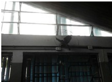
Ventilador danificado – sala 11
