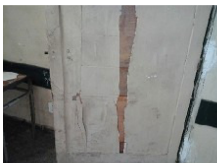
Porta danificada - sala 16 (situação sinalizada em 2015)
