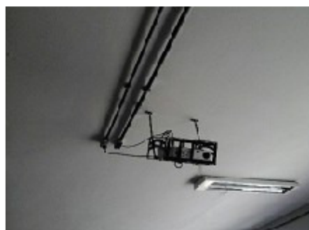
Projetor com defeito – salas 2, 3, 5, 7 e 8
