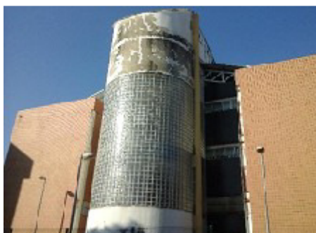
Pintura desgastada – área externa (situação sinalizada em 2015)
