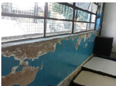
Queda de reboco – sala 4 (situação sinalizada em 2015)
