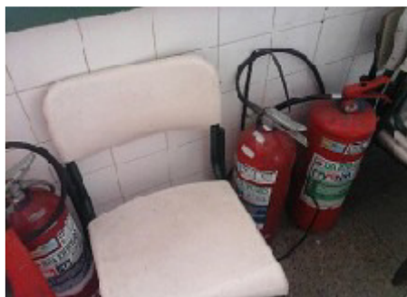
Extintores de incêndio armazenados num mesmo local (sala de música)
