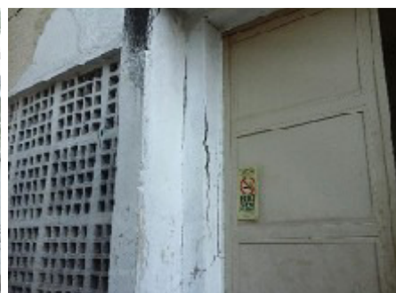
Rachadura – área externa próximo ao refeitório
