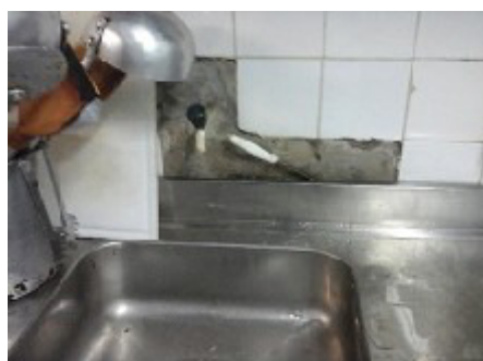
Queda de revestimento
