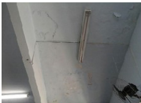
Infiltração – sala 7 (situação sinalizada desde 2014)
