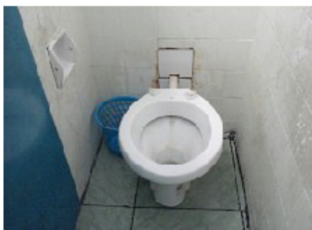
Ausência de assento sanitário em todos boxes em uso e descargas com defeito (descendo água sem parar) – banheiro masculino corredor das salas 22 a 24
