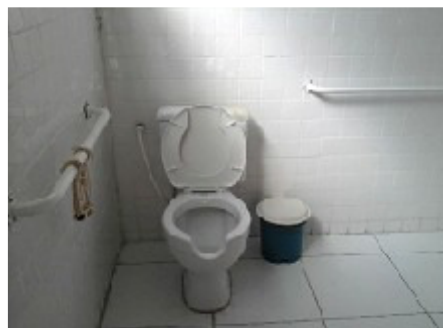
Ausência de barra de apoio junto à bacia sanitária no fundo – banheiro para portador de necessidades especiais
