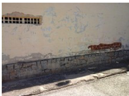
Queda de reboco - área externa fundos (situação sinalizada desde 2011)
