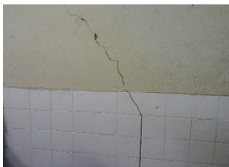
Rachadura - vestiário (situação sinalizada desde 2013)
