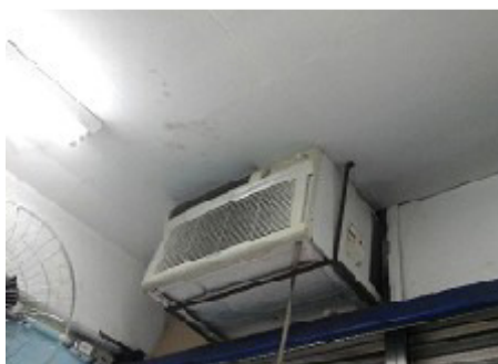
Único aparelho de ar-condicionado existente com defeito – sala dos professores
