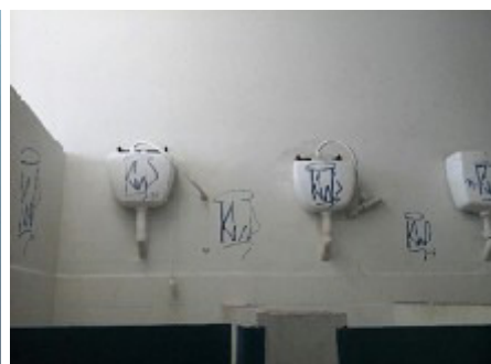
Pichações – banheiro masculino corredor das salas 22 a 24
