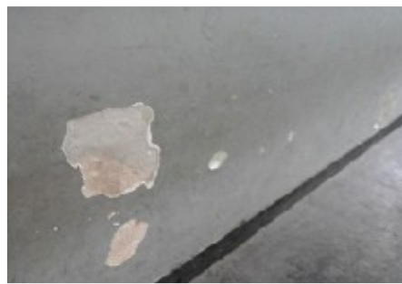
Queda de reboco
