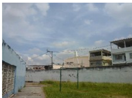
Pichações – área externa (situação sinalizada em 2015)
