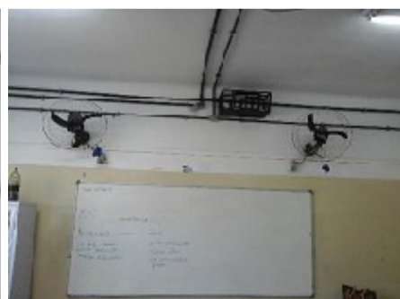
Todos os ventiladores com defeito – salas 4, 7, 10 e 11
