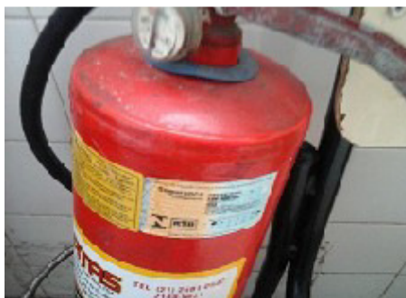
Extintores de incêndio vencidos
