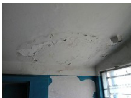
Infiltração – sala 14 (situação sinalizada desde 2012)
