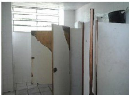
Portas danificadas - banheiro feminino prédio anexo 2
