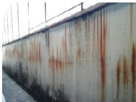
Pintura desgastada – muro (situação sinalizada em 2014)
