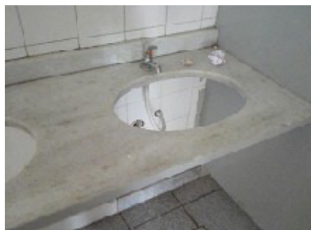
Ausência de cuba na pia – vestiário feminino
