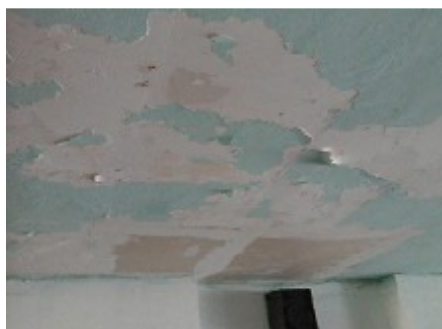
Ausência de acabamento (pintura) – pátio (situação sinalizada em 2015)
