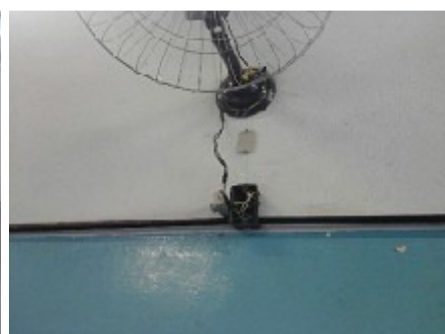
Fiação exposta no ventilador – sala 7
