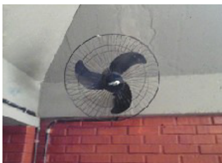
Ventilador com defeito – salas 2, 5 e 6
