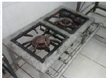
Necessidade de manutenção nos fogões
