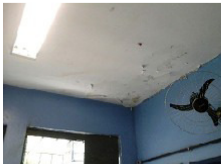
Pintura desgastada decorrente de infiltração sanada, conforme informado pela Direção – sala 12
