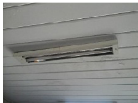
Pintura desgastada decorrente de infiltração sanada, conforme informado pela Direção – sala 9
