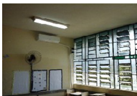
Aparelhos de ar-condicionado desligados devido à necessidade de aumento da carga elétrica (situação sinalizada em 2015) e de redistribuição elétrica interna, conforme informado pela Direção - diversas salas.
