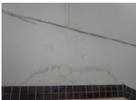
Infiltração - acesso ao 1º andar
