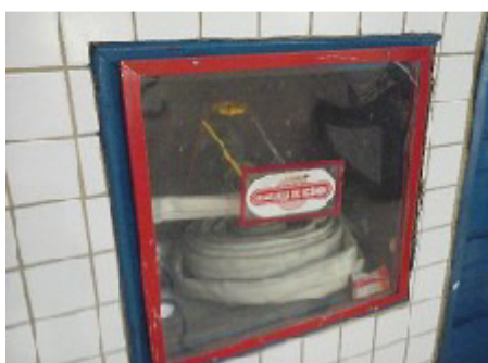
Porta do compartimento de mangueira de combate a incêndio vedada - térreo, 1º e 2º andares
