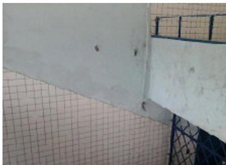
Fiação exposta – acesso ao 1º andar
