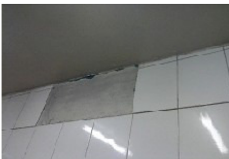
Queda de revestimento (situação sinalizada em 2015)
