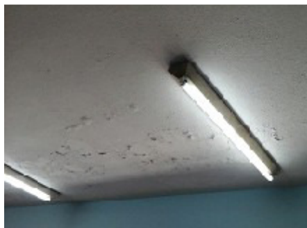
Pintura desgastada – sala 3 prédio principal
