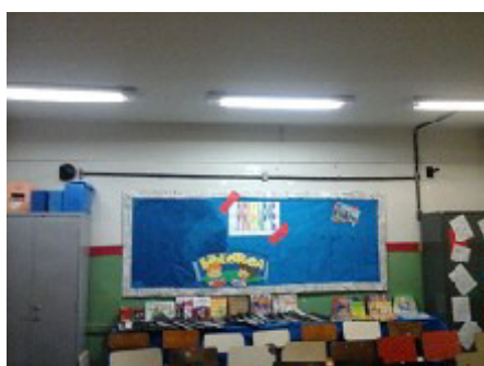
Ausência de 2 ventiladores – sala 3
