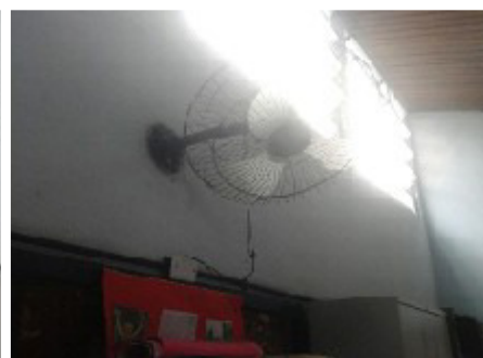
Ventilador com defeito e com fiação exposta – sala 17
