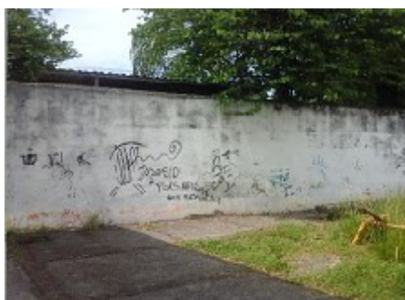
Pichações – muro próximo à quadra (situação sinalizada desde 2014)
