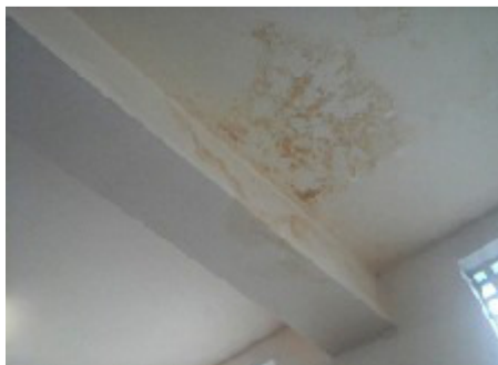
Infiltração decorrente de problemas no telhado, conforme informado pela Direção – corredor 1º andar
