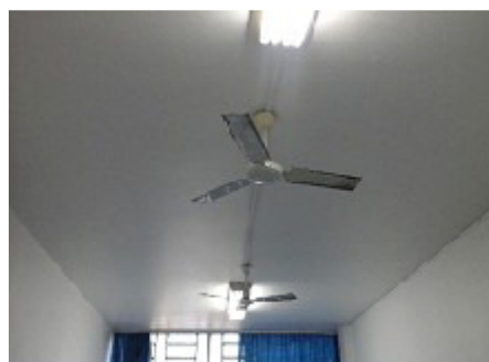
Ausência de ventilador de parede (só tem ventilador de teto) – sala da turma 1603 (antiga sala de vídeo). Situação sinalizada em 2015.
