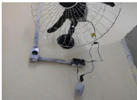
Fiação exposta no ventilador – sala 2
