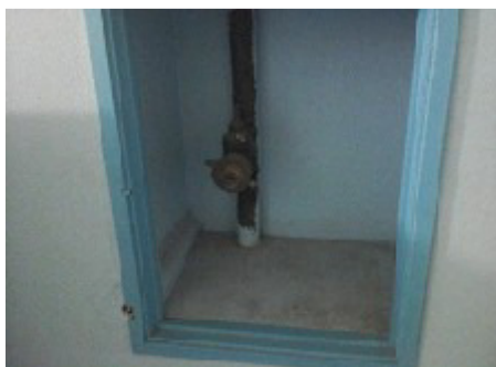
Ausência de mangueira de combate a incêndio - 3º andar (situação sinalizada desde 2014)
