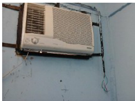
Fiação da distribuição elétrica interna para uso dos aparelhos de ar-condicionado exposta – sala 4
