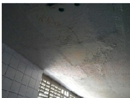
Pintura desgastada - vestiário masculino
