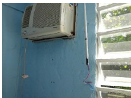
Fiação da distribuição elétrica interna para uso dos aparelhos de ar-condicionado exposta – sala 12
