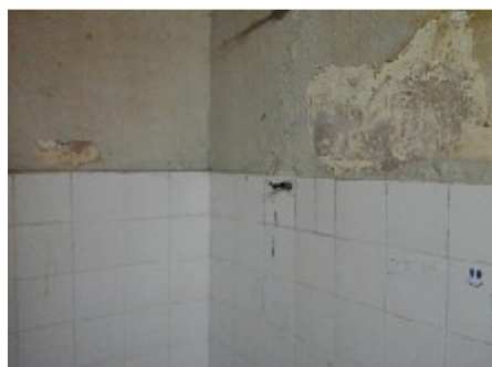
Pintura desgastada – banheiro masculino do corredor
