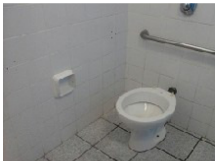
Ausência de barra de apoio junto à bacia na lateral e de assento sanitário (boxe para portador de necessidades especiais) – banheiro masculino 2º andar
