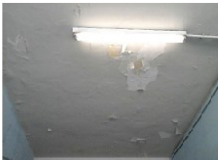
Pintura desgastada – corredor 1º andar (situação sinalizada desde 2014)
