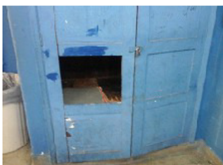
Armário danificado - sala 5
