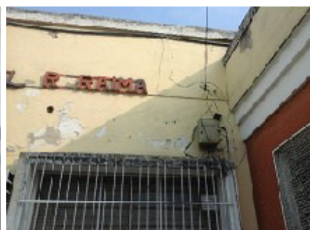
Fiação exposta – área externa
