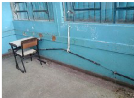
Canaleta danificada - salas 1 e 2
