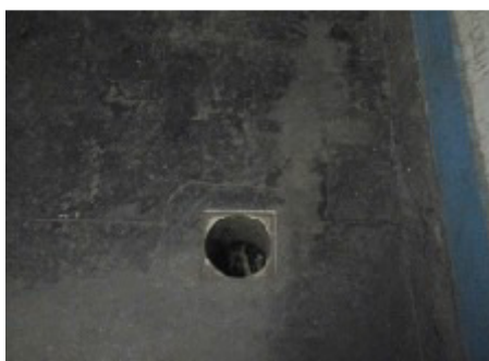
Ausência de tampa no ralo – vestiário masculino
