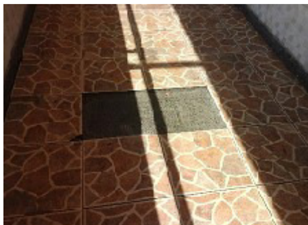
Piso danificado – acesso ao 1º andar
