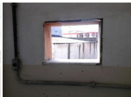
Ausência de aparelho de ar-condicionado - sala do agente de Educação Especial
