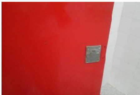
Maçaneta inadequada (boxe para portador de necessidades especiais) – banheiro masculino 2º andar
