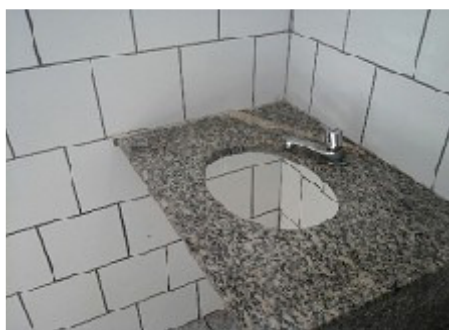
Ausência de cuba na pia – banheiro feminino térreo
