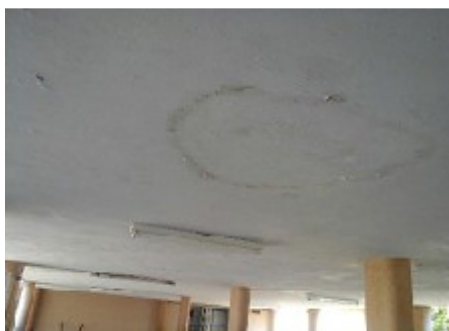
Pintura desgastada decorrente de infiltração sanada, conforme informado pela Direção - pátio
