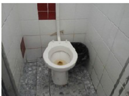
Ausência de assento sanitário (2 boxes) – banheiro feminino térreo
