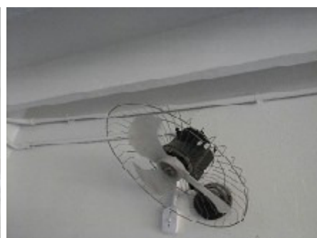
Ausência de grade de proteção no ventilador – sala 16
