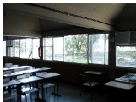
Aparelhos de ar-condicionado desligados devido à necessidade de aumento de carga elétrica, conforme informado pela Direção – auditório
