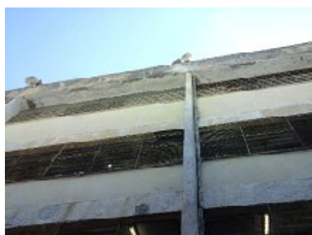
Queda de reboco com ferragem exposta – área externa fundos (situação sinalizada desde 2013)
