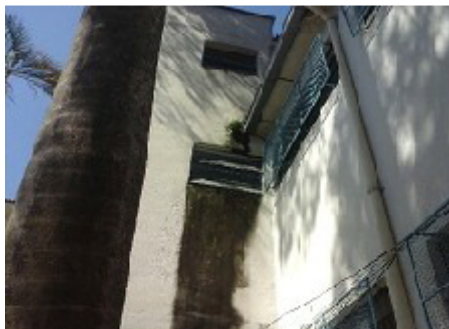
Infiltração - área externa (situação sinalizada em 2015)
