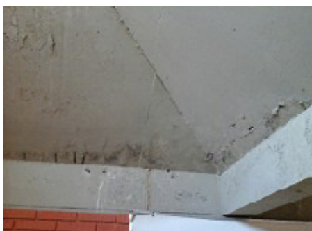
Queda de reboco com ferragem exposta – laboratório de ciências (situação sinalizada em 2015)
