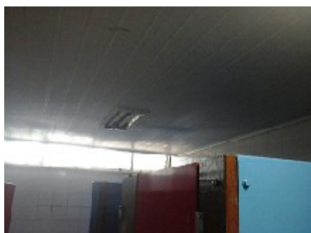
Lâmpadas queimadas – banheiro masculino térreo
