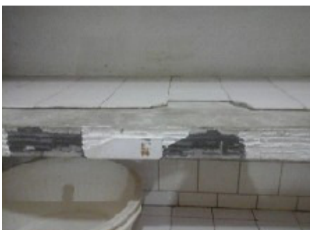
Queda de revestimento (situação sinalizada desde 2014)
