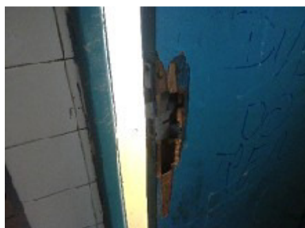
Porta de entrada e maçaneta danificadas - vestiário masculino
