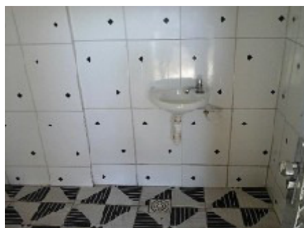
Ausência de barras de apoio junto ao lavatório – banheiro masculino para portadores de necessidades especiais
