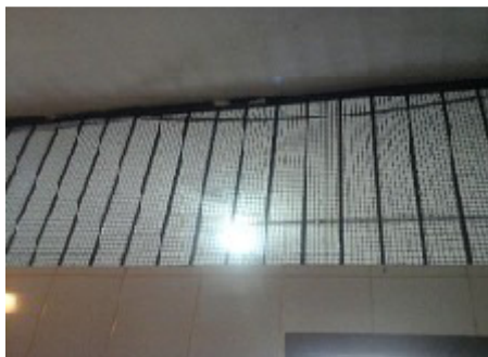
Ausência de tela de proteção milimétrica (situação sinalizada desde 2012)
