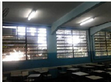
Aparelhos de ar-condicionado desligados devido à necessidade de aumento da carga elétrica (situação sinalizada em 2015) e de redistribuição elétrica interna, conforme informado pela Direção - salas de aula.
