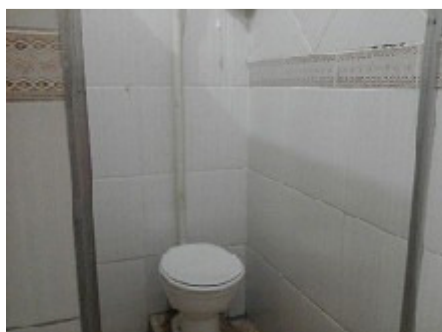
Ausência de barras de apoio junto ao vaso sanitário e de porta (boxe para portador de necessidades especiais) – banheiro feminino
