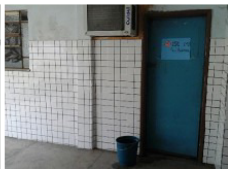
Vazamento de água oriunda das condensadoras dos aparelhos de ar-condicionado – corredor térreo da Unidade
