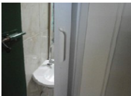
Ausência de maçaneta do tipo alavanca (boxe para portador de necessidades especiais) – banheiro masculino térreo
