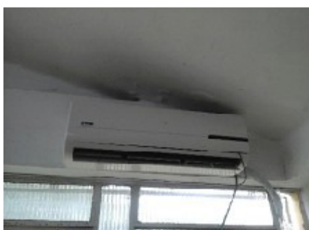
Único aparelho de ar-condicionado existente com defeito – salas 1, 6, 7 e 9
