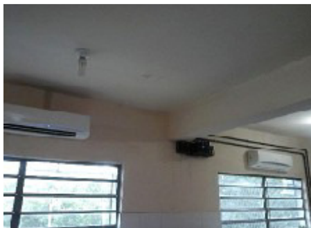
Todos os aparelhos de ar-condicionado com defeito – sala 13
