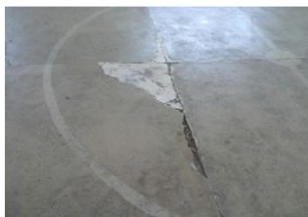
Piso danificado (situação sinalizada em 2015)
