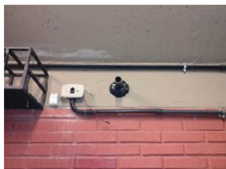
Ausência de 1 ventilador – salas 4 e 6 e sala de recursos
