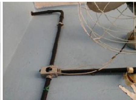
Fiação exposta no ventilador – sala 9
