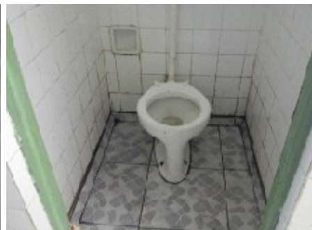
Ausência de assento sanitário (4 boxes) - banheiro masculino
