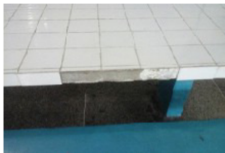
Queda de revestimento
