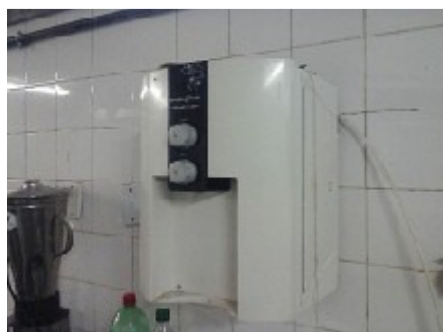
Filtro de água com defeito
