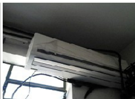
Único aparelho de ar-condicionado existente com instalação danificada - sala 9
