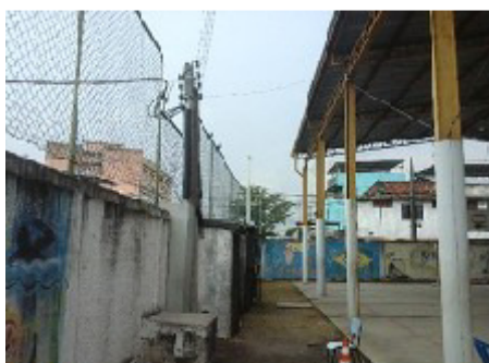
Ausência de alambrado e tela de proteção - laterais
