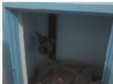
Ausência de porta no compartimento de mangueira de combate a incêndio – 1º e 3º andares
