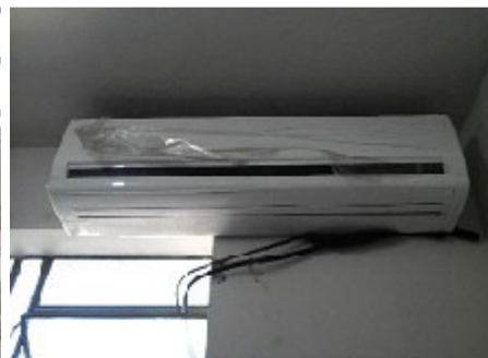
Todos os aparelhos de ar-condicionado com instalação danificada - sala 10
