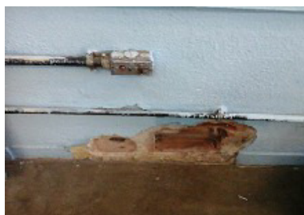
Queda de reboco – sala 7 (situação sinalizada desde 2013)
