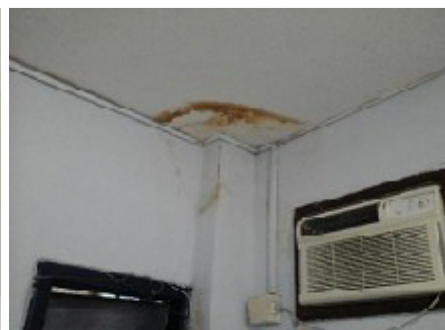
Pintura desgastada decorrente de infiltração sanada, conforme informado pela Direção – sala da Direção (situação sinalizada em 2015)
