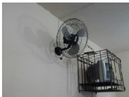
Ventilador com defeito - sala 15
