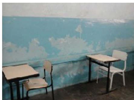
Pintura desgastada – salas de aula (situação sinalizada em 2015)
