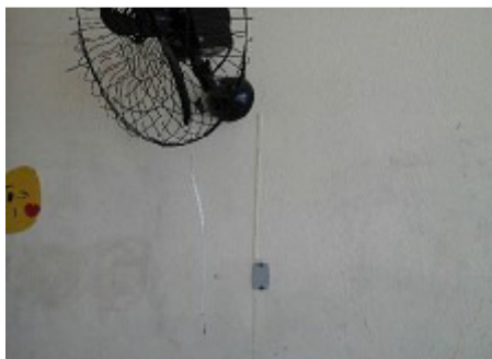
Ventilador com defeito e com fiação exposta – sala 27
