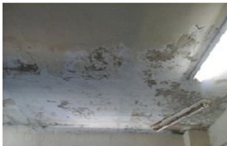
Infiltração decorrente de problemas no telhado, conforme informado pela Direção – sala do Mais Educação (antiga sala de recursos). Situação sinalizada desde 2013.
