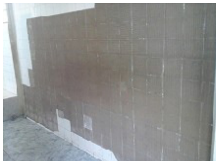
Queda de revestimento - vestiário feminino (situação sinalizada em 2015)
