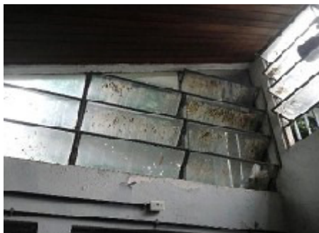
Necessidade de limpeza nos vidros - salas 1 e 2
