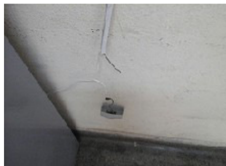
Ventilador com defeito e com fiação exposta – sala 5
