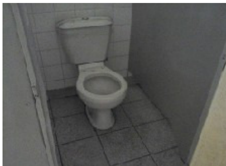
Ausência de assento sanitário (1 boxe) – vestiário masculino
