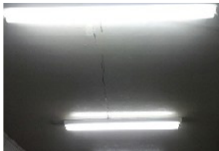
Fiação exposta (situação sinalizada em 2015)
