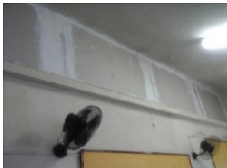
Pintura desgastada – diversas salas
