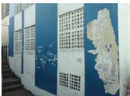
Pintura desgastada e pichações – área externa
