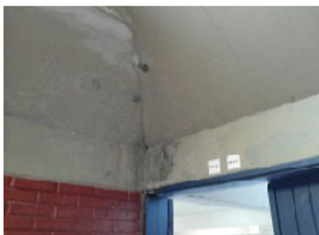
Pintura desgastada decorrente de infiltração sanada, conforme informado pela Direção – entrada do refeitório
