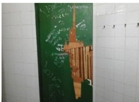
Porta danificada (1 boxe de vaso sanitário) – vestiário feminino (situação sinalizada em 2015)
