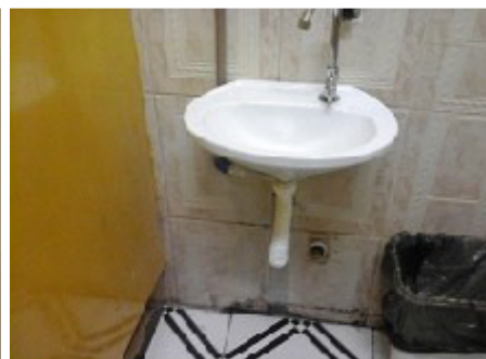
Ausência de barras de apoio junto ao lavatório (boxe para portador de necessidades especiais) – banheiro feminino térreo
