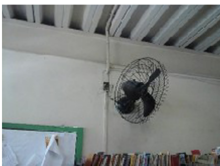
Único ventilador existente com defeito e com fiação exposta – sala de leitura
