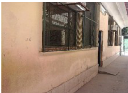
Pintura desgastada - área externa prédio principal
