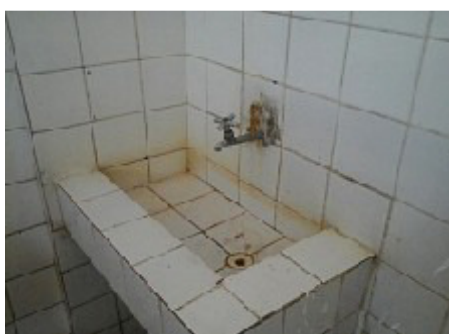
Única pia com torneira sem água - vestiário masculino
