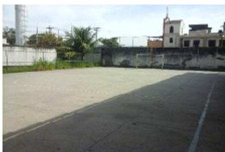
Quadra descoberta (situação sinalizada desde 2013) e equipamentos danificados (tabelas de basquete) - 2ª quadra
