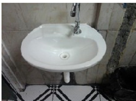
Ausência de barras de apoio junto ao lavatório (boxe para portador de necessidades especiais) – banheiro masculino térreo
