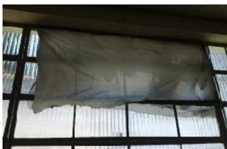
Vidros danificados/ausentes no basculante (situação sinalizada em 2015)
