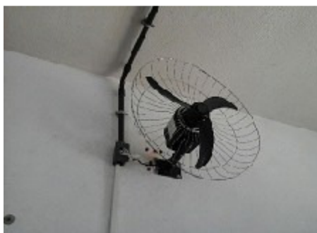
Ventilador com defeito e com fiação exposta – sala 14
