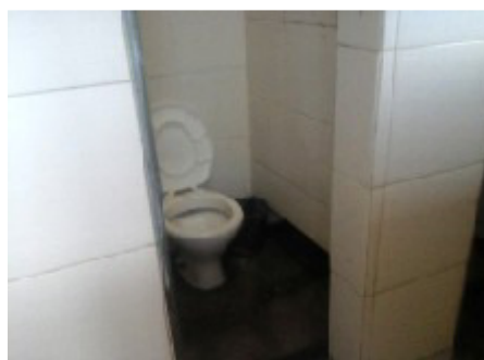
Ausência de porta (1 boxe) – banheiro masculino
