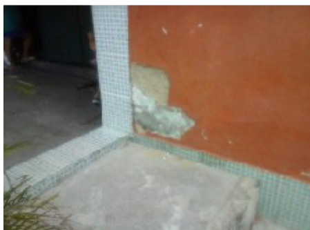
Queda de reboco – área externa
