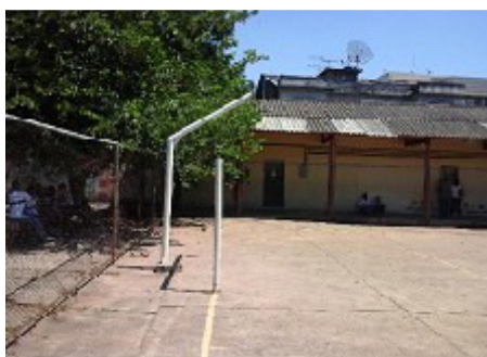
Equipamentos danificados (tabelas de basquete). Situação sinalizada desde 2013.
