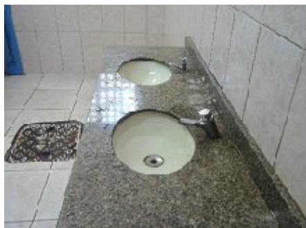
Torneira danificada – banheiro feminino
