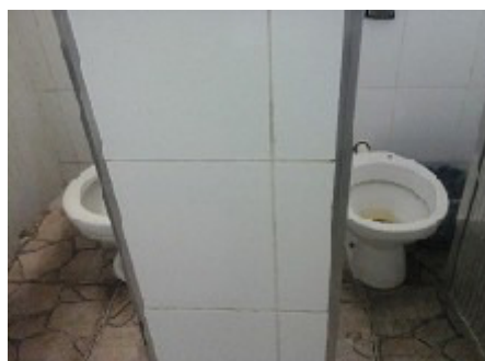
Ausência de assento sanitário em todos os boxes – banheiro feminino térreo próximo ao acesso ao 1º andar
