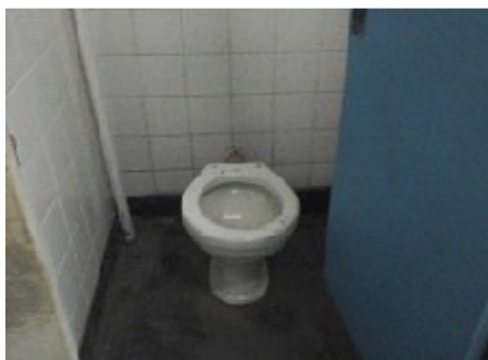
Ausência de assento sanitário (3 boxes) – vestiário masculino
