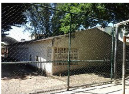
Alambrado danificado (situação sinalizada em 2015)
