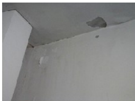
Infiltração - banheiro utilizado pelos manipuladores de alimentos
