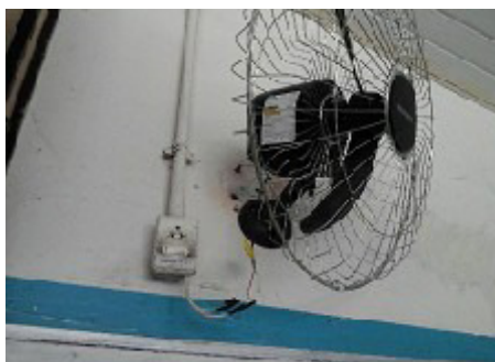
Todos os ventiladores com defeito e com fiação exposta – sala 12
