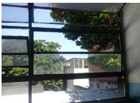
Vidros danificados/ausentes no basculante – acesso ao 2º andar
