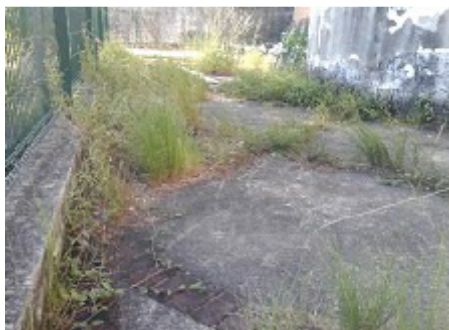
Necessidade de capina
