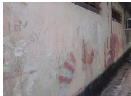
Pintura desgastada – área externa (situação sinalizada em 2015)
