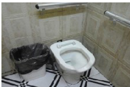
Ausência de assento sanitário (boxe para portador de necessidades especiais) – banheiro feminino térreo
