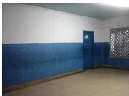
Pintura desgastada – corredor das salas 11 a 17 (situação sinalizada em 2015)
