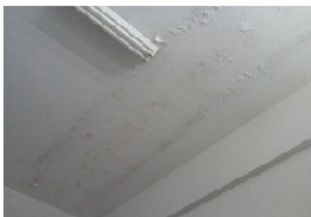
Infiltração decorrente de problemas no telhado, conforme informado pela Direção – sala de leitura
