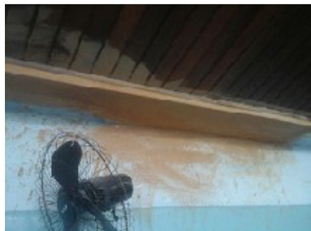
Ausência de acabamento (pintura) – sala 14
