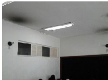
Ausência de ventilador – sala 8 e sala do Mais Educação
