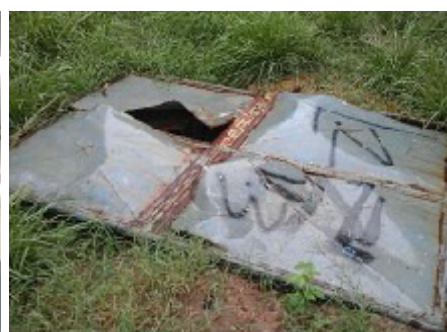
Presença de grande abertura no chão - área externa
