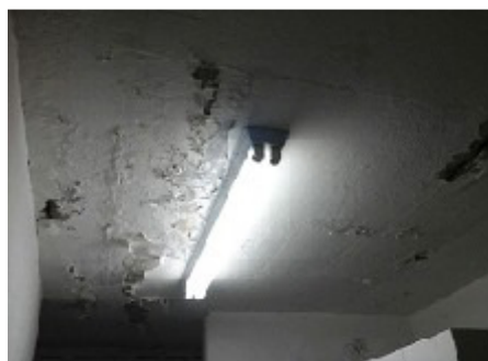
Infiltração decorrente de problemas no telhado, conforme informado pela Direção - vestiário masculino (situação sinalizada desde 2014)
