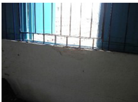
Queda de reboco - auditório
