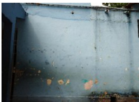
Pintura desgastada – área externa (situação sinalizada em 2015)
