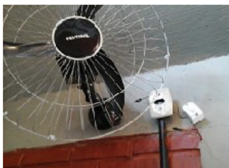
Ventilador com defeito e com fiação exposta – sala 2
