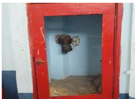
Ausência de mangueira de combate a incêndio no compartimento e porta danificada – térreo, 1º e 2º andares (situação sinalizada em 2015)
