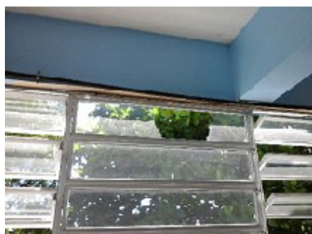
Vidros danificados/ausentes no basculante – diversas salas
