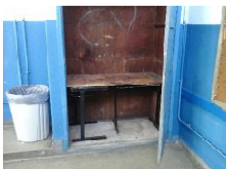
Armário danificado - salas 8 e 9
