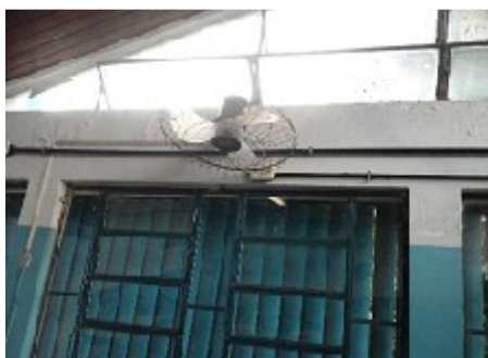
Ventilador com defeito – salas 2, 3, 5 e 10
