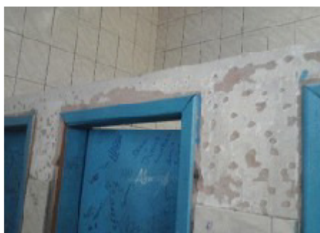
Queda de revestimento - banheiro feminino (situação sinalizada desde 2014)
