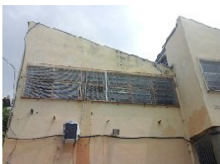
Pintura desgastada – área externa
