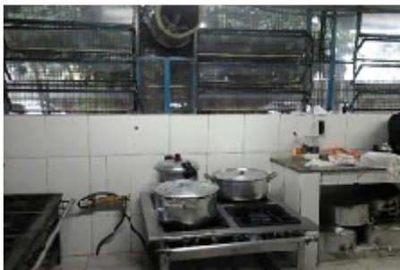
Ausência de coifa (situação sinalizada desde 2014)
