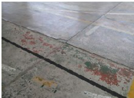
Piso danificado (situação sinalizada em 2015)
