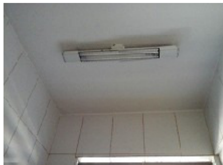
Lâmpadas queimadas – banheiro para portador de necessidades especiais
