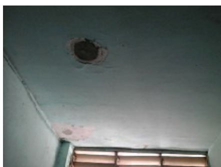
Pintura desgastada decorrente de infiltração sanada, conforme informado pela Direção – corredor 2º andar próximo à sala 8
