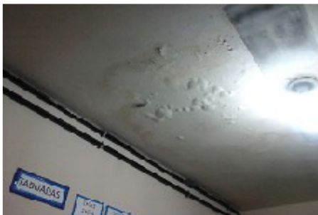
Infiltração decorrente de problemas no telhado, conforme informado pela Direção – sala 10
