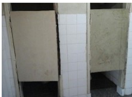
Portas dos boxes com altura inadequada – banheiro feminino do corredor
