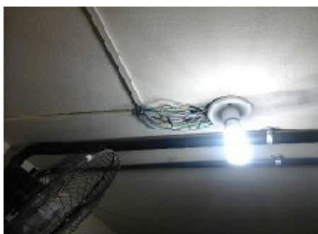
Fiação exposta – sala 13
