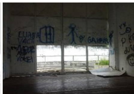
Parede danificada (situação sinalizada em 2015)
