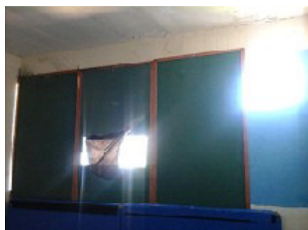
Ausência de janela (quadros sendo utilizados para vedar a parede) – sala do Mais Educação (antiga sala de recursos)
