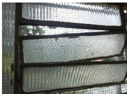
Basculantes danificados – diversas salas
