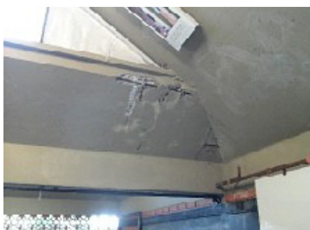
Queda de reboco com ferragem exposta – sala 9 (situação sinalizada em 2015)
