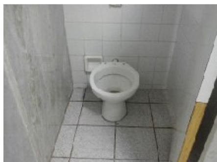
Ausência de assento sanitário no único boxe - vestiário masculino
