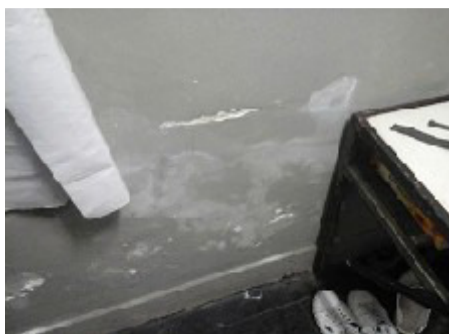
Infiltração - banheiro utilizado pelos manipuladores de alimentos
