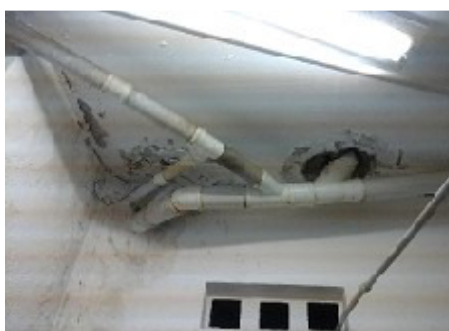
Queda de reboco - banheiro feminino subsolo (situação sinalizada desde 2014)
