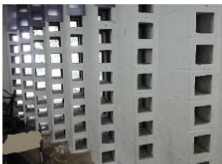
Ausência de vedação (ambiente climatizado) - salas 2 e 9
