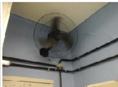
Ausência de grade de proteção no ventilador – salas 5 e 14
