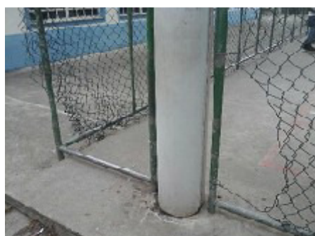
Alambrado danificado (situação sinalizada em 2015)
