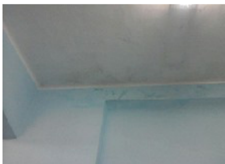
Pintura desgastada decorrente de infiltração sanada, conforme informado pela Direção – sala 8 (situação sinalizada em 2015)
