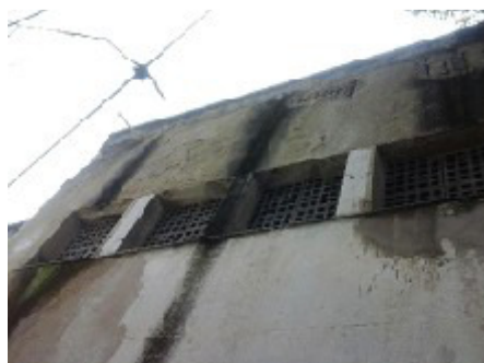
Queda de reboco (situação sinalizada desde 2014) e ferragem exposta - área externa prédio principal
