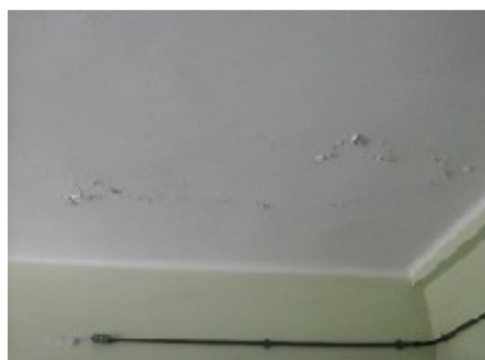
Pintura desgastada decorrente de infiltração sanada, conforme informado pela Direção – auditório (situação sinalizada em 2015)
