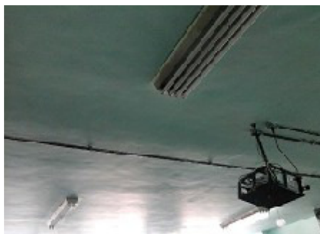
Lâmpadas ausentes/queimadas – salas 4, 6, 12 e 17
