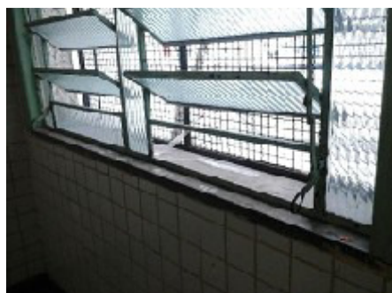
Vidros danificados/ausentes no basculante – sala 10
