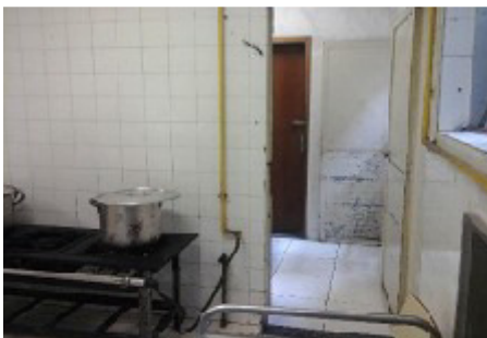
Instalações sanitárias em comunicação direta com a área de preparação de alimentos (situação sinalizada desde 2014)
