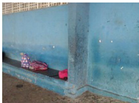
Pintura desgastada - pátio
