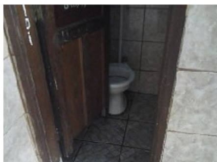
Ausência de assento sanitário (1 boxe) – banheiro masculino
