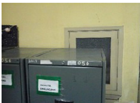
Gaveteiro instalado bloqueando o acesso ao compartimento de mangueira de combate a incêndio – térreo
