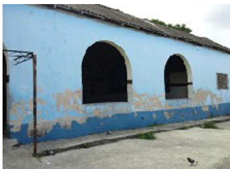
Pintura desgastada – área externa
