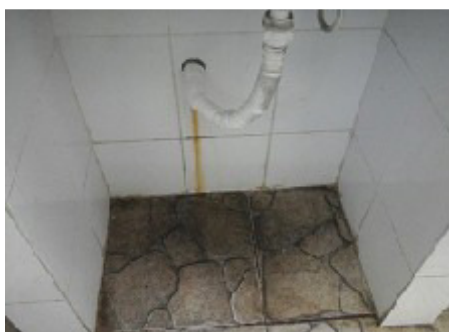
Tubulação danificada – banheiro feminino térreo próximo ao acesso ao 1º andar
