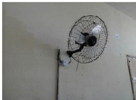
Ventilador com defeito – diversas salas e auditório
