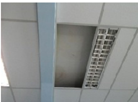
Ausência de placas do forro
