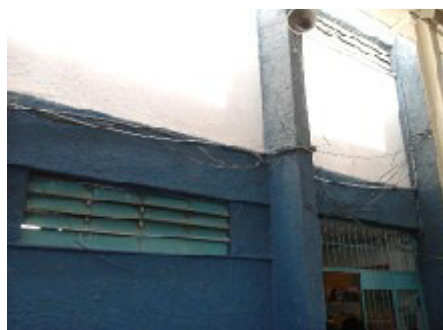
Fiação exposta – área externa próximo à quadra
