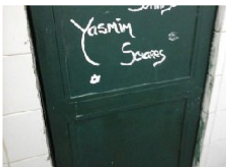
Boxe desativado – banheiro feminino térreo
