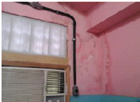
Infiltração – sala 4 (situação sinalizada em 2015)
