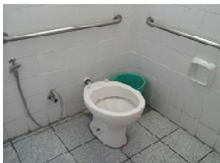
Ausência de assento sanitário (boxe para portador de necessidades especiais) – banheiro feminino 1º andar
