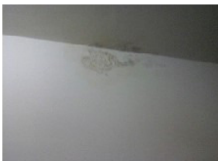
Pintura desgastada decorrente de infiltração sanada, conforme informado pela Direção – corredor próximo ao banheiro masculino térreo
