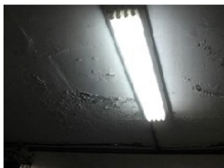
Pintura desgastada decorrente de infiltração sanada, conforme informado pela Direção – sala 4 (situação sinalizada em 2015)
