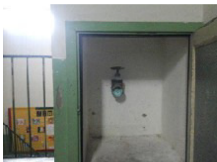
Ausência de mangueira de combate a incêndio – 3º andar
