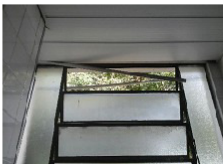
Ausência de vidro no basculante – vestiário feminino (situação sinalizada em 2015)
