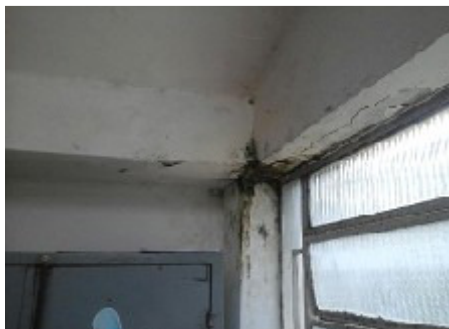
Infiltração recorrente (situação sinalizada em 2013) – sala 5
