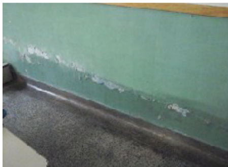
Infiltração - sala 4 prédio anexo (ao lado da casa de bonecas)
