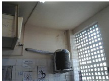
Infiltração decorrente de problemas no telhado, conforme informado pela Direção – acesso ao 1º andar
