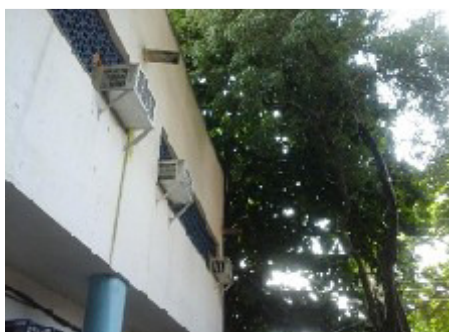
Necessidade de poda de árvore (situação sinalizada em 2015)
