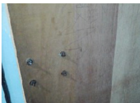
Ausência de maçaneta na porta – salas prédio principal (situação sinalizada em 2015)
