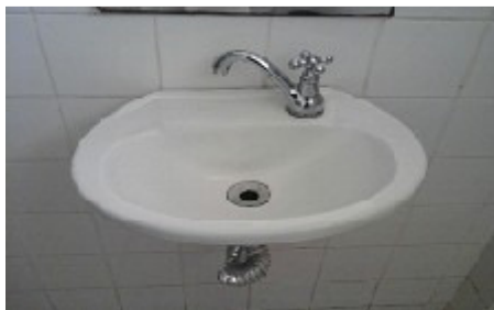
Torneira do lavatório de acionamento inadequado e ausência de barras de apoio junto ao lavatório – boxe para portador de necessidades especiais dos banheiros masculino e feminino (próximo ao laboratório de ciências)
