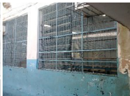
Grade de proteção danificada - sala 4 (situação sinalizada em 2015)
