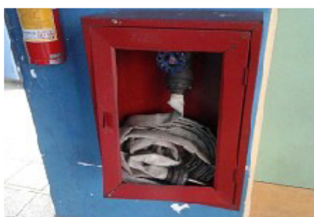
Compartimento de mangueira de combate a incêndio danificado
