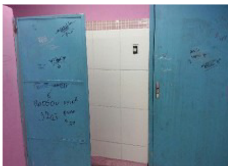
Pichações nas portas – banheiro feminino 1º andar
