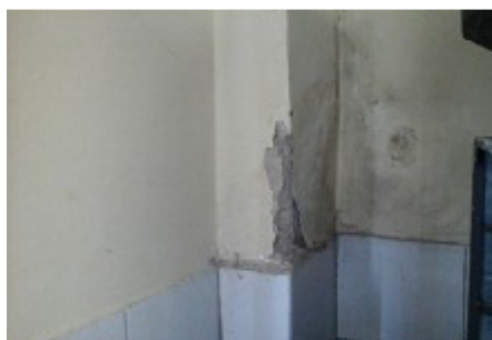
Queda de reboco – auditório 2 (antiga sala de vídeo). Situação sinalizada desde 2014.
