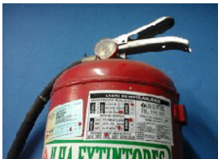
Extintores de incêndio vencidos
