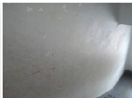
Pintura desgastada – acesso ao 2º andar
