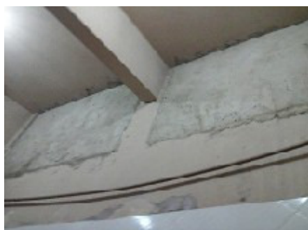
Ausência de acabamento – banheiro feminino
