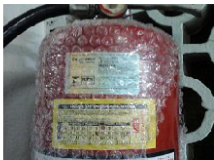
Extintores de incêndio vencidos
