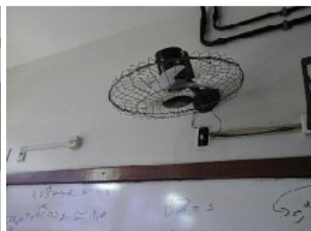
Todos os ventiladores com defeito – sala 5
