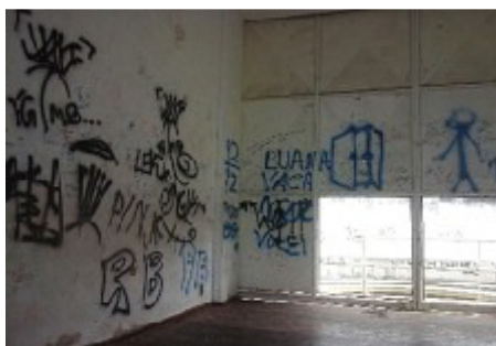
Pichações (situação sinalizada desde 2014)
