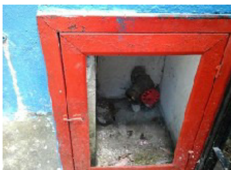
Ausência de mangueira de combate a incêndio no compartimento e porta danificada – acesso à quadra
