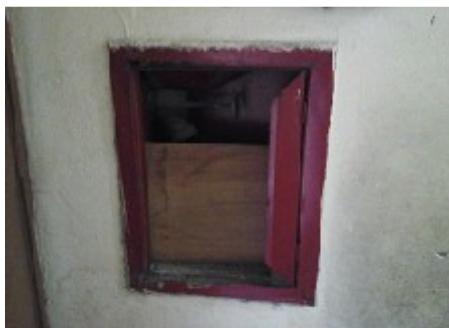
Ausência de mangueira de combate a incêndio (situação sinalizada desde 2013) e compartimento danificado (situação sinalizada desde 2014) – térreo
