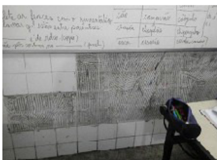
Queda de revestimento – sala 16 (situação sinalizada em 2015)
