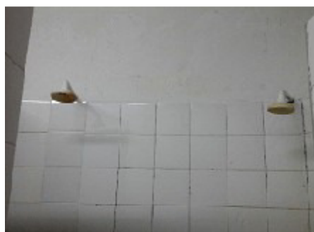
Todos os chuveiros danificados - vestiário masculino (situação sinalizada em 2015)
