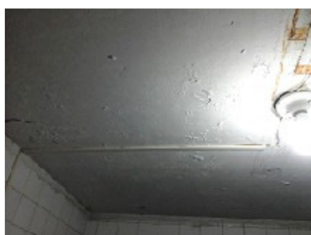
Infiltração (situação sinalizada em 2015)
