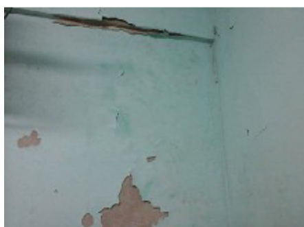
Infiltração e queda de reboco – sala da Educação Infantil (situação sinalizada em 2015)
