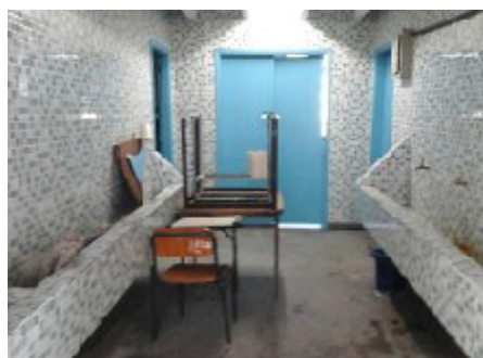
Mobiliário armazenado no corredor da Unidade – térreo (situação sinalizada em 2015)
