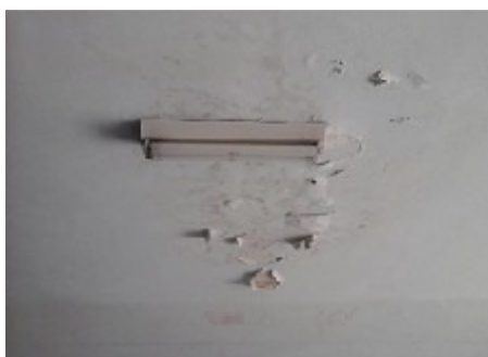
Pintura desgastada decorrente de infiltração sanada, conforme informado pela Direção – corredor 2º andar (situação sinalizada em 2015)
