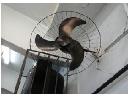
Ausência de grade de proteção no ventilador – sala 7
