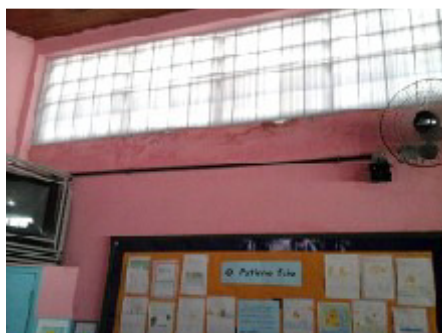
Infiltração – sala 6 (situação sinalizada desde 2014)
