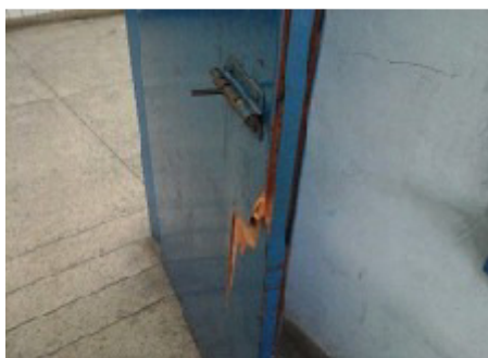
Porta danificada - sala 5 prédio anexo
