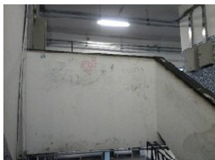
Pichações – acesso ao 1º andar
