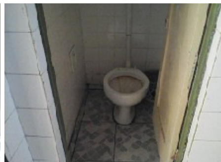
Ausência de assento sanitário (4 boxes) – banheiro feminino
