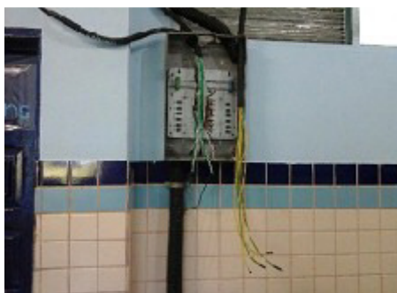
Fiação exposta – corredor 1º andar
