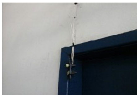
Interruptor danificado e com fiação exposta
