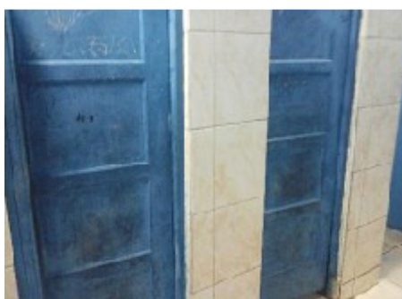
Pintura desgastada – banheiro masculino
