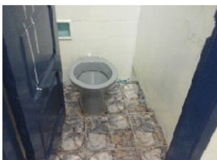
Ausência de assento sanitário (1 boxe) – banheiro masculino térreo
