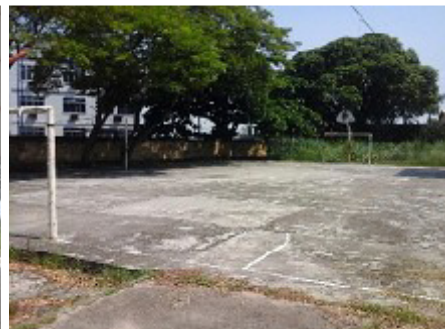
Quadra descoberta com piso precário e equipamentos danificados (tabelas de basquete e balizas) - 2ª quadra. Situação desde 2014.
