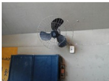
Único ventilador existente com defeito – sala de judô e sala de leitura
