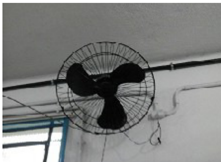
Ventilador com defeito – salas 1, 3, 7 e 11 e sala multiuso (prédio anexo)
