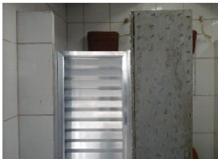
Queda de revestimento – banheiro masculino térreo (situação sinalizada em 2015)
