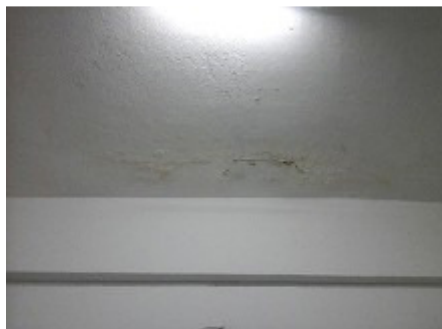
Pintura desgastada decorrente de infiltração sanada, conforme informado pela Direção – corredor 3º andar próximo ao auditório
