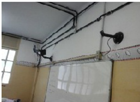
Todos os ventiladores danificados – sala 2
