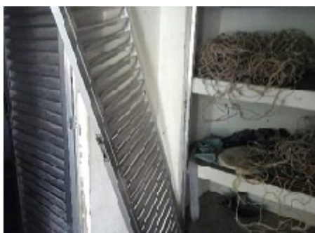
Porta solta – armário para guarda de material de Educação Física
