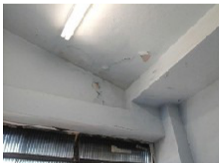
Infiltração – sala 10 (situação sinalizada em 2015)
