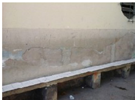
Queda de reboco – área externa (situação sinalizada em 2015)
