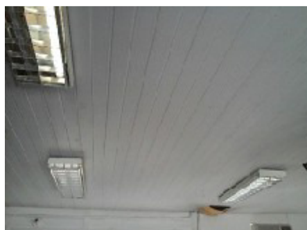
Lâmpadas ausentes/queimadas – diversas salas
