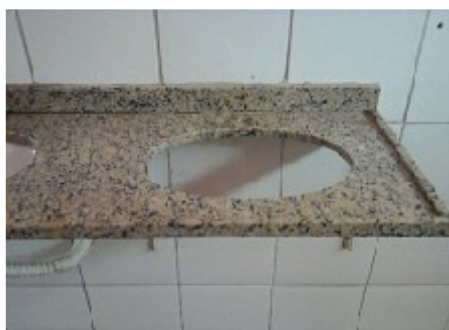
Ausência de cuba na pia – banheiro feminino
