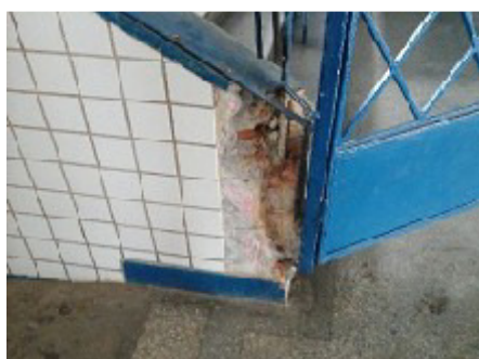
Queda de reboco – portão de acesso ao 1º andar (situação sinalizada em 2015)
