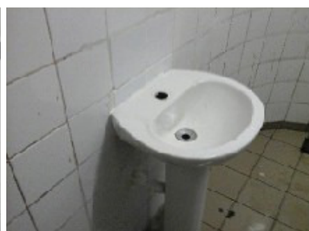
Ausência de torneira – banheiro masculino térreo
