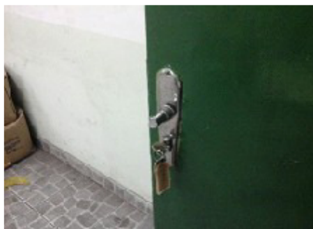
Maçaneta danificada – auditório
