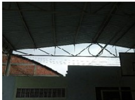
Tela de proteção danificada
