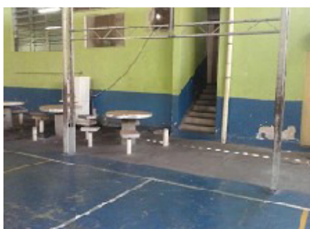
Ausência de alambrado (situação sinalizada desde 2013)
