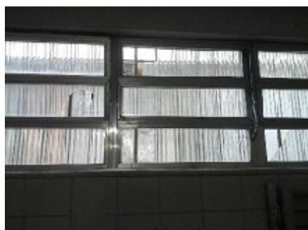
Vidro danificado no basculante – vestiário masculino
