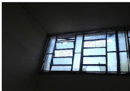
Vidros danificados/ausentes no basculante
