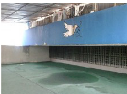
Infiltração - antiga área de recreação da Educação Infantil (situação sinalizada desde 2014)
