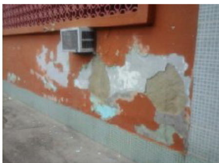
Queda de reboco – área externa
