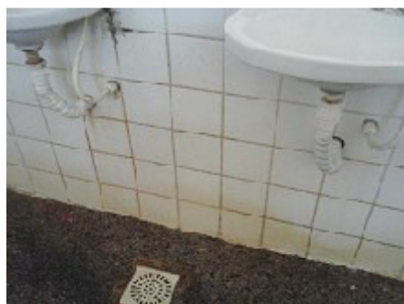
Tubulação danificada na pia - vestiário feminino
