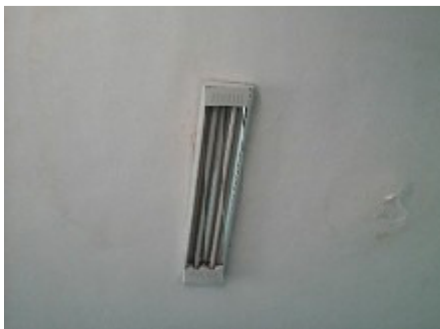
Pintura desgastada decorrente de infiltração sanada, conforme informado pela Direção – corredor 1º andar prédio principal próximo ao laboratório de informática
