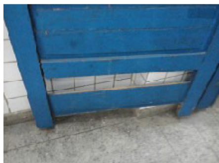
Porta danificada – sala 11
