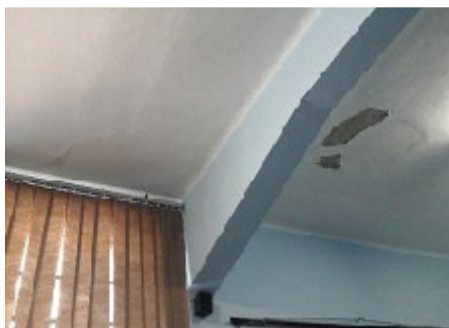
Pintura desgastada decorrente de infiltração sanada, conforme informado pela Direção – sala de vídeo
