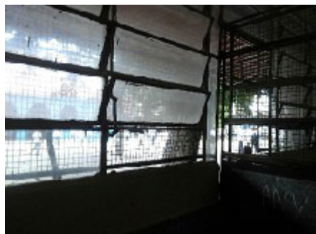
Vidros danificados/ausentes nos basculantes – anexos 1, 2, 3, 4 e 5
