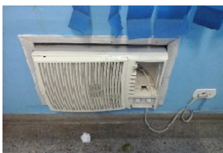
Paletas do único aparelho de ar-condicionado existente danificadas – sala da turma 1603 (antiga sala de vídeo)
