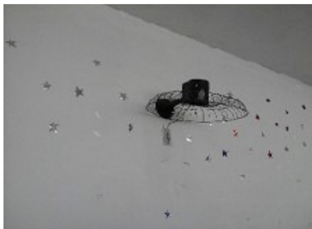
Ventilador danificado – salas 4 e 7
