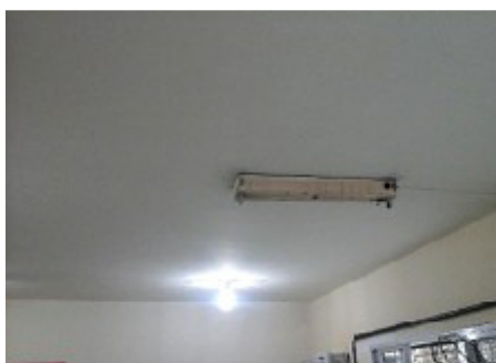
Lâmpadas ausentes/queimadas – diversas salas
