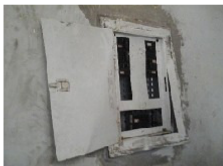
Disjuntor danificado - entrada do vestiário masculino
