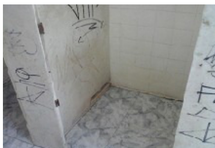
Ausência de porta em todos os boxes - vestiário masculino. Situação sinalizada em 2015.
