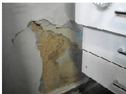
Queda de reboco – secretaria (situação sinalizada em 2015)
