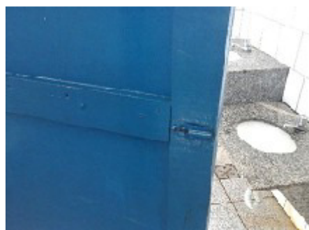
Ausência de maçaneta do tipo alavanca (boxe para portador de necessidades especiais) - banheiros feminino e masculino térreo
