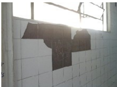
Queda de revestimento – vestiário masculino (situação sinalizada em 2015)
