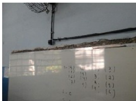
Ausência de acabamento – sala 9
