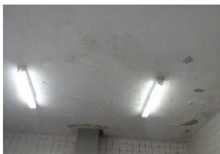
Infiltração (situação sinalizada em 2015)
