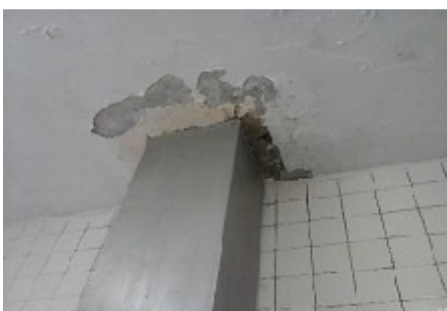
Queda de reboco e infiltração (situação sinalizada em 2015)
