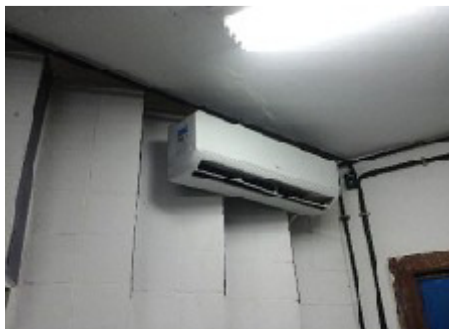
Aparelho de ar-condicionado com defeito – salas 2, 6, 7 e 9
