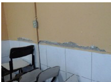
Queda de reboco – auditório 2 (antiga sala de vídeo)
