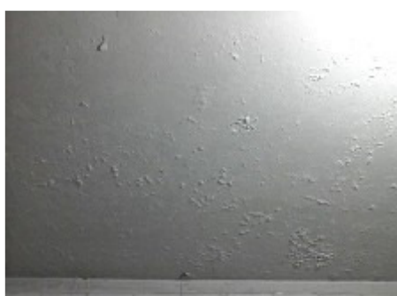
Infiltração (situação sinalizada desde 2014)
