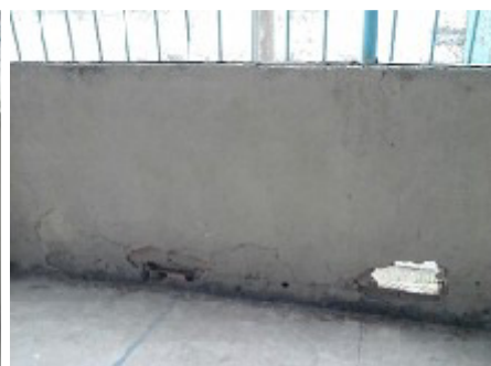
Queda de reboco e alvenaria danificada
