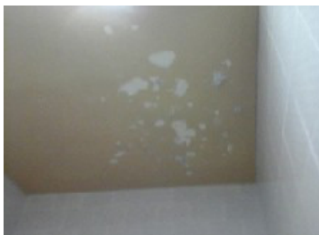
Pintura desgastada – banheiro feminino
