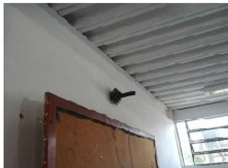
Ausência de 1 ventilador – sala 3, 5, 7 e 11
