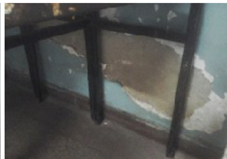
Queda de reboco - sala 17 (situação sinalizada em 2015)
