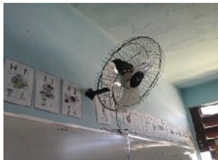
Ventilador danificado – salas 4 e 6 prédio anexo e sala 6 prédio principal
