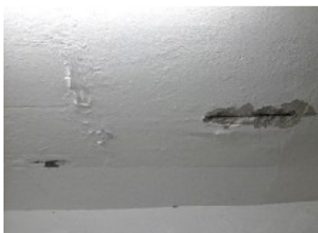
Queda de reboco com ferragem exposta – vestiário masculino (situação sinalizada desde 2014)
