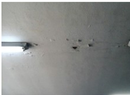
Pintura desgastada decorrente de infiltração sanada, conforme informado pela Direção - sala 13
