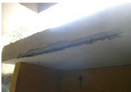
Queda de reboco com ferragem exposta
