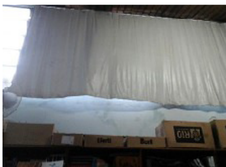
Infiltração – sala de leitura (situação sinalizada em 2015)
