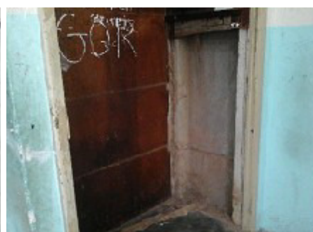
Armário danificado - sala 2
