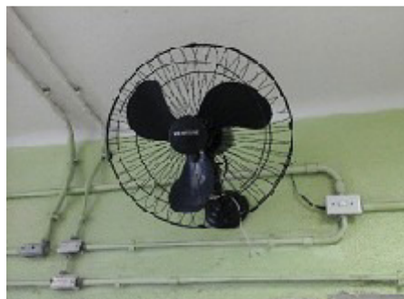
Ventilador com defeito e com fiação exposta – sala 10
