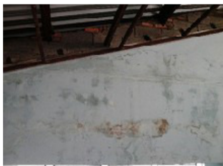
Pintura desgastada decorrente de infiltração sanada, conforme informado pela Direção – acesso ao 1º andar
