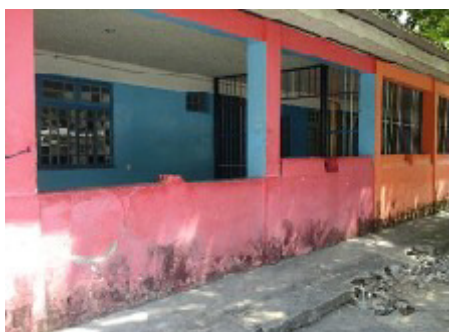
Pintura desgastada – área externa prédio anexo
