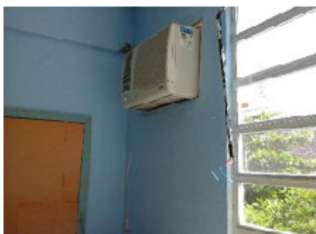
Fiação da distribuição elétrica interna para uso dos aparelhos de ar-condicionado exposta – sala 11
