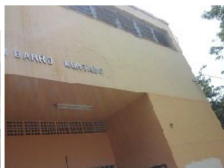
Pintura desgastada – área externa
