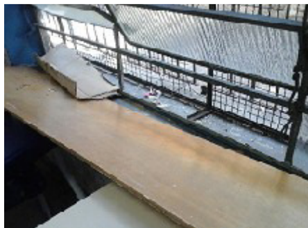
Ausência de vidro no basculante – diversas salas
