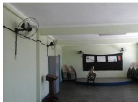
Lâmpadas e ventiladores desligados devido a problemas na parte elétrica, conforme informado pela Direção – auditório
