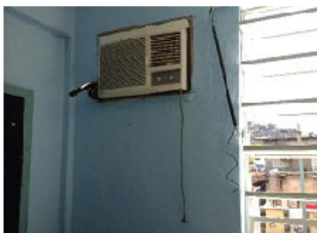
Fiação da distribuição elétrica interna para uso dos aparelhos de ar-condicionado exposta – sala 5
