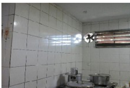
Ausência de coifa (situação sinalizada desde 2014)
