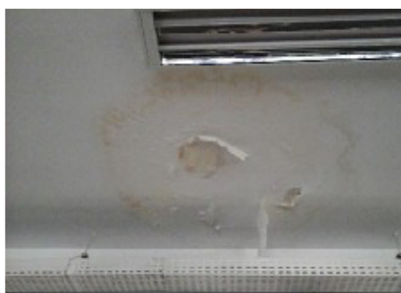
Pintura desgastada decorrente de infiltração sanada, conforme informado pela Direção – corredor 2º andar
