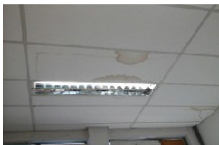
Forro danificado devido à infiltração sanada, conforme informado pela Direção.
