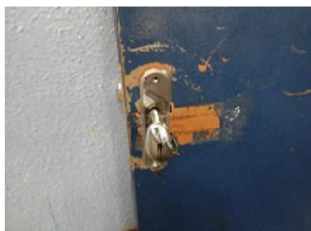
Maçaneta danificada – salas 8, 12, 15 e 18
