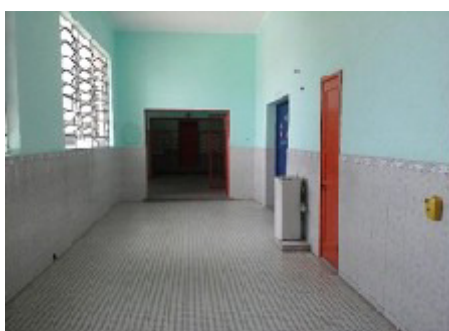
Ausência de extintor de incêndio nos corredores – corredor 1º andar prédio principal (situação sinalizada desde 2014)
