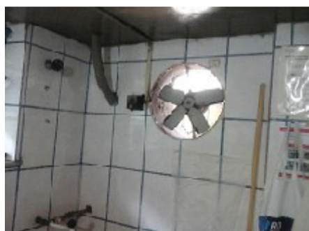
Exaustor danificado (situação sinalizada em 2015)
