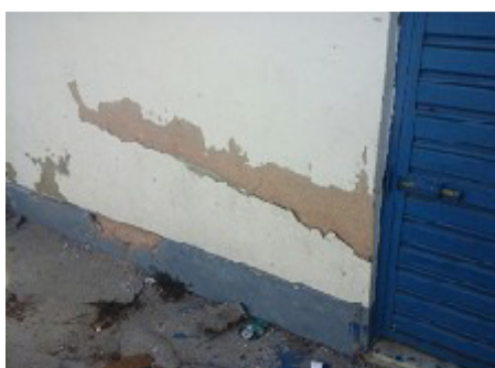
Queda de reboco - entrada dos vestiários
