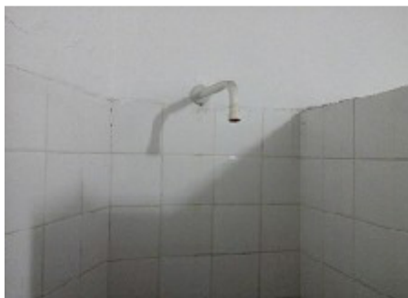
Chuveiro danificado (1 boxe) – vestiário feminino (situação sinalizada em 2015)
