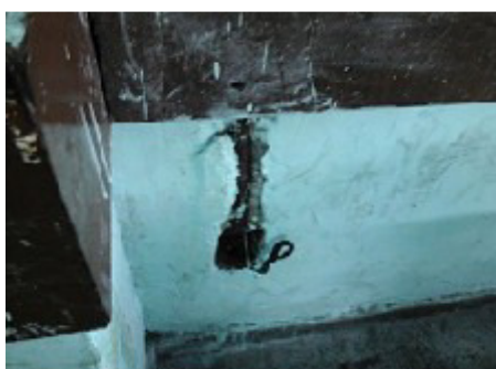
Fiação exposta – sala 4 (situação sinalizada desde 2013)
