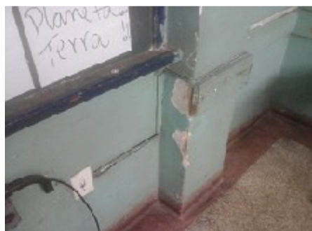
Queda de reboco - sala 15
