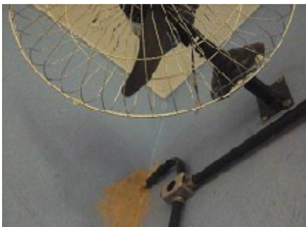
Fiação exposta no ventilador – sala 4
