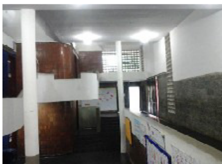
Guarda-corpo com altura inadequada, situação que pode ocasionar acidente (situação sinalizada em 2015)
