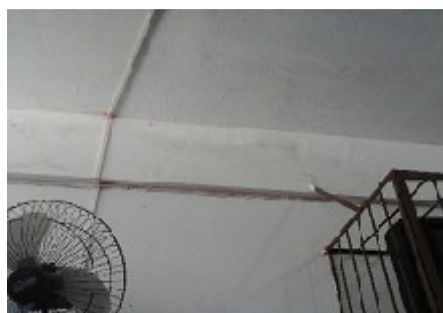
Infiltração decorrente de problemas no telhado, conforme informado pela Direção – sala de leitura (situação sinalizada desde 2013)
