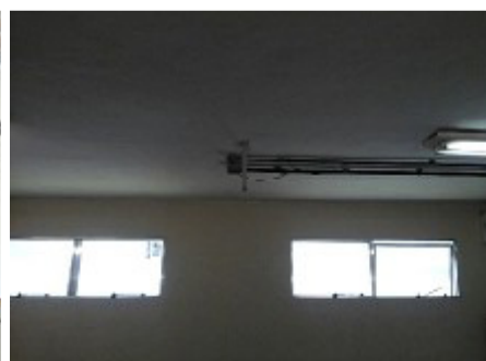
Ausência de projetor para atendimento em 5 salas de aula (há 14 projetores móveis e 19 salas de aula)
