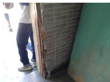
Portal danificado – diversas salas
