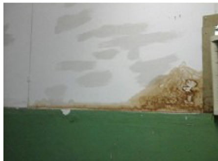
Infiltração na janela – sala 5
