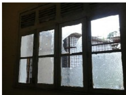
Vidros danificados/ausentes na janela – sala 7
