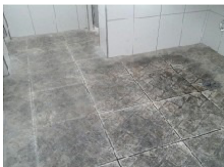
Necessidade de limpeza no piso – banheiro feminino prédio principal
