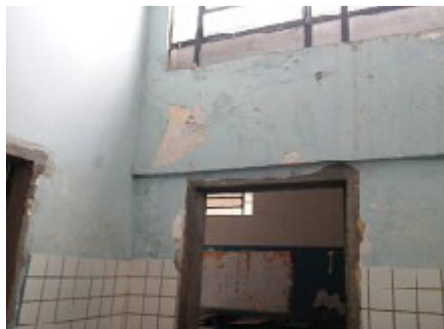
Infiltração – corredor 1º andar próximo à sala 14 (situação sinalizada em 2015)
