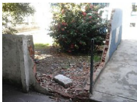
Muro danificado - próximo à casa do residente
