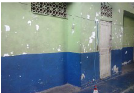
Pintura desgastada (situação sinalizada em 2015)
