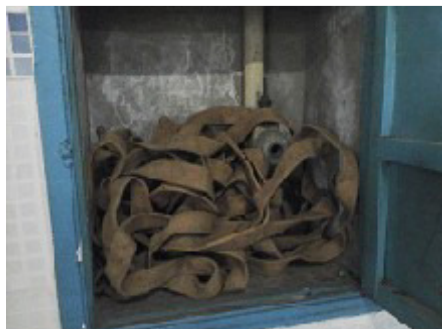
Mangueira de combate a incêndio e registro danificados – 2º andar
