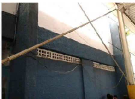
Fiação exposta – área externa próximo à quadra
