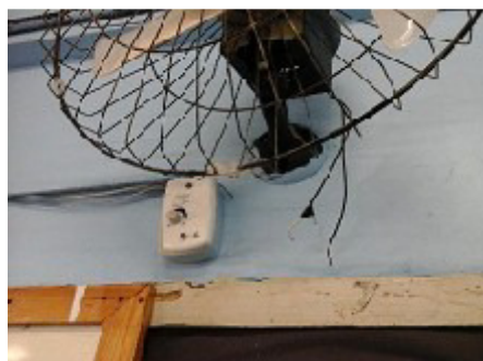
Ventilador com defeito e com fiação exposta – sala 3
