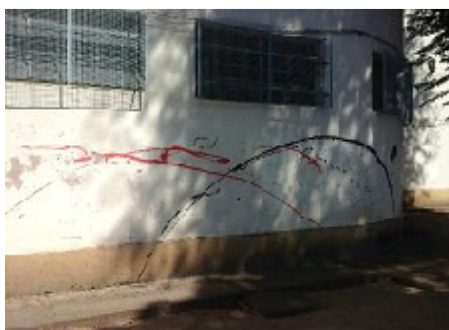
Pintura danificada por invasores, conforme informado pela Direção - área externa (situação sinalizada em 2015)
