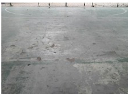
Piso danificado (situação sinalizada desde 2014)
