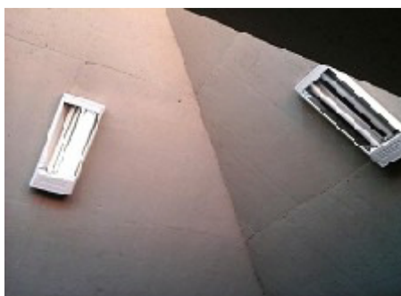
Lâmpadas queimadas – corredor
