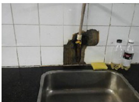
Queda de revestimento
