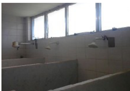
Fiação exposta - vestiário feminino
