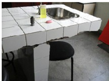
Revestimento danificado – laboratório de ciências
