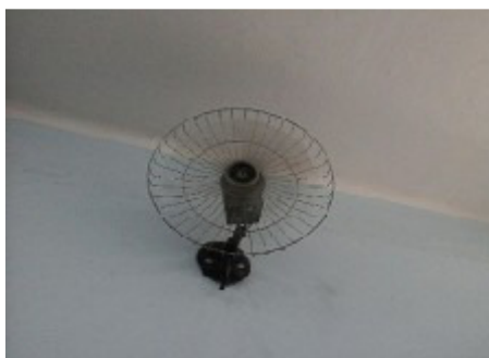
Ausência de grade de proteção no ventilador – salas 10 e 11
