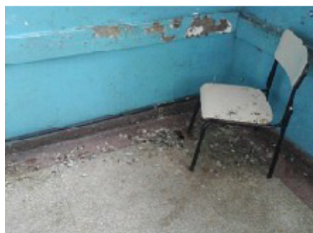
Presença de dejetos de pombos - sala 2 (desativada)
