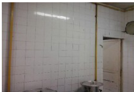
Ausência de coifa (situação sinalizada desde 2014)
