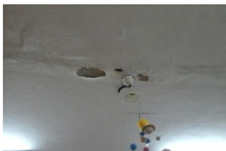
Pintura desgastada decorrente de infiltração sanada, conforme informado pela Direção – sala de leitura
