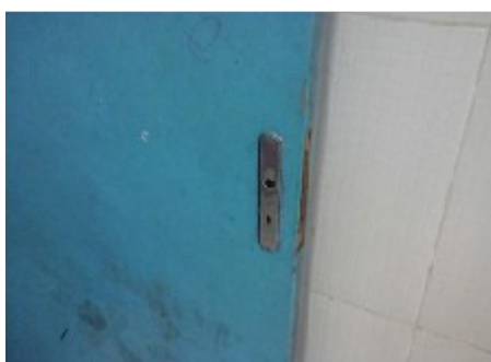
Maçaneta danificada - banheiro feminino 1º andar
