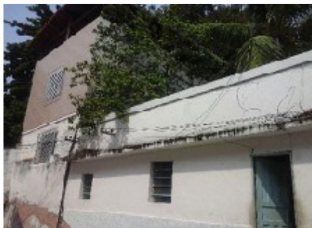
Fiação exposta - área externa
