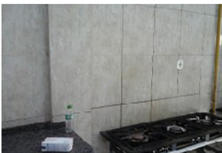
Ausência de coifa (situação sinalizada desde 2014)
