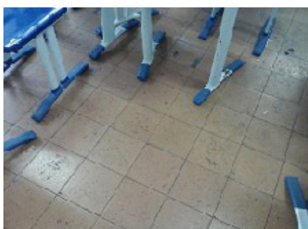
Piso danificado - salas 11 e 12
