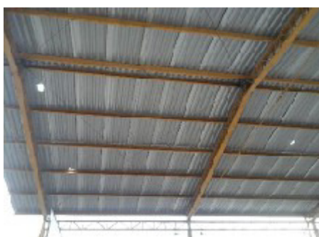
Telhado apresentando furos
