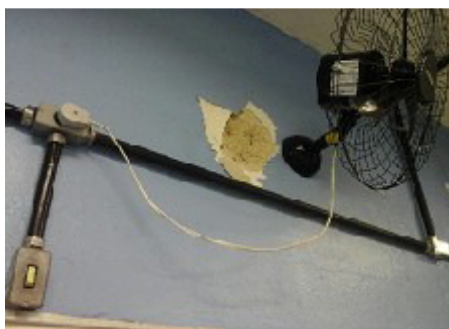
Queda de reboco – sala 1
