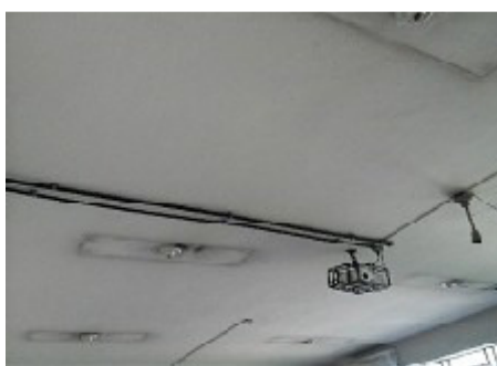
Ausência de todas as lâmpadas – salas 5 e 6
