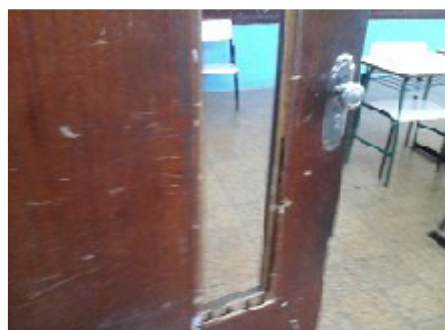
Ausência de vedação na porta (ambiente climatizado) - diversas salas
