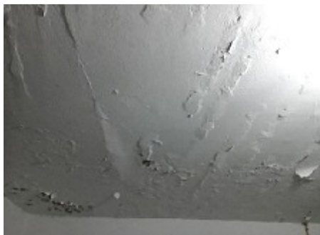
Infiltração decorrente de problemas no telhado, conforme informado pela Direção - vestiário feminino. Situação sinalizada desde 2014.
