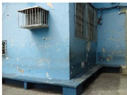
Pintura desgastada – área externa (situação sinalizada em 2015)
