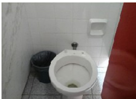
Ausência de assento sanitário em todos os boxes – banheiros femininos térreo, 1º e 2º andares
