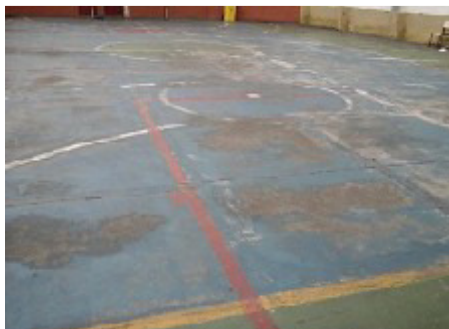
Piso danificado (situação sinalizada em 2015)
