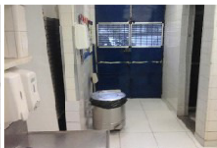
Instalações sanitárias em comunicação direta com a área de preparação de alimentos (situação sinalizada em 2014)
