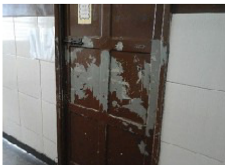
Porta com pintura desgastada – diversas salas
