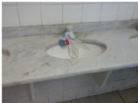
Torneira danificada – vestiário feminino
