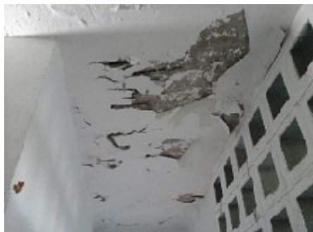
Queda de reboco com ferragem exposta – vestiário feminino (situação sinalizada desde 2014)
