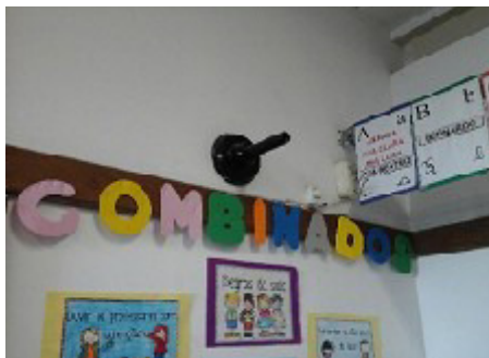
Ausência de 1 ventilador – salas 3 e 4
