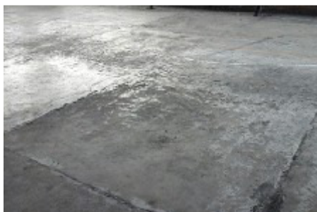
Piso danificado e com marcação desgastada (situação sinalizada em 2014)
