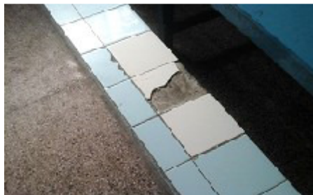
Revestimento danificado - refeitório 2
