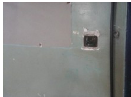
Fiação exposta - sala 16 (situação sinalizada em 2015)
