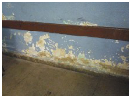
Queda de reboco - sala 4 (situação sinalizada desde 2014)
