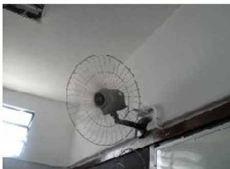
Ausência de grade de proteção no ventilador – sala 14
