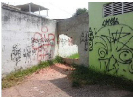
Muro danificado - próximo à quadra (situação sinalizada em 2015)
