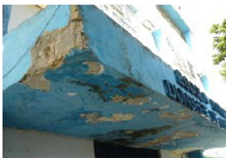
Infiltração e queda de reboco – marquise na entrada da Unidade
