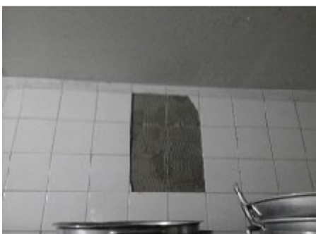
Queda de revestimento (situação sinalizada desde 2014)
