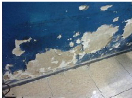
Queda de reboco
