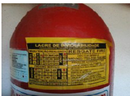
Extintores de incêndio vencidos
