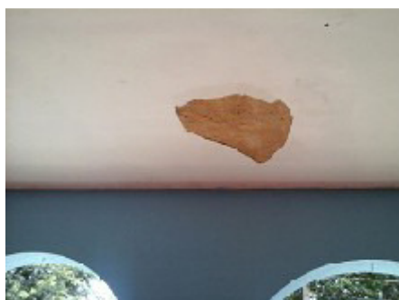
Queda de reboco – pátio (situação sinalizada desde 2013)
