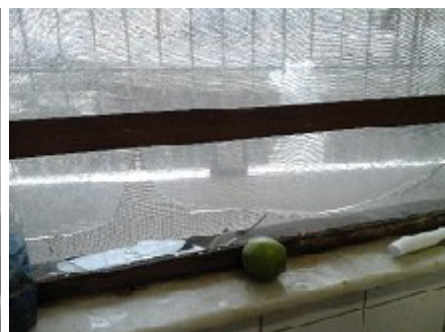
Vidro danificado no basculante
