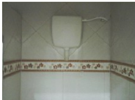
Descarga com defeito (1 boxe) - banheiro feminino
