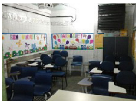
Ambiente com espaço reduzido utilizado como sala de aula – sala 17 (antigo banheiro do 1º andar). Situação sinalizada desde 2013.
