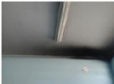
Pintura danificada – sala 15
