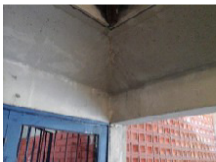
Pintura desgastada decorrente de infiltração sanada, conforme informado pela Direção – corredor próximo ao auditório
