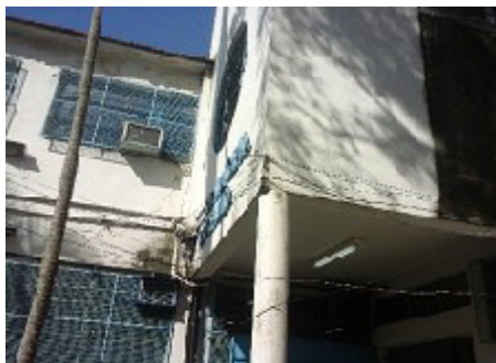
Fiação exposta - área externa (situação sinalizada em 2015)
