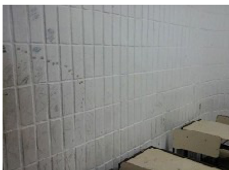
Pintura desgastada – salas 1 e 2
