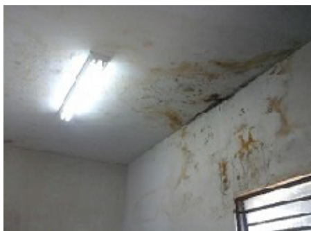
Infiltração (situação sinalizada em 2015)
