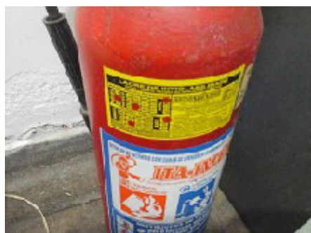
Extintores de incêndio vencidos
