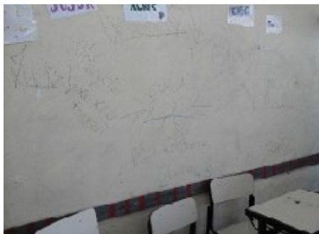
Pintura desgastada (situação sinalizada em 2012 e 2015) e pichações – diversas salas
