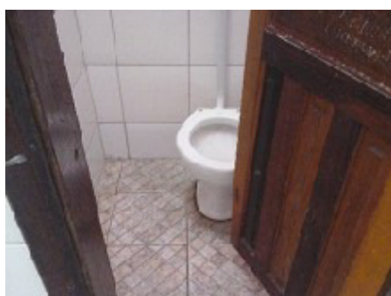
Ausência de assento sanitário (2 boxes) – banheiro feminino
