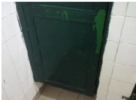
Boxe interditado - banheiro masculino subsolo
