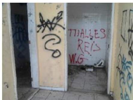
Vestiários desativados (situação sinalizada desde 2012) e totalmente depredados (situação sinalizado em 2015)
