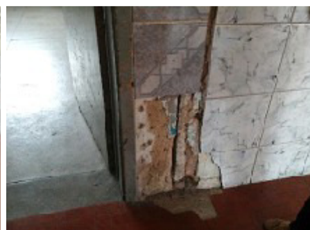
Queda de revestimento – entrada da sala 6 (antiga sala 10). Situação sinalizada em 2015.
