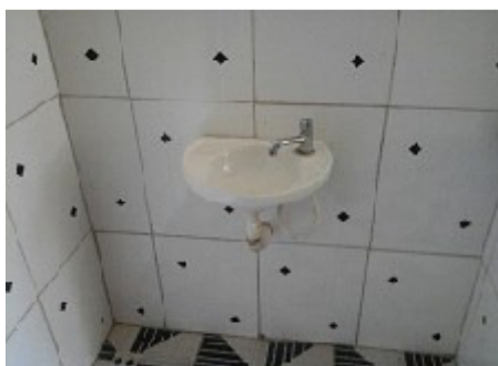
Ausência de barras de apoio junto ao lavatório (boxe para portador de necessidades especiais) – banheiro feminino
