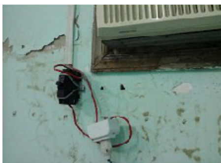
Fiação exposta no aparelho de ar-condicionado – sala 20
