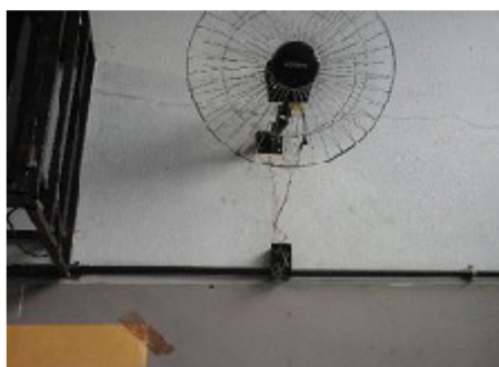
Fiação exposta no ventilador – sala 8
