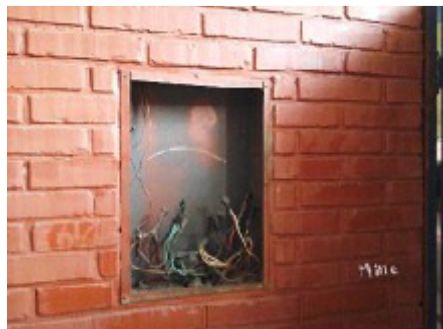
Fiação exposta – sala 5
