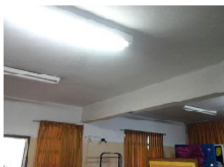
Lâmpadas queimadas – auditório
