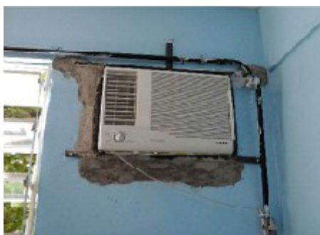
Ausência de acabamento – salas 4 e 10
