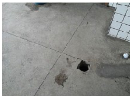
Ausência de tampa no ralo – entrada da sala 8
