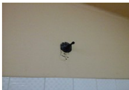
Ausência de ventilador de parede (só tem ventilador de teto)
