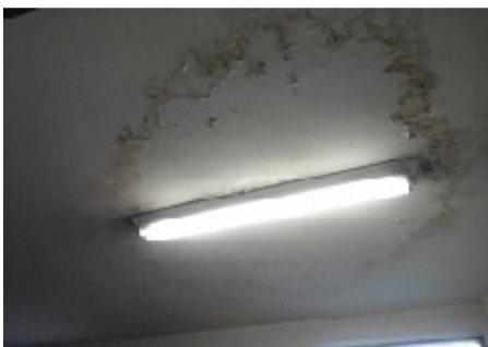
Infiltração decorrente de problemas no telhado, conforme informado pela Direção – almoxarifado
