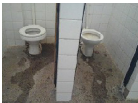
Vazamento no vaso sanitário (2 boxes) – vestiário feminino
