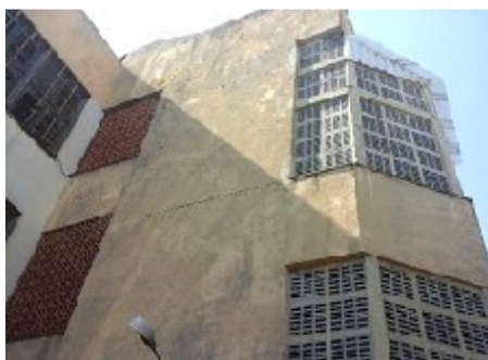
Pintura desgastada – área externa (situação sinalizada em 2012 e 2015)
