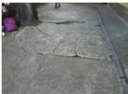
Piso danificado - acesso à quadra (situação sinalizada em 2015)
