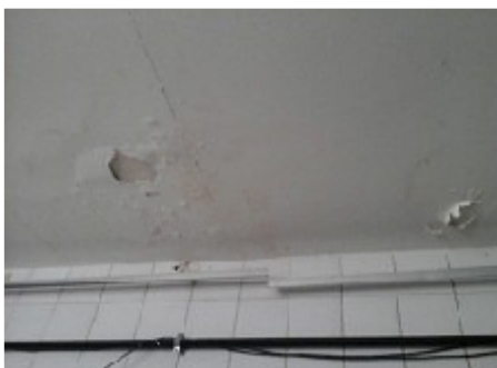
Pintura desgastada decorrente de infiltração sanada, conforme informado pela Direção.
