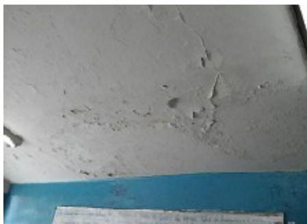
Infiltração – sala 16 (situação sinalizada desde 2014)
