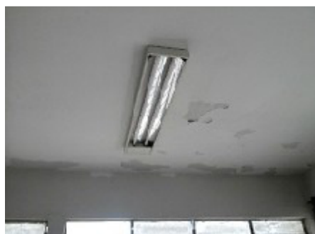
Pintura desgastada – sala 9 (situação sinalizada em 2014)
