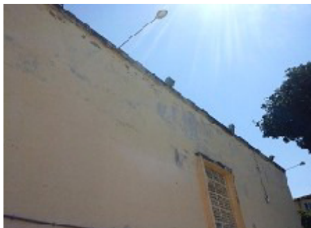
Pintura desgastada - fachada posterior (situação sinalizada desde 2013)
