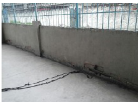
Queda de reboco
