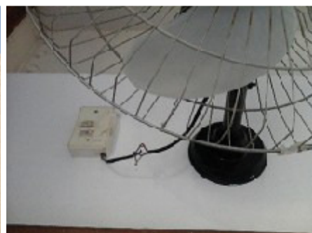
Fiação exposta no ventilador – sala 1
