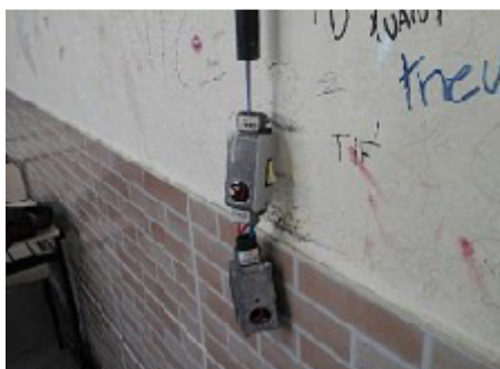
Canaleta danificada e com fiação exposta – sala 18
