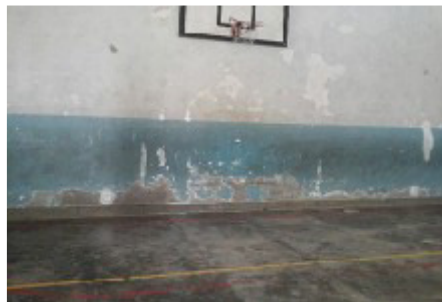
Pintura desgastada (situação sinalizada desde 2014)
