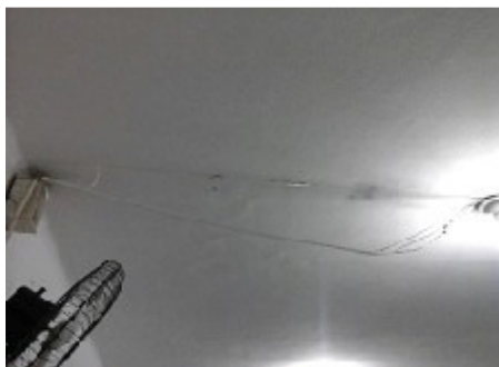
Fiação exposta – sala 4
