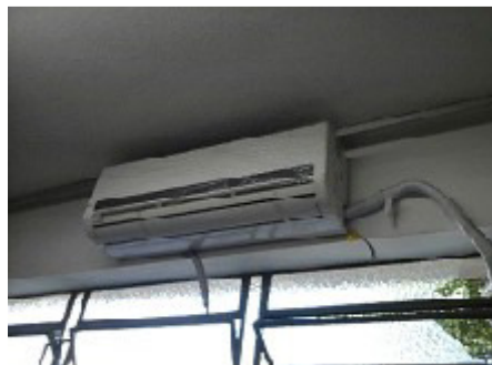
Único aparelho de ar-condicionado existente com instalação danificada - salas 1, 2, 3 e 4 da classe especial
