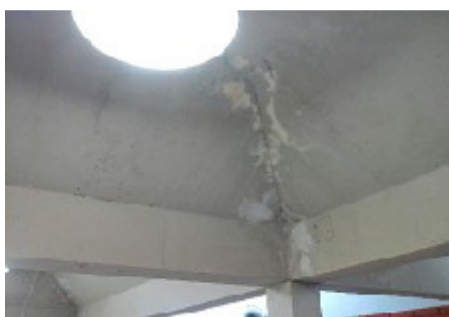
Pintura desgastada decorrente de infiltração sanada, conforme informado pela Direção (situação sinalizada em 2015).
