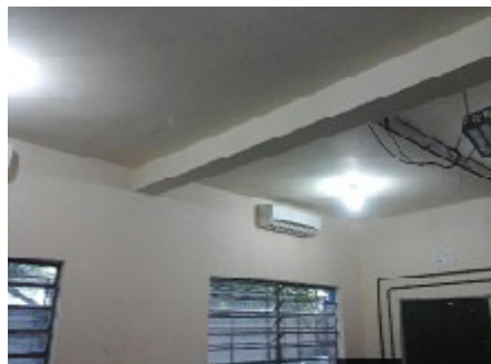
1 Aparelho de ar-condicionado com defeito – sala 2
