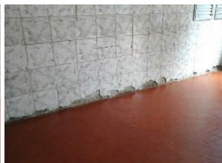
Queda de revestimento – pátio (situação sinalizada desde 2013)
