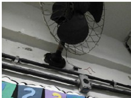
Fiação exposta no ventilador – sala 3
