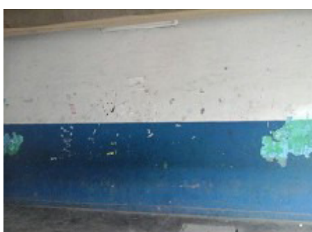
Pintura desgastada – térreo
