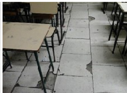
Piso danificado – sala 9
